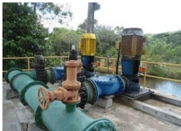
Figura 3.26 - Conjuntos motobomba de eixo vertical responsáveis pela captação.
