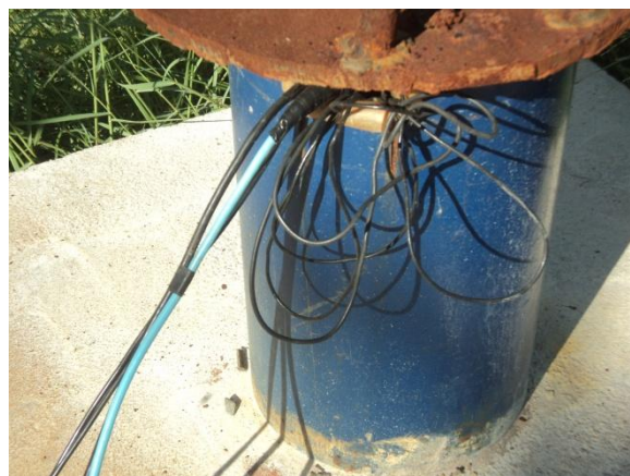
Figura 3.17 - Instalações elétricas expostas conjunto motobomba EEB2
