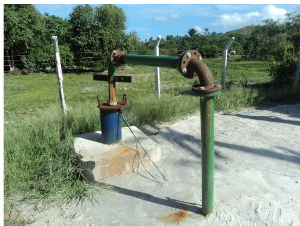
Figura 3.16 – EEB2, Vista do barrilete de recalque
