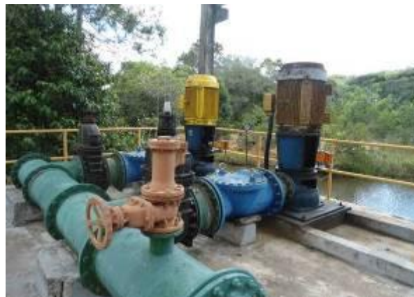
Figura 2.15 - Conjuntos motobomba de eixo vertical responsáveis pela captação.
