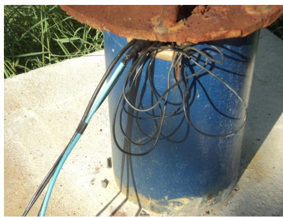
Figura 2.5 - Instalações elétricas expostas conjunto motobomba EEB2
