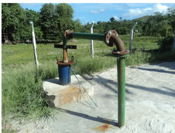
Figura 2.4 – EEB2, Vista do barrilete de recalque – Poço CSB2
