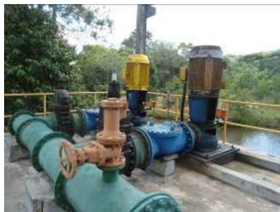
Figura 4.105 - Conjuntos motobomba de eixo vertical responsáveis pela captação
