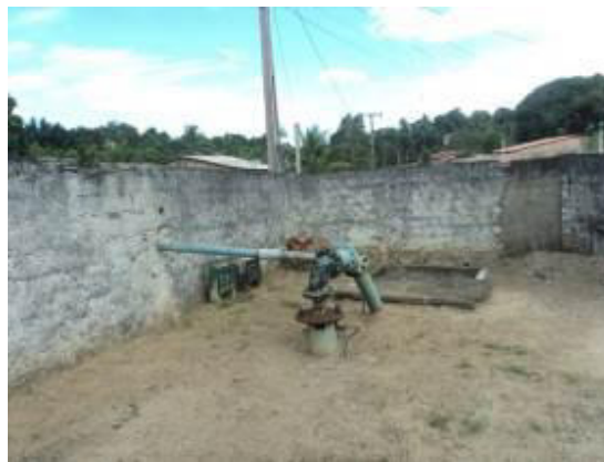
Figura 4.10 - Poço CSB8N – Local da instalação
