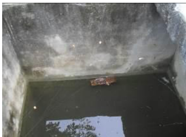
Figura 4.75 - Vazamento na caixa de registro
