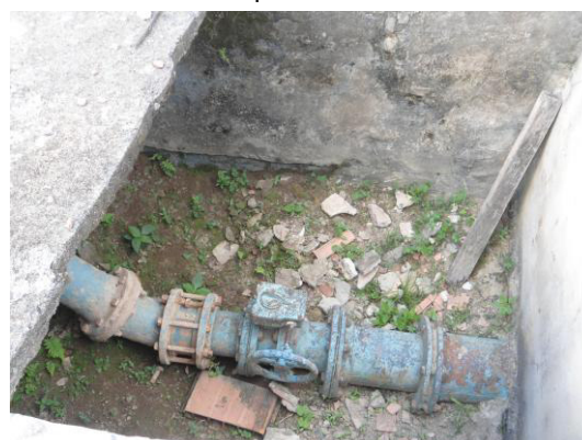
Figura 4.26 - Poço CSB8N – Caixa de registro desprotegida
