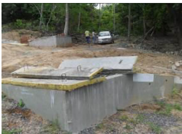
Figura 4.74 - Área da captação desorganizada
