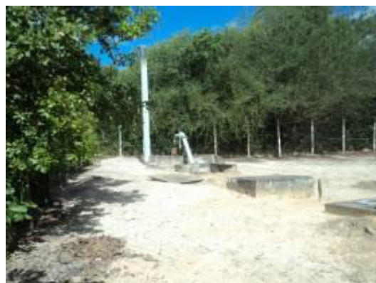
Figura 4.6 - Poço CSB6N – Local da instalação
