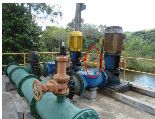
Figura 4.112 - Conjunto motobomba com destaque para o medidor de pressão na tubulação de recalque
