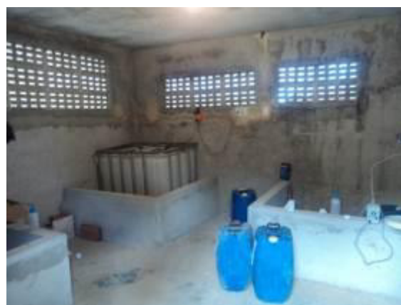
Figura 4.12 - Poço CSB8N – Unidade de tratamento, ambiente interno
