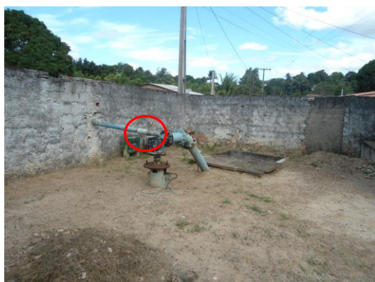
Figura 4.23 - Poço CSB8N – Medidor de pressão (detalhe em vermelho)
