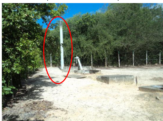
Figura 4.25 - Poço CSB6N – Detalhe da trave para içamento da bomba
