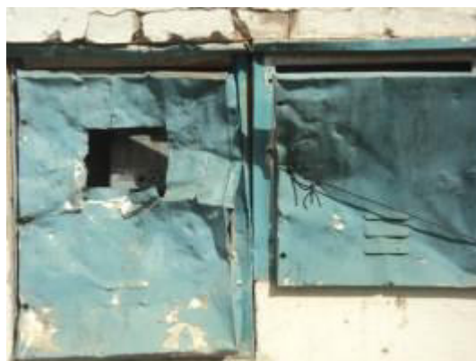
Figura 4.18 - Poço CSB9N – Quadro de energia em precário estado de conservação
