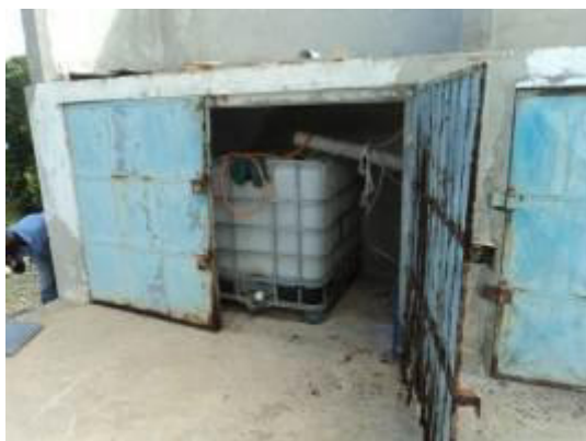
Figura 4.17 - Poço CSB9N – Unidade de tratamento, no próprio local da instalação
