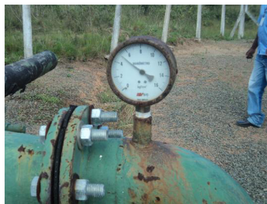
Figura 4.24 - Poço CSB9N – Manômetro em estado precário
