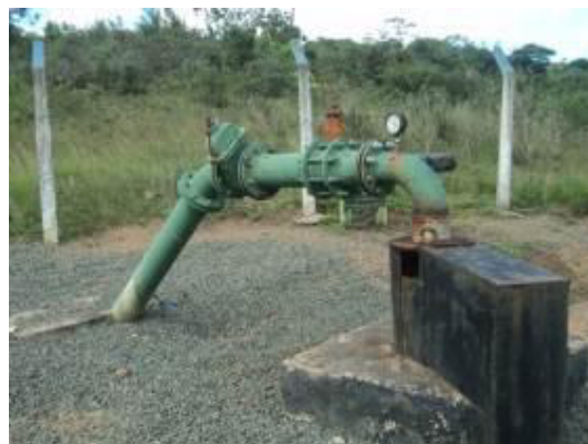
Figura 4.14 - Poço CSB9N – Local da instalação
