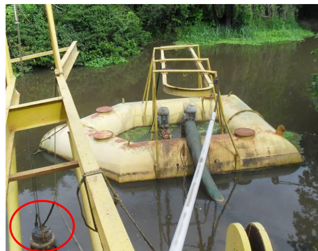
Figura 4.71 - Captação em plataforma flutuante e, detalhe vermelho, captação em bomba submersa
