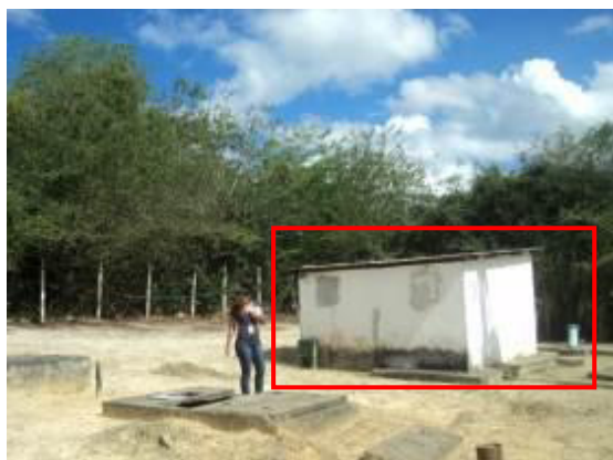
Figura 4.7 - Poço CSB6N – Unidade de tratamento desativada (detalhe em vermelho), no próprio local da instalação
