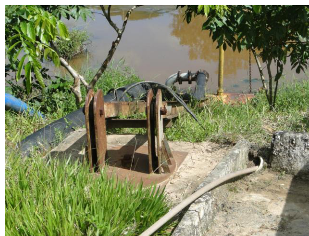
Figura 5.46 –Tubulação de recalque da bomba submersa
