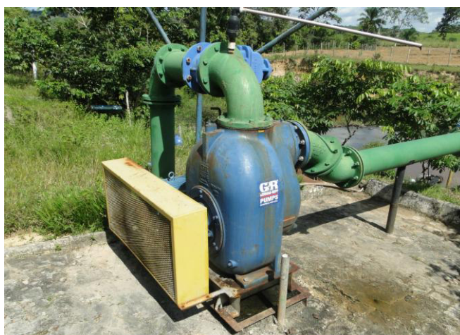
Figura 5.45 –Conjunto motobomba responsável pela captação
