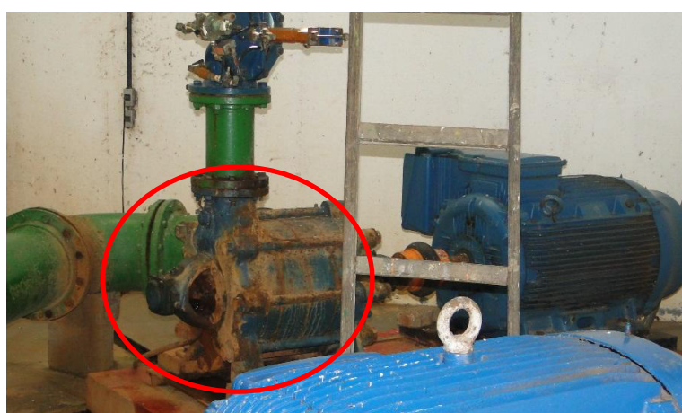
Figura 6.11 - Corrosão do conjunto motobomba da EEAB2
