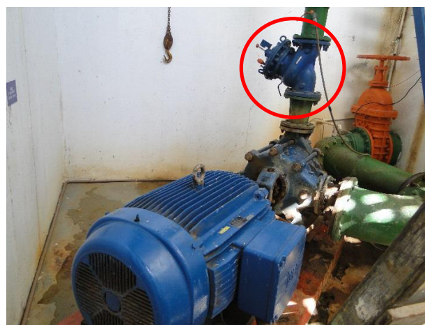
Figura 6.10 - Conjunto motobomba da EEAB2, com destaque para a válvula de controle
