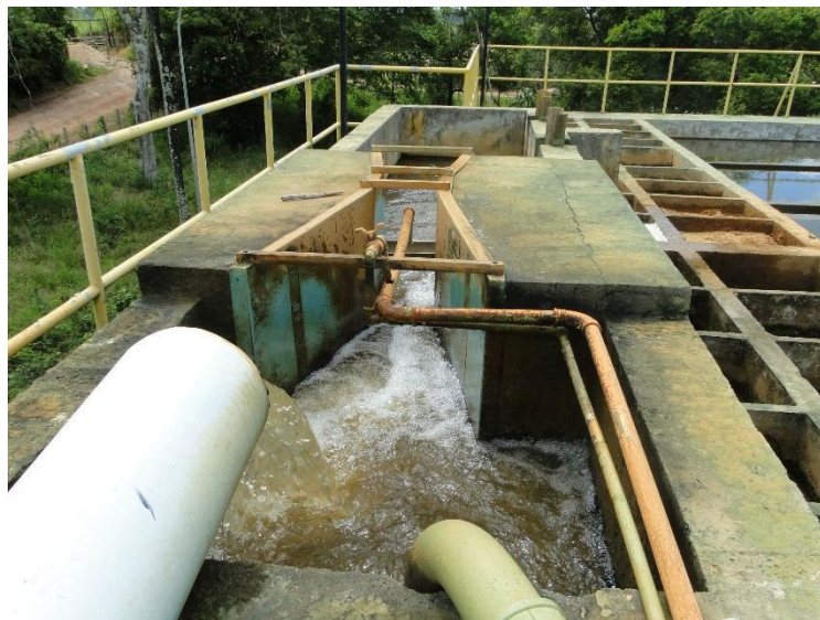
Figura 6.15 - Chegada da água bruta na unidade de mistura rápida (calha Parshall)
