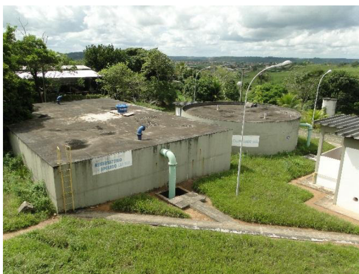
Figura 6.20 - Reservatórios Apoiados de 500 m³ e 900 m³
