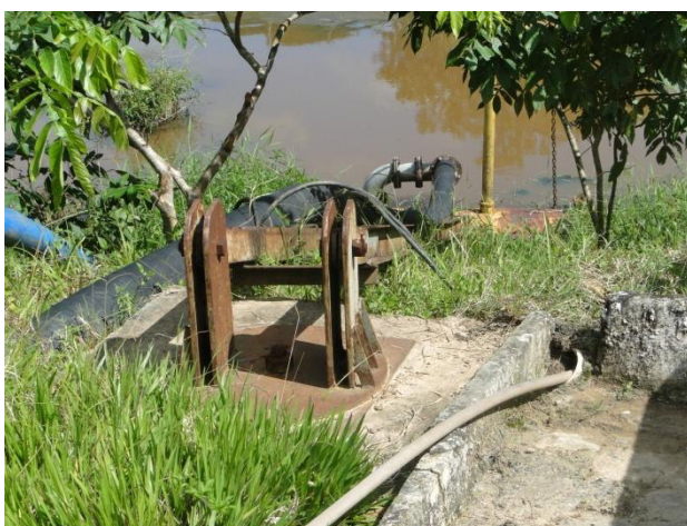
Figura 6.6 - Tubulação de recalque da bomba submersa
