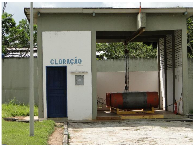
Figura 6.21 - Casa de Cloração
