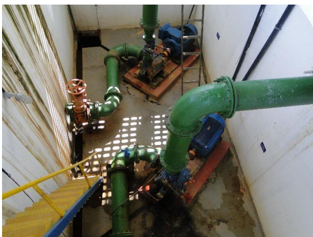
Figura 6.9 - Vista superior da EEAB2
