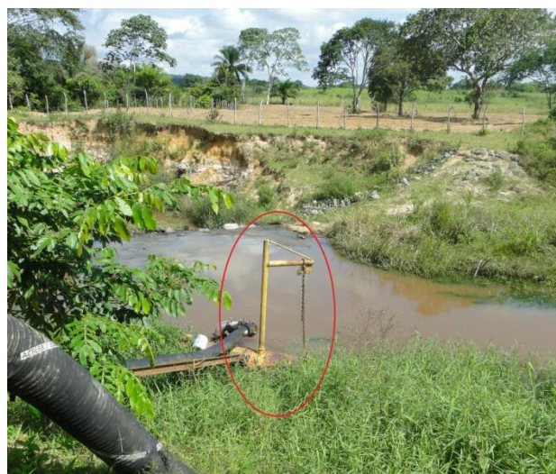
Figura 6.4 - Dispositivo de içamento para a bomba submersa da EEAB1
