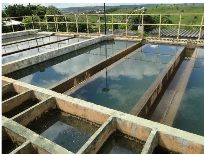
Figura 6.16 - Floculador de chicanas verticais e decantadores
