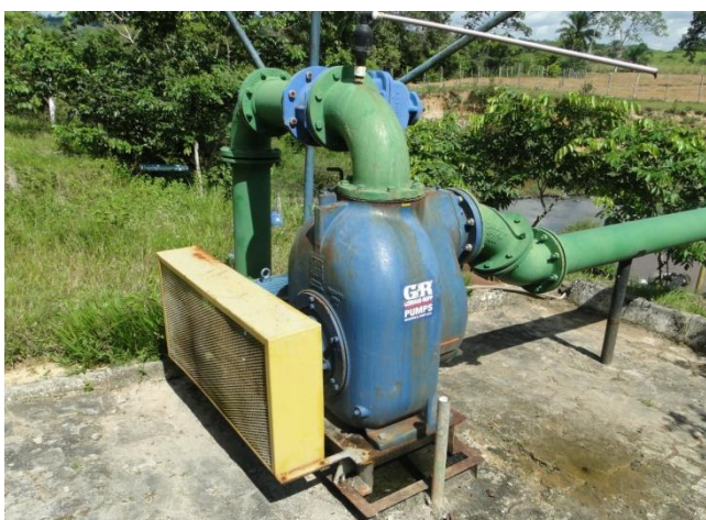
Figura 6.5 - Conjunto motobomba da EEAB1
