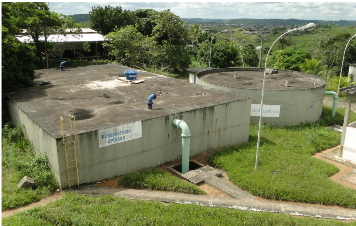
Figura 7.3 - Reservatório Apoiados (RAP's 500 e 900)
