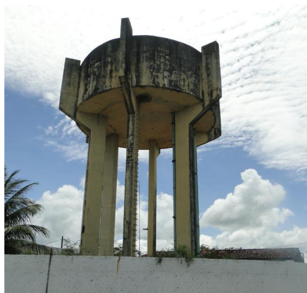
Figura 7.5 - REL 300, utilizado como reservatório de compensação
