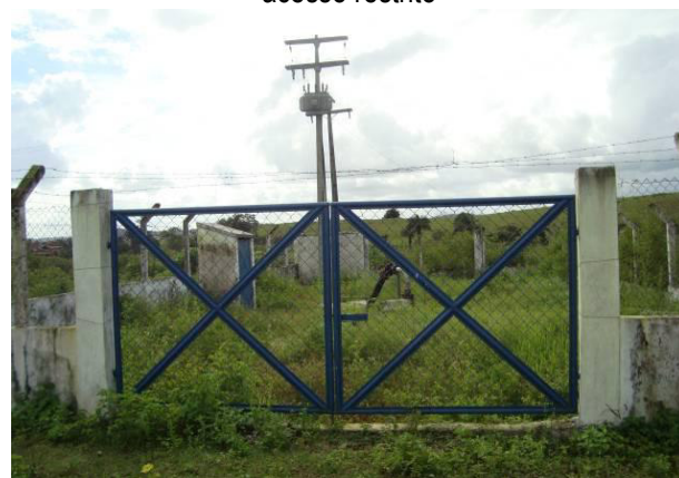
Figura 6.13 - Poço CSB16 – Vista geral da instalação. Proteção com cerca; faltam identificação e sinalização de acesso restrito
