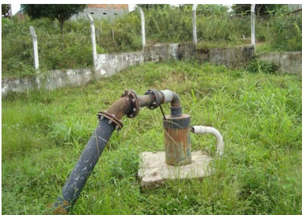
Figura 6.12 - Poço CSB15 – Local da Instalação
