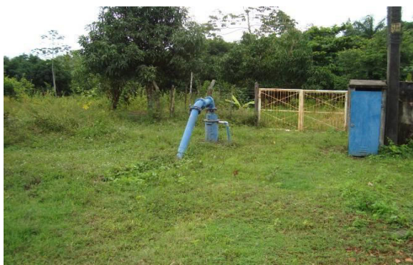
Figura 6.18 - Poço CSB 12 – Vista do barrilete.
