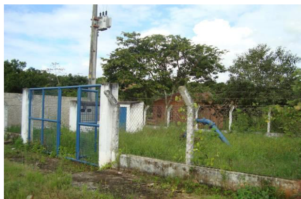
Figura 6.7 - Poço CSB13 – Vista geral da instalação. Proteção com cerca; faltam identificação e sinalização de acesso restrito
