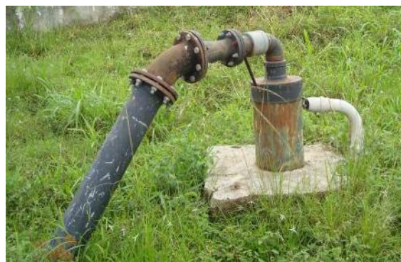
Figura 6.19 - Poço CSB 15 – Vista do barrilete
