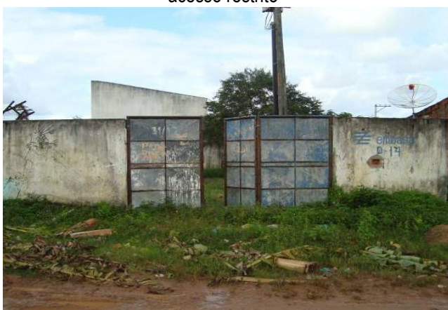
Figura 6.9 - Poço CSB14 – Vista geral da instalação. Proteção com muro; falta sinalização de acesso restrito
