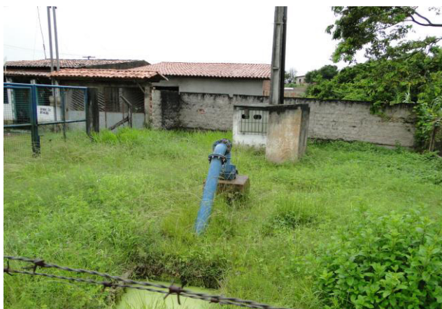
Figura 6.8 - Poço CSB13 – Local da Instalação. Encontra-se desativado
