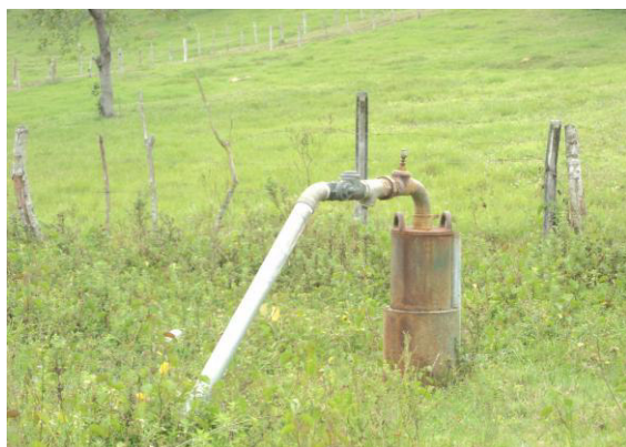
Figura 6.22 - Poço CSB1 – Vista do barrilete.
