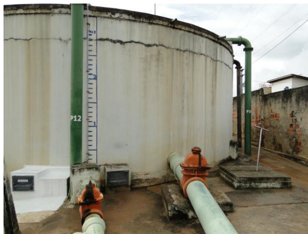
Figura 6.15 - Reservatório apoiado 250m³ (RAP 2)
