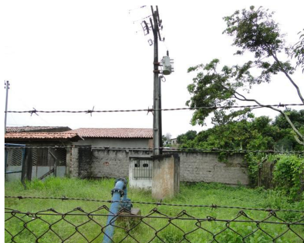
Figura 7.4 - Vista geral das instalações da EEB13
