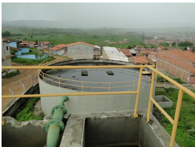
Figura 7.15 - Reservatório apoiado de 500m³, (fora de operação).
