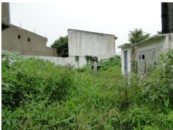
Figura 7.5 - Vista geral das instalações da EEB14.
