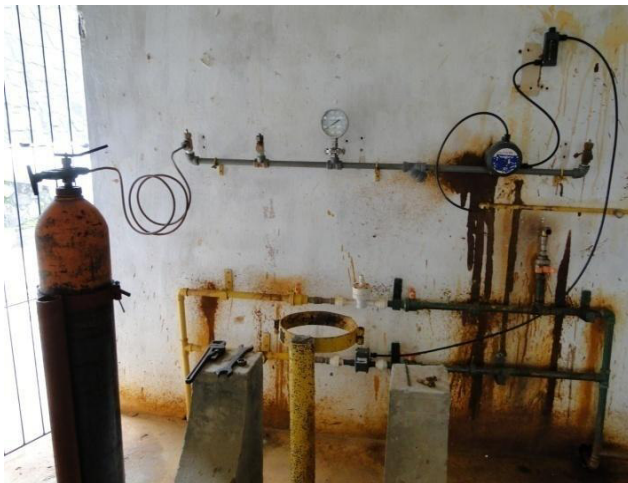
Figura 7.9 - Casa de cloração – Vista do cilindro 50kg e dosadores.
