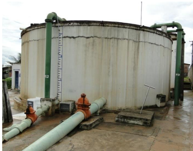
Figura 7.10 – RAP 2 - Caixa de Reunião/Tanque de Contato.
