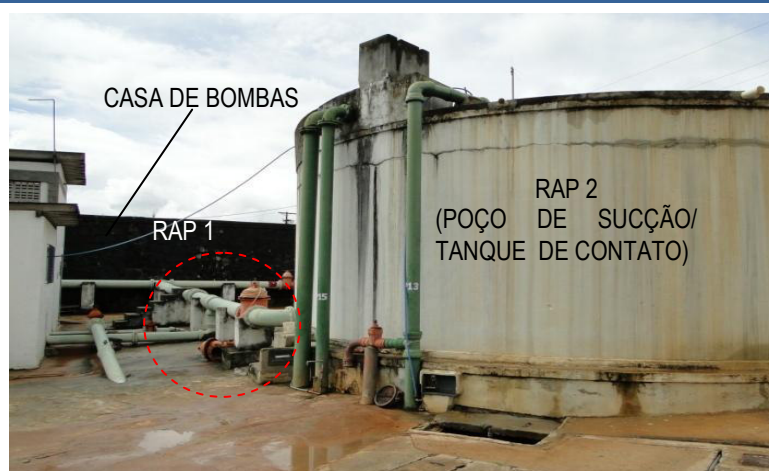
Figura 7.19 - EET1 – Destaque vermelho: Tubulação de sucção
