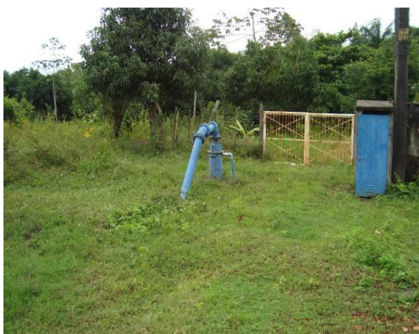
Figura 7.3 - Vista geral das instalações da EEB12.
