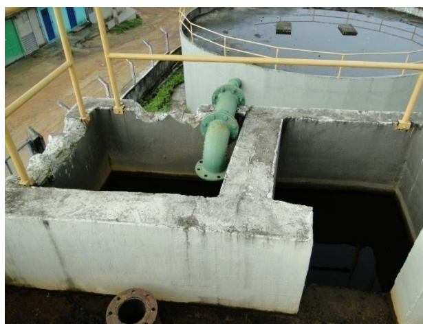
Figura 7.14 - Estrutura de entrada dos Filtros Russos (fora de operação).
