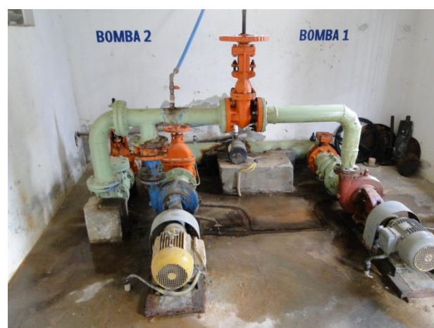
Figura 7.18 – EET1 – Vista dos conjuntos motobomba.
