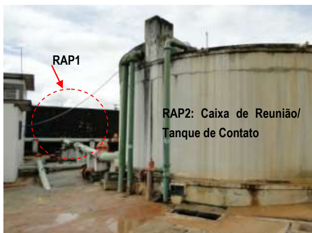
Figura 8.4 - Vista dos Reservatórios localizados na área da ETA.
