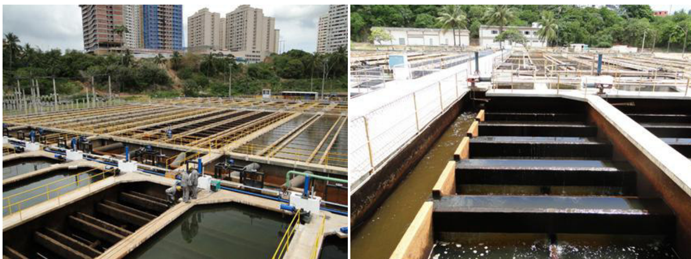
Figura 1. 23 - Vista parcial das ETA's Vieira de Mello (esquerda) e Theodoro Sampaio (direita)
