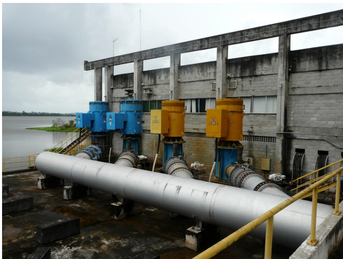
Figura 1. 5 - Vista da captação/elevatória do sistema adutor Joanes II – ETA Principal
