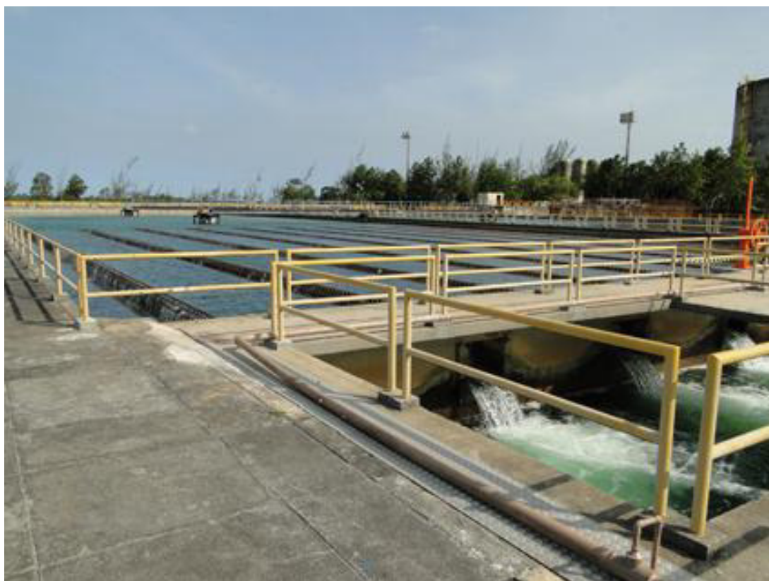
Figura 1. 21 - Vista Parcial da ETA Principal
