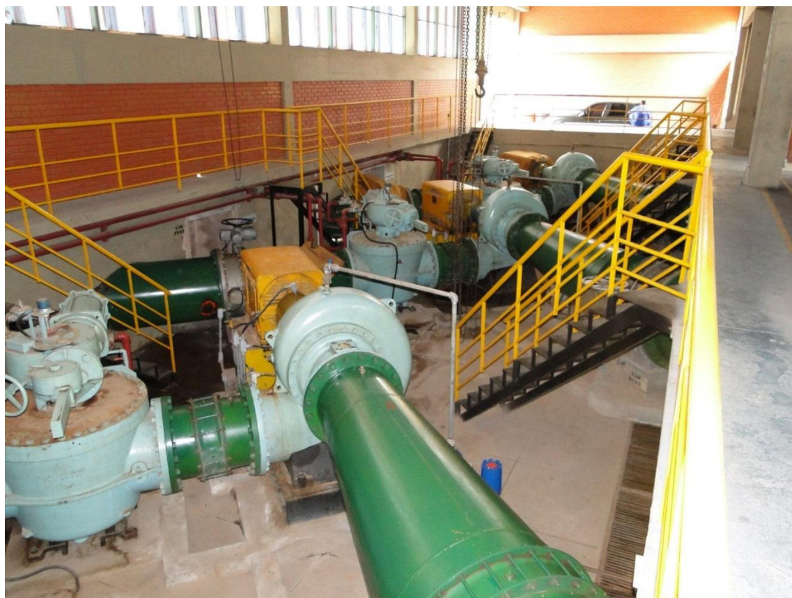
Figura 1. 13 - Booster do Sistema Adutor em Aço, com Captação na Barragem Joanes I
