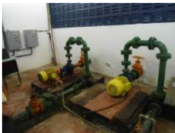
Figura 1. 45 -Conjuntos motobomba (CMB) responsáveis pela captação
