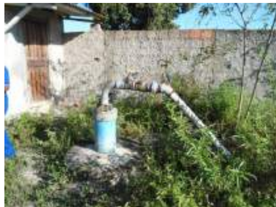
Figura 1. 61 - Poço P02 – Vista do barrilete de recalque
