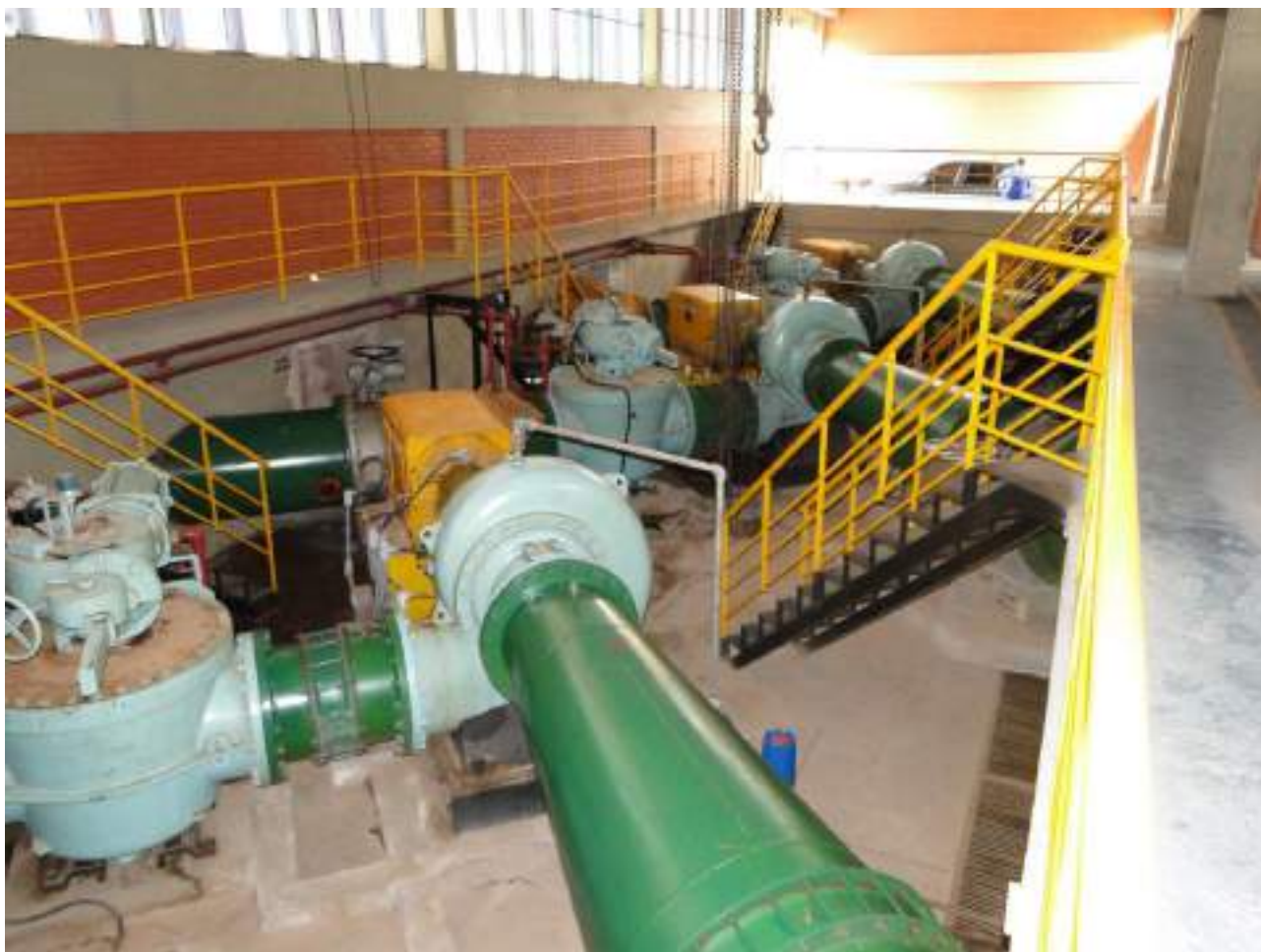
Figura 1. 34 - Booster do Sistema Adutor em Aço, com Captação na Barragem Joanes I
