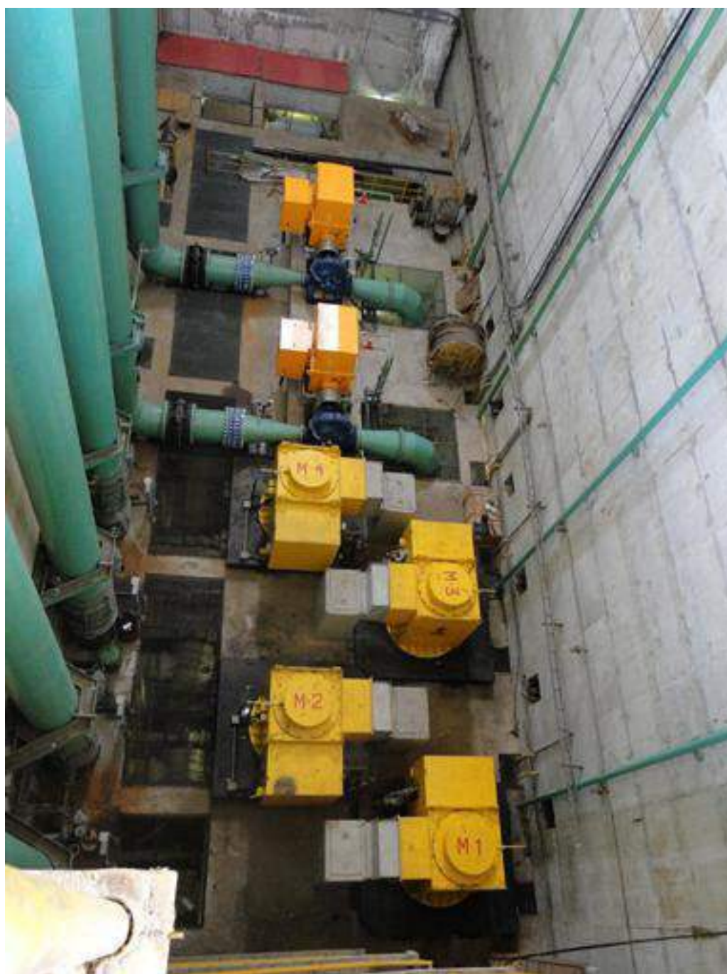
Figura 1. 25 - Vista Superior da Casa de Bombas da Captação do Sistema Adutor Pedra do Cavalo
