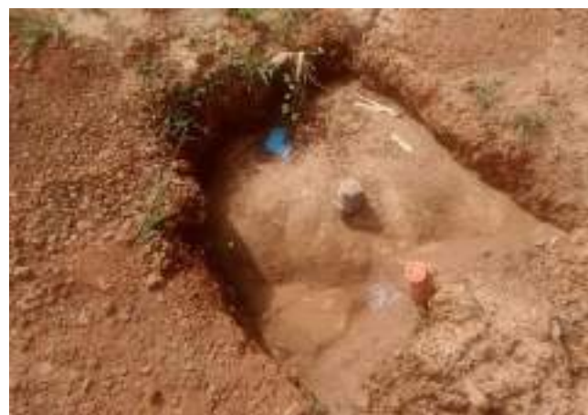
Figura 1. 78 - Registro de controle do Poço 1 (Saubara) sem caixa de proteção e aterrado
