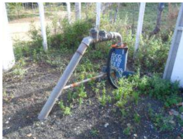
Figura 1.76 - Poço 2 (Bom Jesus dos Pobres) (EMBASA, 2011)
