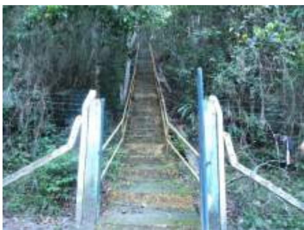
Figura 1. 39 - Escada de acesso a área da captação do SAA de Pedras
