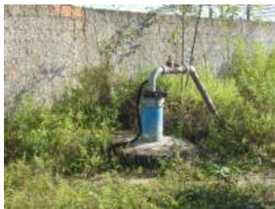
Figura 1. 56 - Poço P02 – Local da instalação
