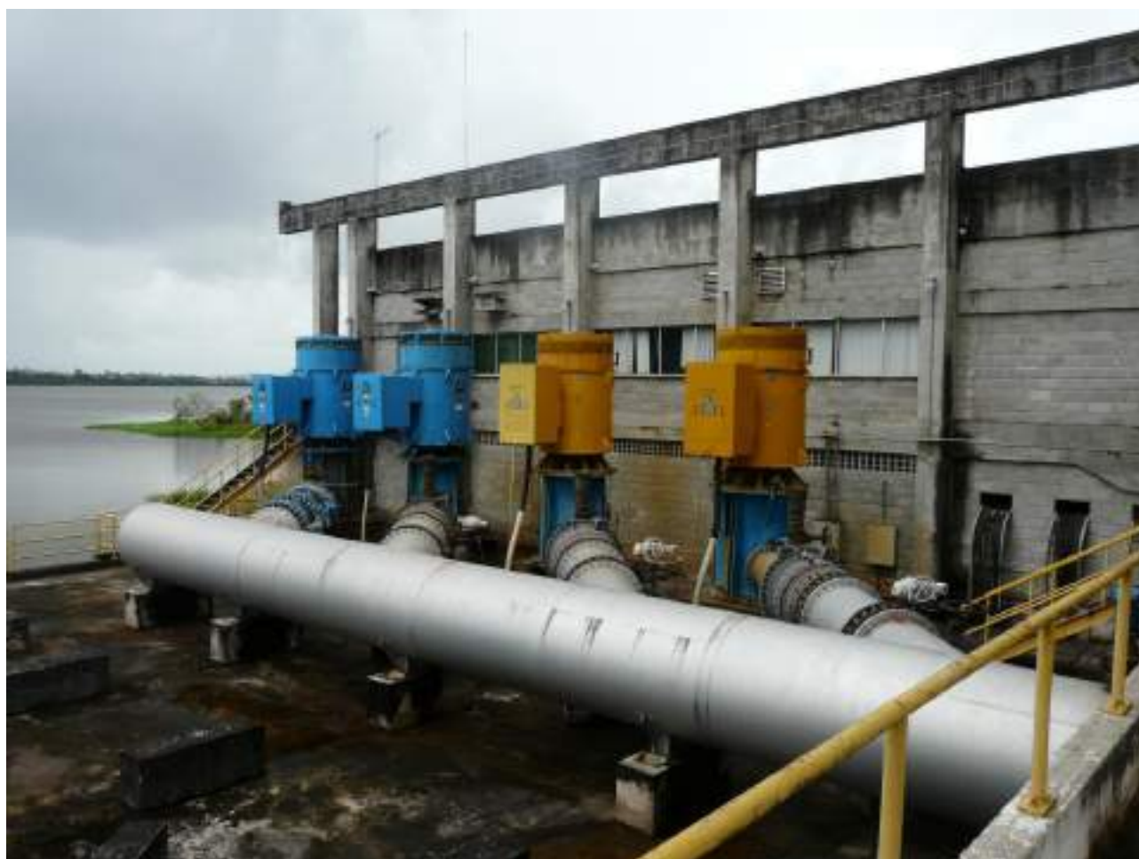
Figura 1. 28 - Vista da captação/elevatória do sistema adutor Joanes II – ETA Principal
