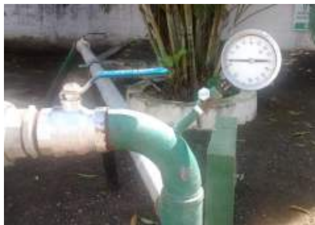
Figura 1.80 - Estruturas de medição de pressão e controle de vazão do Poço 1 (Bom Jesus dos Pobres)
