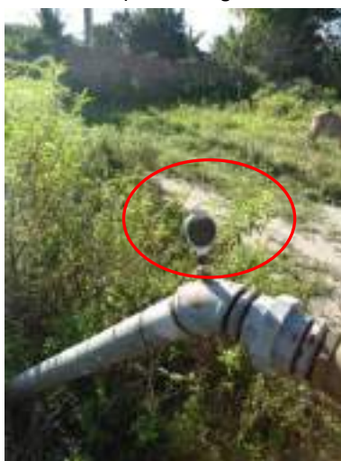
Figura 1. 62 - Poço P02 – Medidor de pressão (Detalhe em vermelho)
