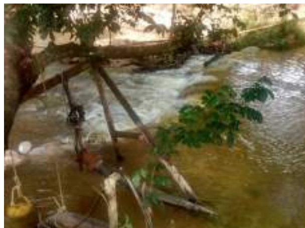
Figura 1. 88 - Estrutura de sustentação dos mangotes e da bomba
