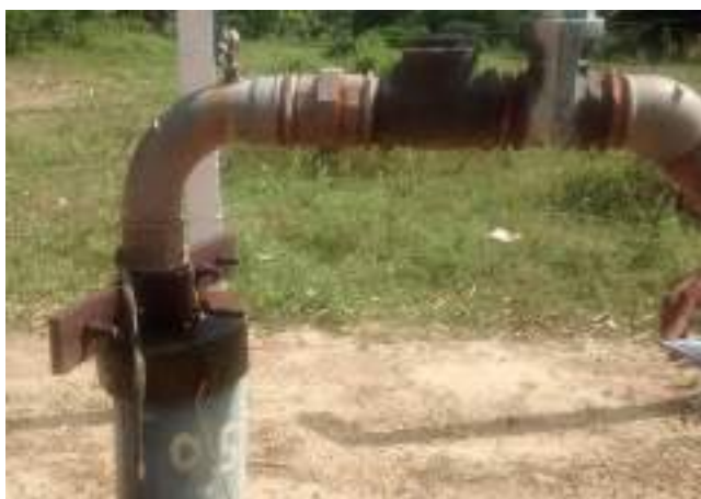
Figura 1. 77 - Poço 1 (Saubara) não apresenta estruturas de medição de pressão
