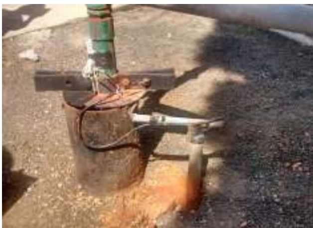
Figura 1.79 - Instalações elétricas do Poço 1 (Bom Jesus dos Pobres).
