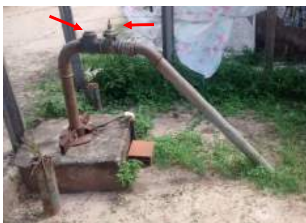
Figura 1.83 - Em destaque, a inexistência de estruturas de medição de vazão, ou registro de controle do sistema do Poço 1 (Cabuçu)
