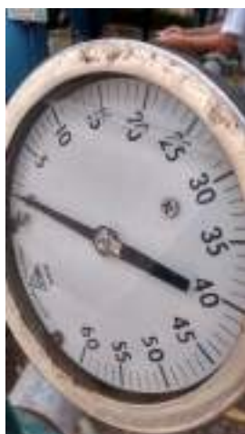
Figura 1.81 - Manômetro com vazamento Poço 1 (Bom Jesus dos Pobres)
