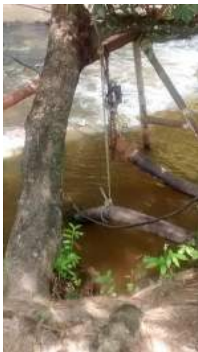
Figura 1. 89 - Estrutura de sustentação dos mangotes
