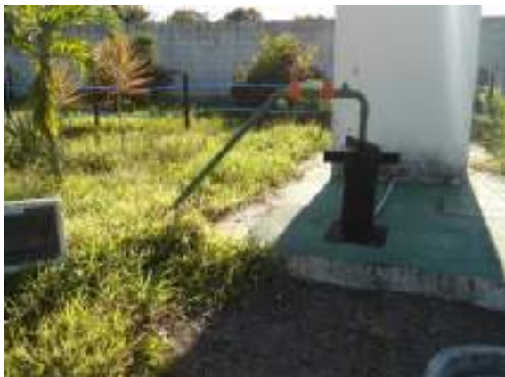
Figura 1. 60 - Poço P01 – Vista do barrilete de recalque
