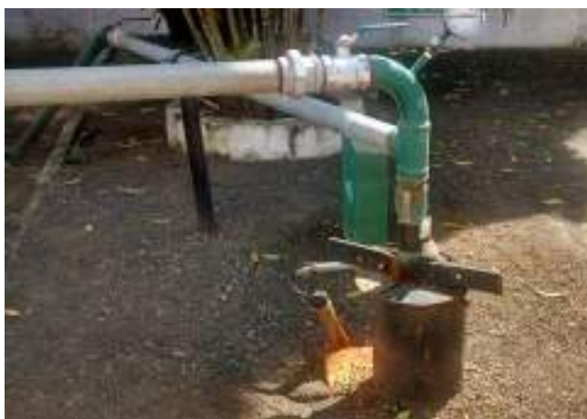
Figura 1. 73 - Poço 1 (Bom Jesus dos Pobres) localizado na área da ETA
