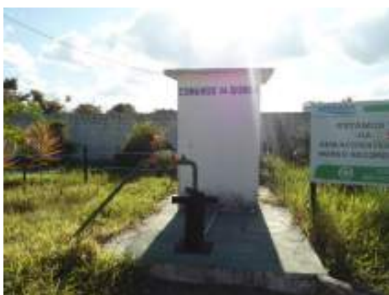
Figura 1. 53 - Poço P01 – Instalado na área da ETA do Planalto
