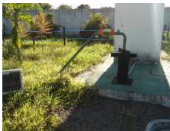
Figura 1. 54 - Poço P01 – Local da Instalação
