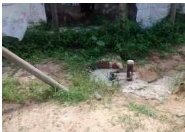
Figura 1.82 - Registro do Poço 1 (Cabuçu) sem estrutura de proteção
