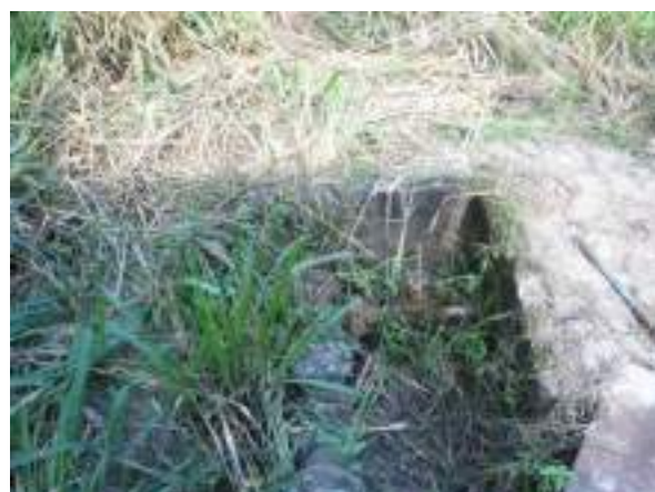
Figura 1. 34 - Caixa de registro desprotegida
