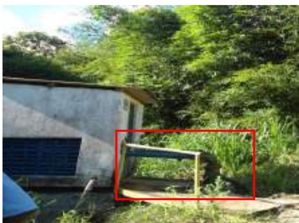
Figura 1. 33 - Destaque para as estruturas componentes da captação
