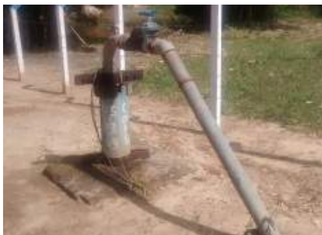
Figura 1. 64 - Poço 1 (Saubara) que encontra-se no mesmo local da captação superficial
