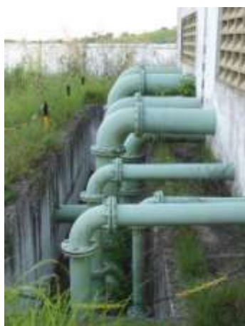
Figura 3.5 - Barriletes de saída do RAD 1.200 (para a estação elevatória)
