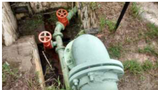
Figura 3.26 - Tubulação de descarga e saída de tubulação para Cabuçu
