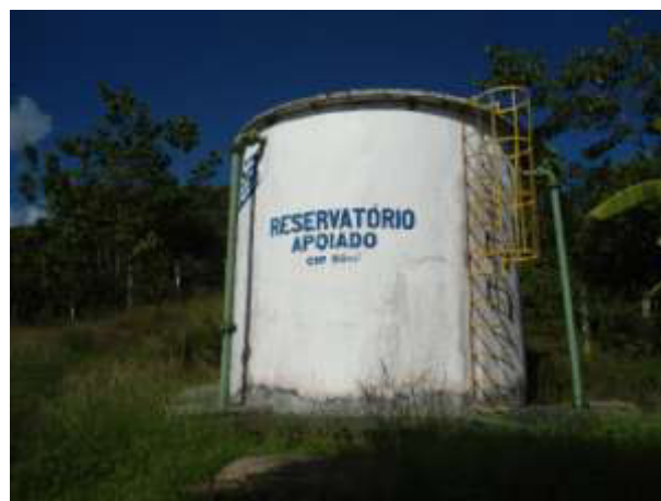
Figura 3.11 - Reservatório Apoiado de Distribuição (50m³)
