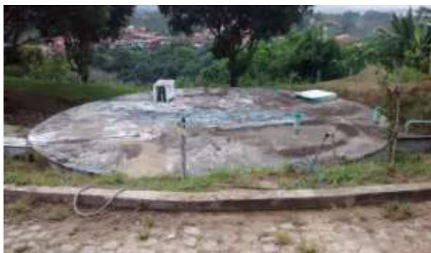
Figura 3.25 - Reservatório Enterrado de Distribuição (RENT) 200m 3
