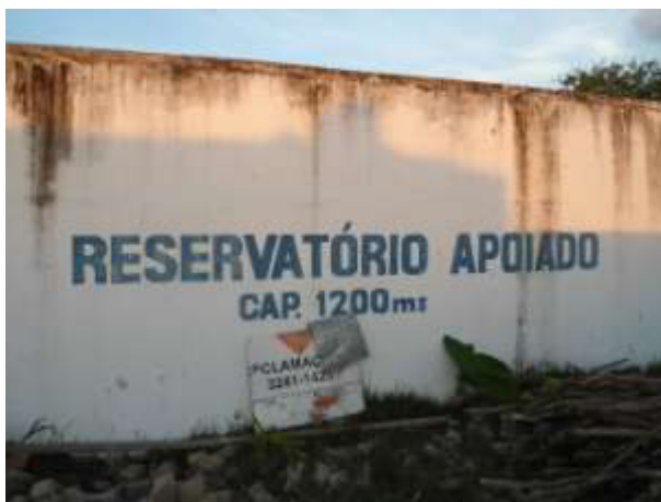
Figura 3.3 - Reservatório Apoiado de Distribuição - 1.200 m 3
