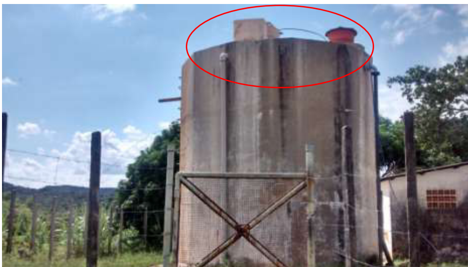
Figura 3.30 - Reservatório Apoiado de Distribuição (RAD) 100m 3 , com destaque para as unidades de tratamento
