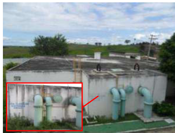
Figura 3.4 - Vista geral do RAD 1.200, onde observa-se o sistema de dosagem à vácuo de produtos químicos (em destaque)
