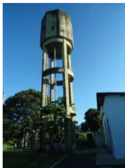
Figura 3.18 - Reservatório Elevado de Distribuição (50m³)
