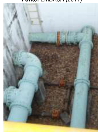
Figura 3.6 - Barriletes de saída do RAD 1.200 (para a rede de distribuição e RAD 600)
