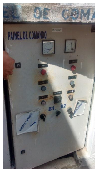
Figura 2.171 - Painel de comando das bombas de captação (B1), e de distribuição (B2)
