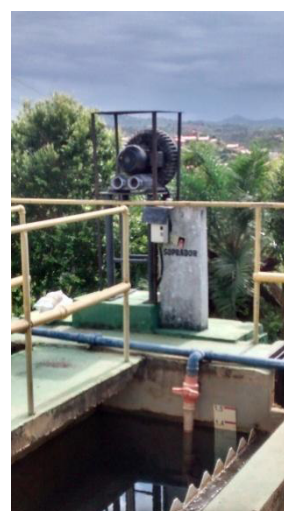
Figura 2.125 - Soprador - equipamento utilizado com a finalidade de movimentar o material filtrante, soltando as impurezas no momento da lavagem dos filtros, visando reduzir os gastos de água.
