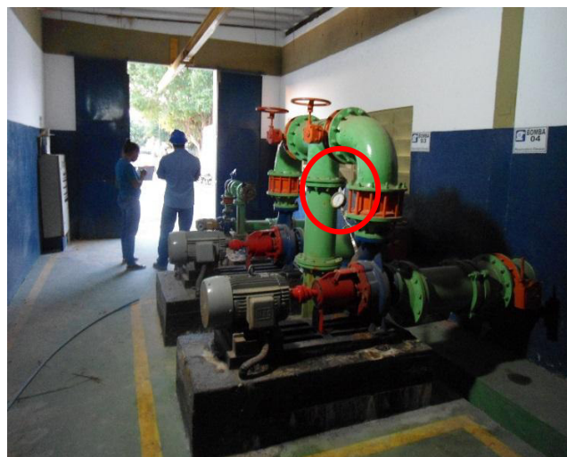
Figura 2.37 - CMB 3 e 4 de recalque de água tratada. Verifica-se a existência de medidor de pressão (em destaque)
