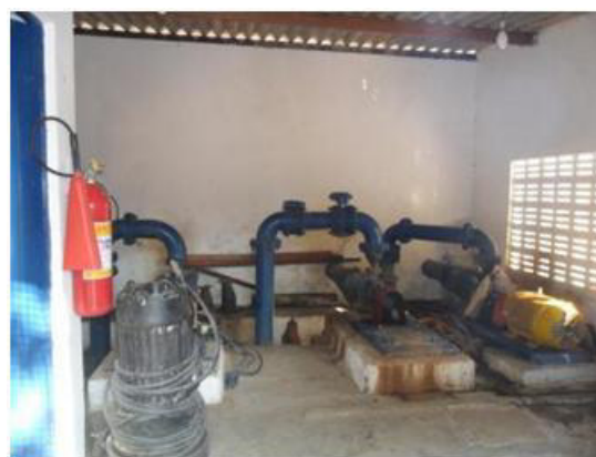
Figura 2.110 - Detalhe do Conjunto Motobomba da EEB Fonte: EMBASA, 2012
