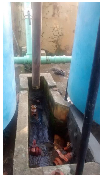
Figura 2.152 - Registros de descarga dos filtros
