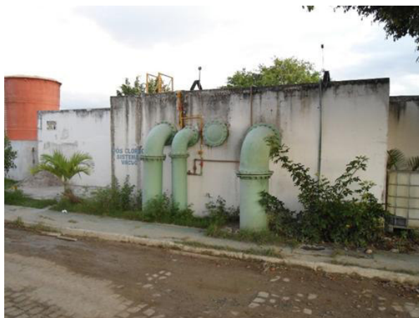
Figura 2.26 - Local de aplicação do cloro-gás no RAD 1.200m³ (sistema a vácuo)
