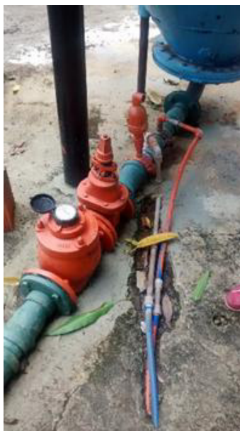
Figura 2.150 - Macromedidor na entrada do decantador
