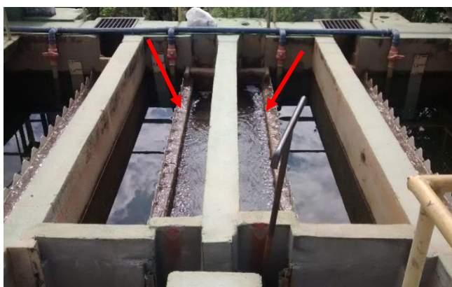
Figura 2.124 - Destaque para as calhas de coleta de água tratada
