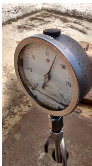
Figura 2.174 - Destaque para o manômetro da tubulação de recalque da EET2, com vazamento
