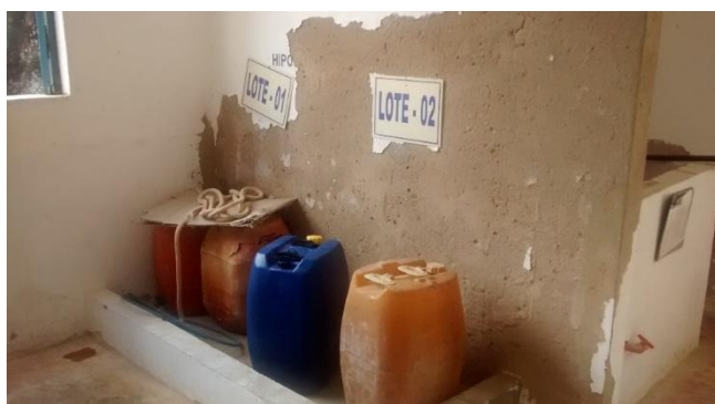
Figura 2.153 - Local de armazenamento de hipoclorito de sódio
