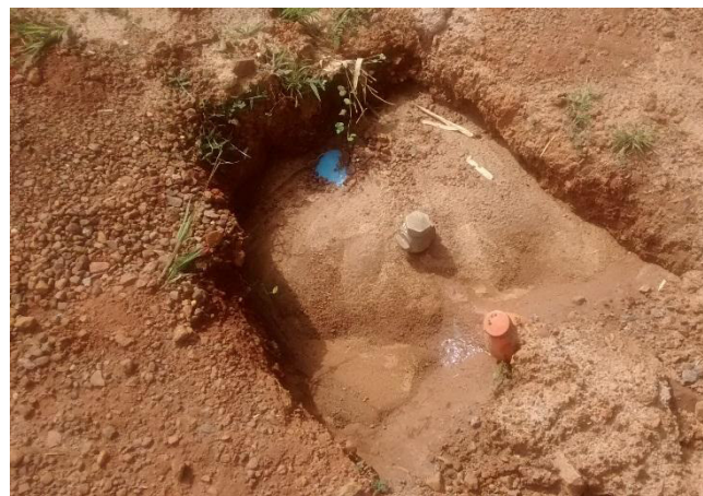
Figura 2.112 - Registro de controle do CSB1 (Saubara) sem caixa de proteção e aterrado
