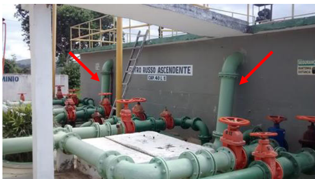
Figura 2.122 - Unidade de filtração - Filtros de fluxo ascendente. Na fotografia também observam-se os registros de controle dos filtros, e tubulação de coleta de água tratada (em destaque)
