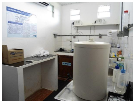
Figura 2.61 - Laboratório da ETA de São Brás
