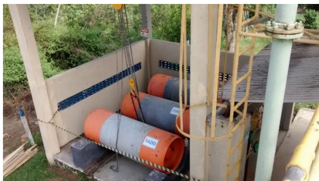
Figura 2.133 - Local de armazenamento do cloro-gás
