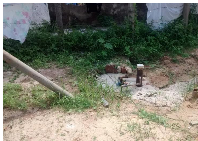
Figura 2.116 - Registro do CSB1 (Cabuçu) sem estrutura de proteção
