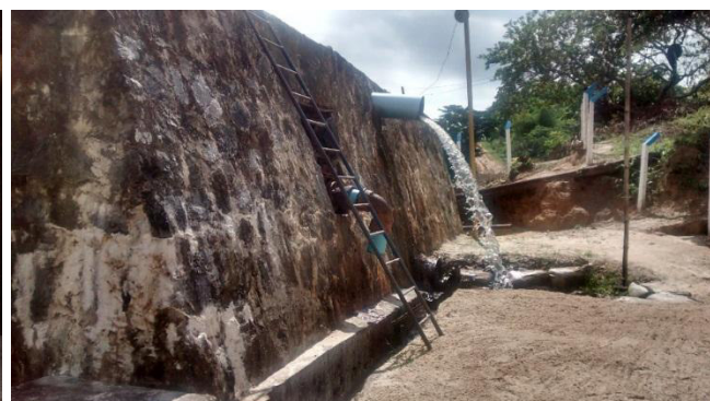
Figura 2.108 - Extravasor do poço de sucção, restitui água ao manancial
