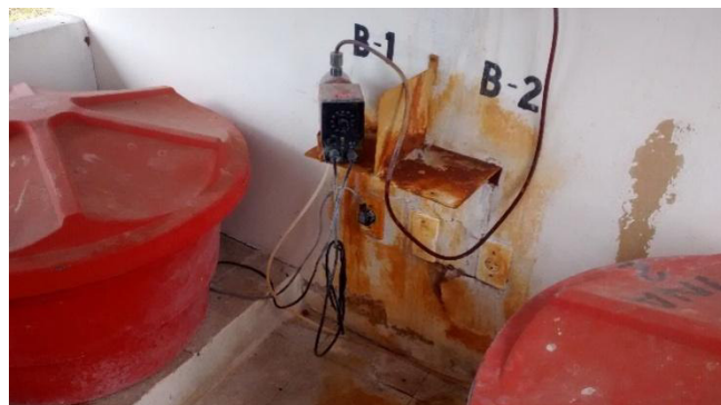
Figura 2.136 - Bomba dosadora - a bomba B-2 encontrava-se em manutenção
