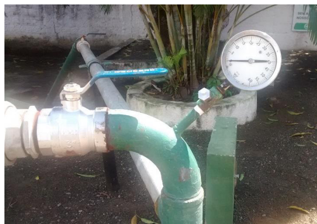
Figura 2.114 - Estruturas de medição de pressão e controle de vazão do CSB1 (Bom Jesus dos Pobres)
