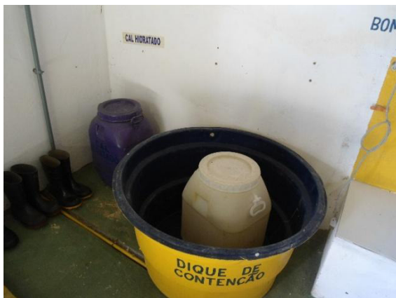
Figura 2.58 - Local de armazenamento do cal hidratado e dique de contenção de produto químico não identificado
