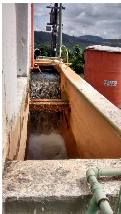
Figura 2.120 - Unidade de mistura rápida - Calha Parshall
