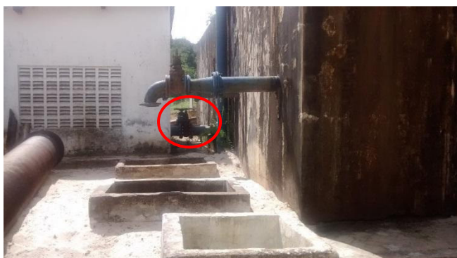
Figura 2.107 - Descarga do poço de sucção/desarenador, em destaque está a tubulação de sucção dos CMB
