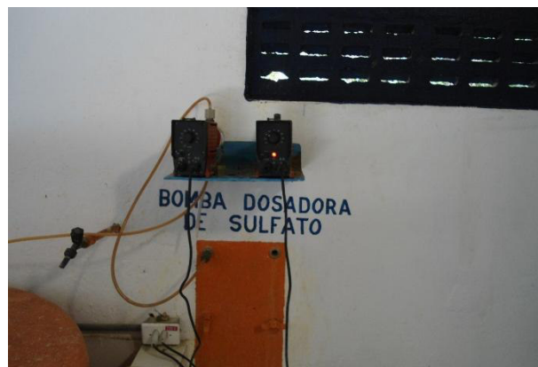
Figura 2.53 - Dosagem de sulfato de alumínio - bombas dosadoras
