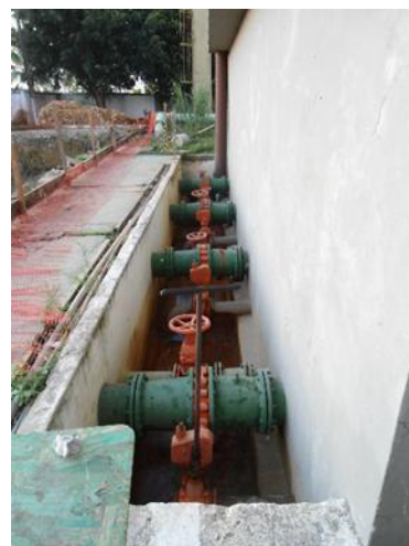
Figura 2.12 - Registros de controle dos filtros e tubulações de descarga
