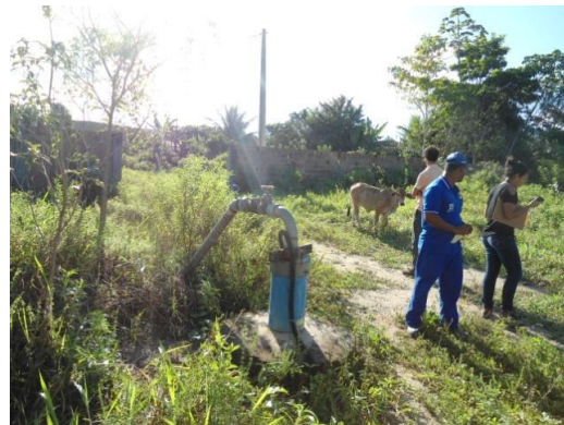
Figura 2.89 - EEAB2 – Local da instalação, presença de animais
