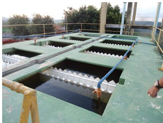
Figura 2.10 - Unidades de filtração (capacidade para 60L/s).
