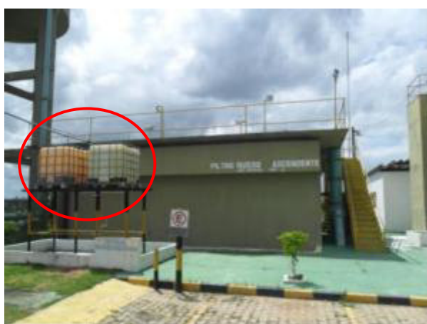
Figura 2.31 - Vista geral de um dos módulos de Filtros de Fluxo Ascendente em 2011
