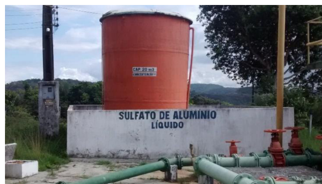
Figura 2.128 - Reservatório do coagulante - Capacidade: 20 m³
