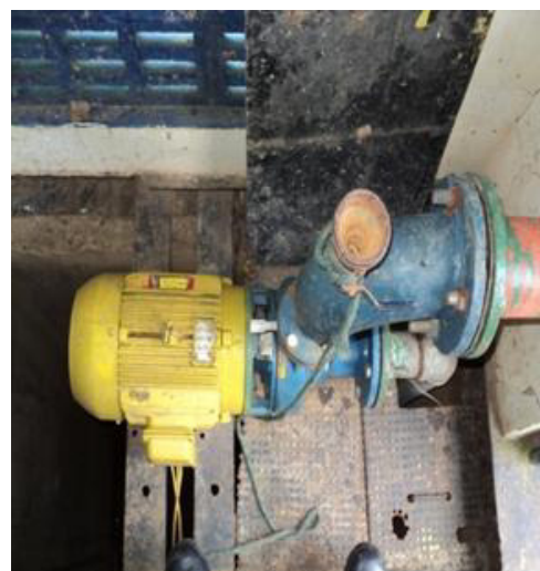
Figura 2.45 - Conjuntos Motobombas da captação
