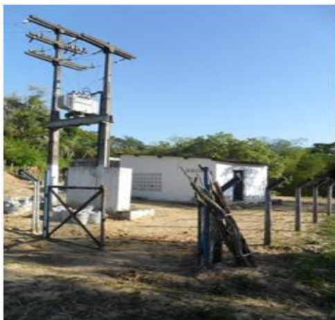
Figura 2.105 - Vista geral da EEB2 Fonte: EMBASA, 2012
