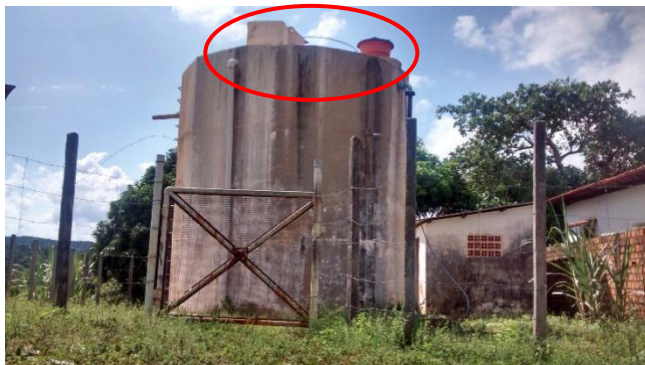
Figura 2.162 - RAD 100m 3 - Cabuçu. Destaque para o ponto de aplicação dos produtos químicos da simples desinfecção
