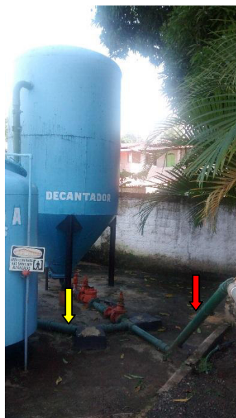
Figura 2.149 - Unidade de decantação que recebe água bruta do Poço 1, localizado dentro da ETA (seta vermelha), e do RAP 50m³ (seta amarela)
