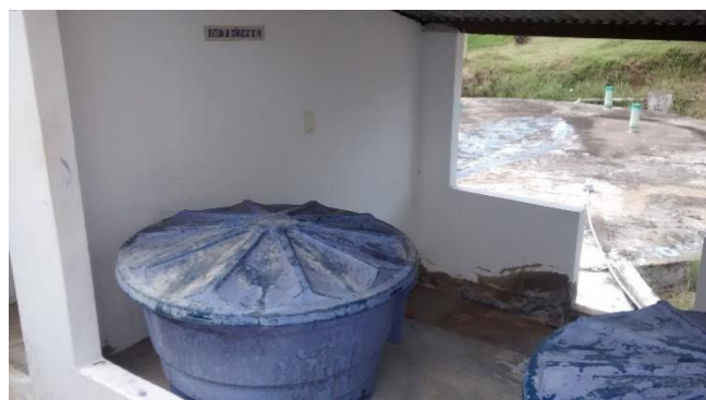
Figura 2.132 - Reservatórios de dosagem de carbonato de cálcio
