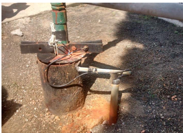
Figura 2.113 - Instalações elétricas do CSB1 (Bom Jesus dos Pobres).
