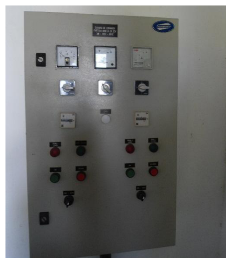
Figura 2.67 - Quadro de comando das bombas
