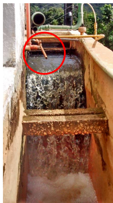
Figura 2.121 - Destaque para o ponto de aplicação do coagulante (sulfato de alumínio)
