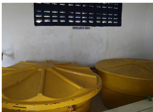
Figura 2.54 - Dosagem de cloro (hipoclorito de sódio) - aplicado no tanque de contato (RAP 50m 3 )
