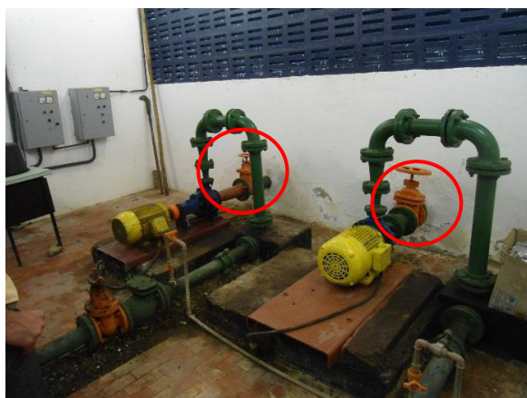
Figura 2.70 - Conjuntos motobombas da EEAB, destaca-se o quadro de comando ao fundo e os registros
