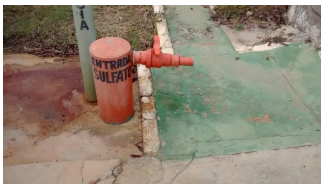
Figura 2.127 - Ponto de entrada de sulfato de alumínio - Local de abastecimento do reservatório de 20 m³
