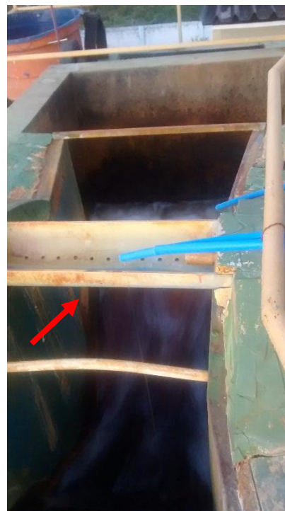
Figura 2.8 - Destaque para o ponto de aplicação do coagulante (sulfato de alumínio)
