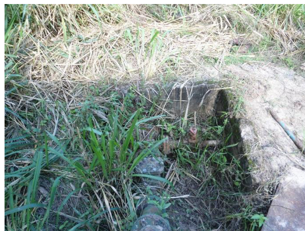
Figura 2.43 - Caixa de registro do sistema coberta pela vegetação
