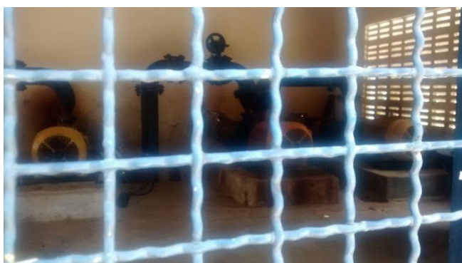
Figura 2.109 - CMB de água bruta - A equipe não teve acesso para verificação de suas condições
