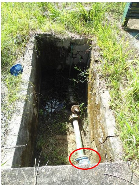
Figura 2.48 - Caixa de registro do sistema, onde encontra-se o macromedidor (em destaque)
