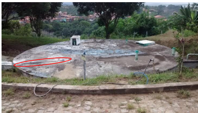
Figura 2.142 - Vista geral do RENT de 200\text{m}^3 . Destaca-se a tubulação de dosagem de carbonato de sódio (barrilha)
