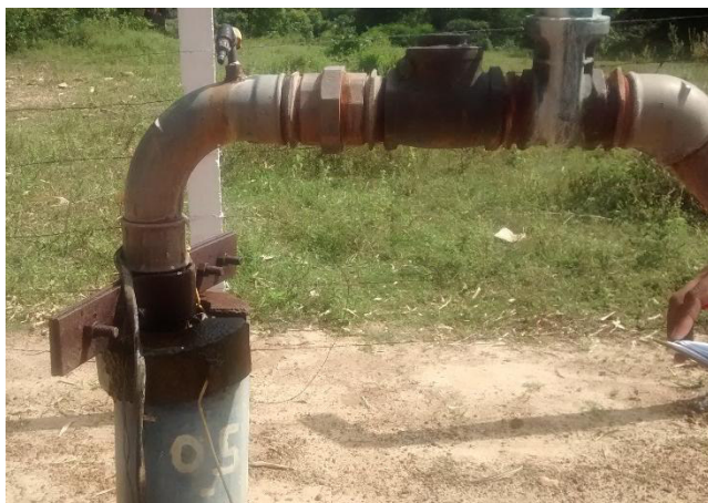
Figura 2.111 - CSB1 (Saubara) não apresenta estruturas de medição de pressão
