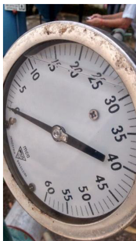
Figura 2.115 - Manômetro com vazamento CSB1 (Bom Jesus dos Pobres)
