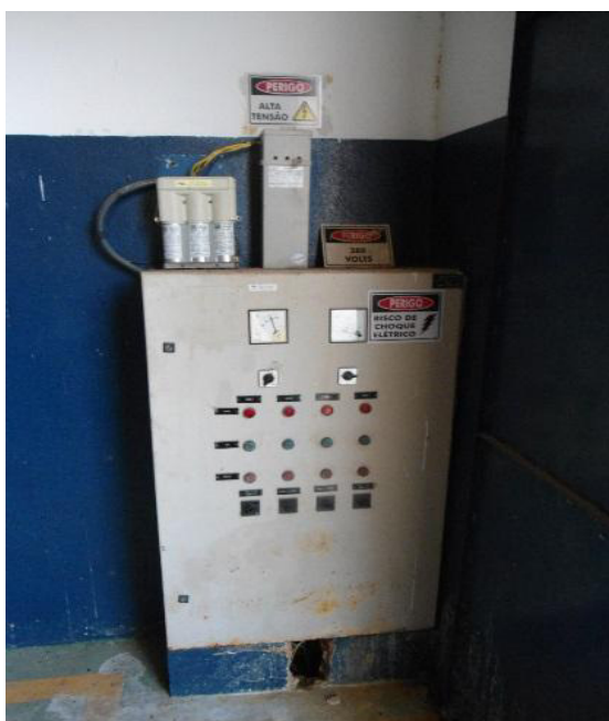
Figura 2.38 - Quadro de comando das bombas
