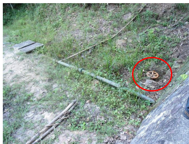
Figura 2.73 - Destaque para o registro de controle do sistema
