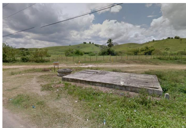
Figura 2.4 - Local da derivação da adutora DN 400 do SAA Santo Amaro (BA-084) destaque para a caixa de tomada
