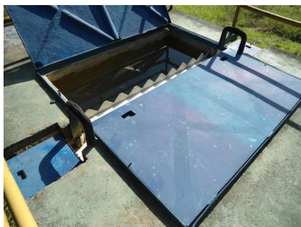
Figura 2.50 - Vista superior do filtro
