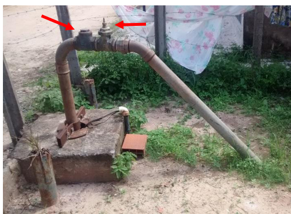
Figura 2.117 - Em destaque, a inexistência de estruturas de medição de vazão, ou registro de controle do sistema do CSB1 (Cabuçu)
