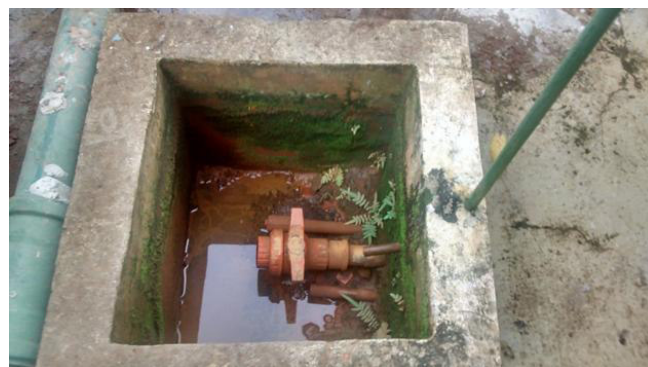
Figura 2.148 - Registro de descarga do decantador
