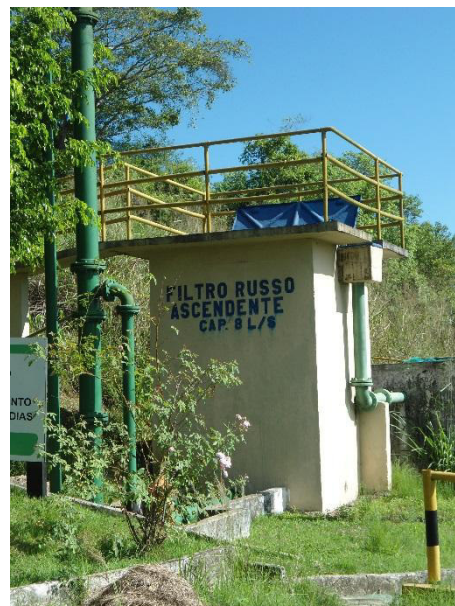
Figura 2.49 - Módulo de tratamento - Unidade de filtração
