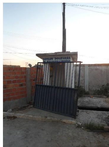
Figura 2.16 - Local de instalação das bombas dosadoras de sulfato de alumínio.
