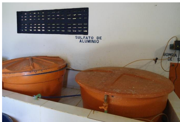
Figura 2.52 - Dosagem de sulfato de alumínio - aplicado no filtro
