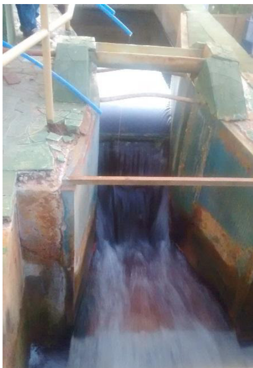
Figura 2.7 - Unidade de mistura rápida (vertedor tipo Calha Parshall )
