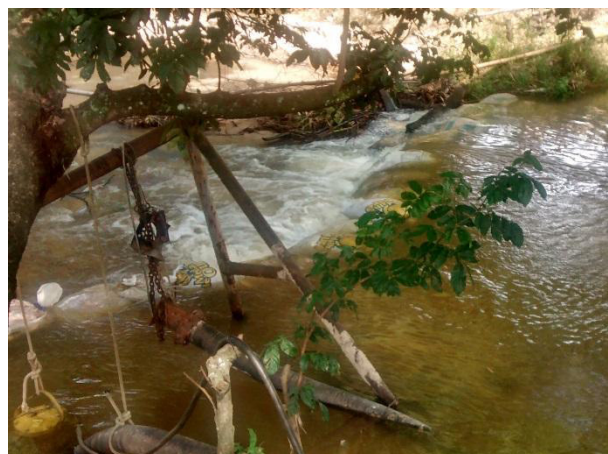
Figura 2.102 - Estrutura de sustentação dos mangotes e da bomba
