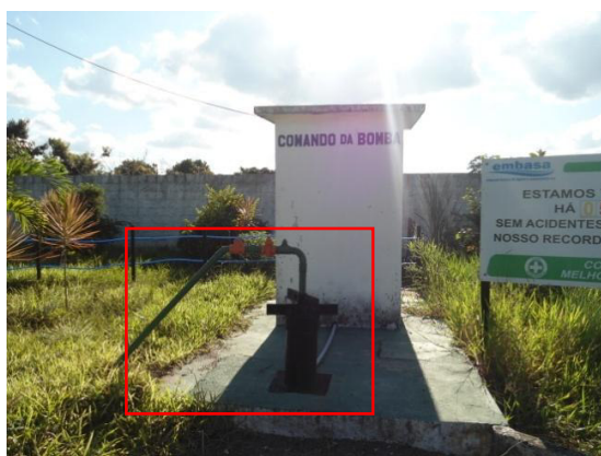
Figura 2.86 - Poço P01 – Instalado na área da ETA do SIAA do Planalto, detalhe em vermelho barrilete de recalque
