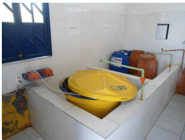
Figura 2.94 - Local de dosagem do Hipoclorito de Sódio
