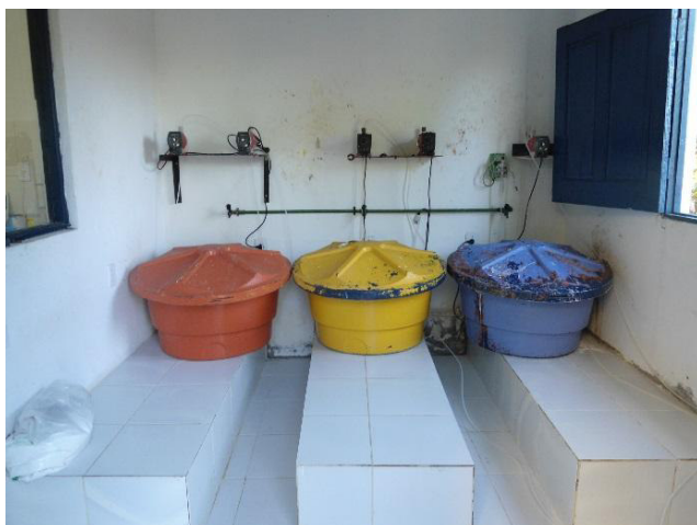
Figura 2.76 - Casa de química da ETA de Pedras onde são dosados a barrilha (recipiente lilás), o hipoclorito de sódio (recipiente amarelo) e o ácido fluossilícico (recipiente laranja)
