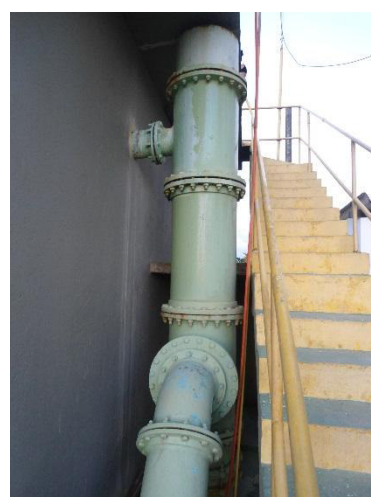
Figura 2.14 - Tubulação de saída de água tratada dos filtros
