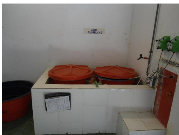
Figura 2.56 - Dosagem de Ácido Fluossilícico - aplicado no tanque de contato (RAP 50m 3 )
