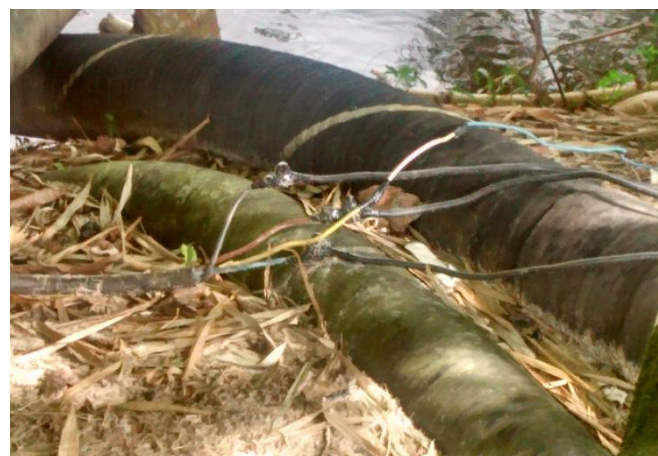
Figura 2.103 - Instalações elétricas (em destaque) expostas
