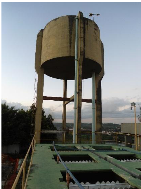
Figura 2.23 - REL 300 m 3 - Reservatório de lavagem dos filtros
