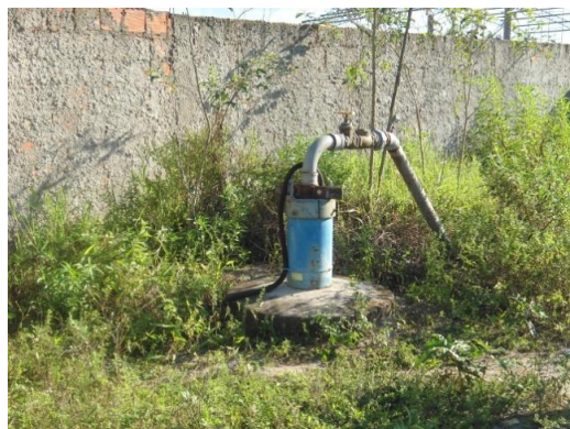
Figura 2.88 - Poço P02 – Vista do barrilete de recalque
