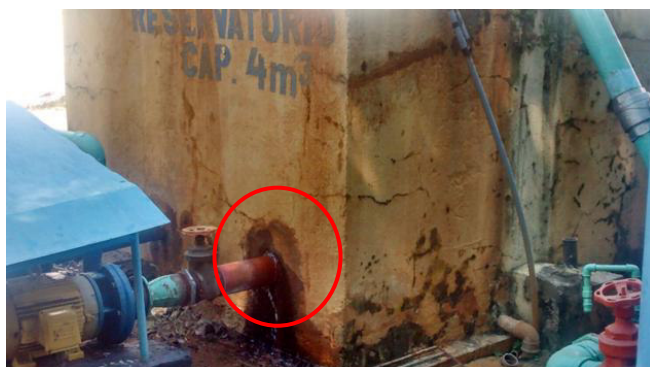
Figura 2.170 - Vazamento no barrilete de sucção das bombas
