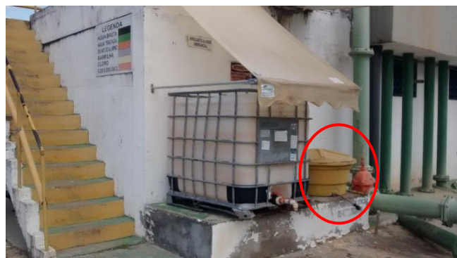
Figura 2.134 - Dosagem (em destaque) e armazenamento do hipoclorito de sódio
