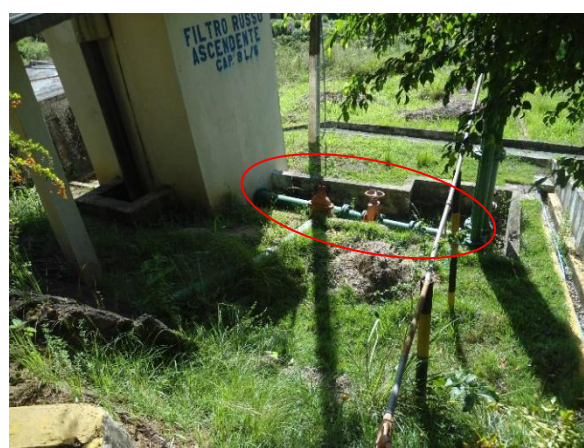
Figura 2.51 - Destaque para os barriletes componentes dos filtros
