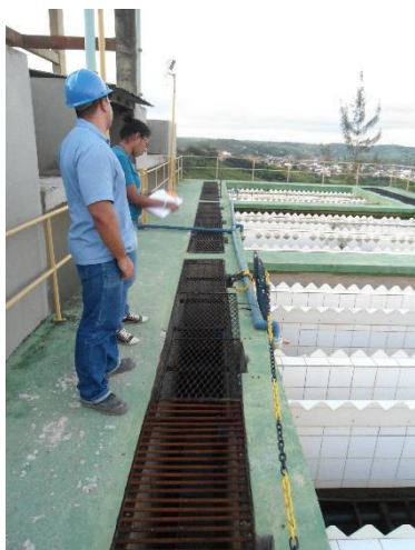
Figura 2.11 - Unidades de filtração (capacidade para 90L/s)
