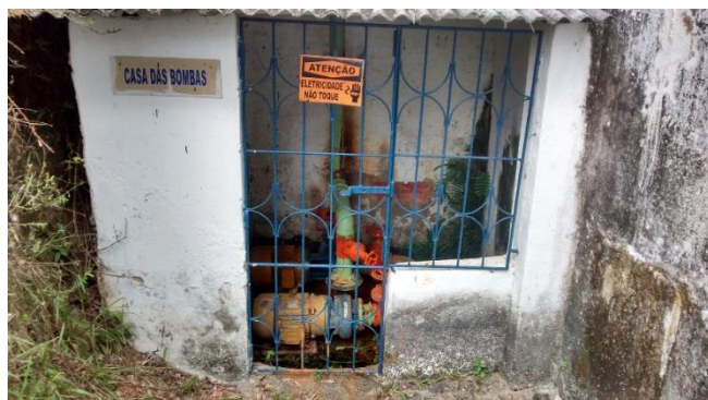
Figura 2.168 - Casa de bombas da ETA de Saubara, responsável pelo recalque de água tratada para o RED 50 m 3
