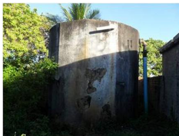
Figura 2.161 - Reservatório Apoiado (RAP) - 50 m 3 Fonte: EMBASA, 2012
