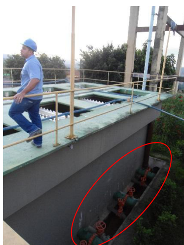
Figura 2.13 - Registros de controle dos filtros e tubulações de descarga
