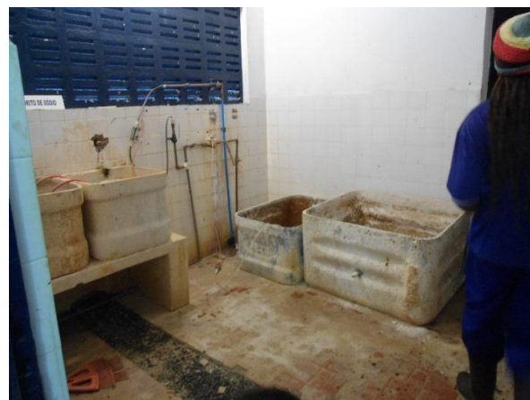
Figura 2.71 - Antigo local de dosagem de hipoclorito de sódio
