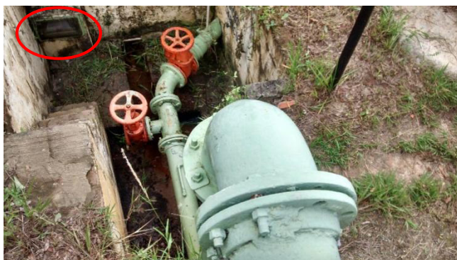
Figura 2.144 - Ponto de coleta de água tratada (em destaque) e tubulação adutora da rede de distribuição de cabuçu
