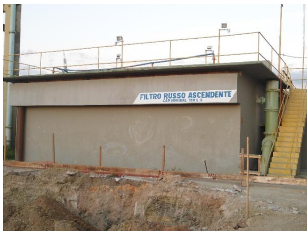
Figura 2.9 - Unidade de filtração do tipo fluxo ascendente (Filtro Russo)
