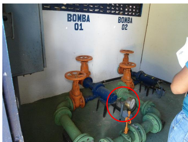
Figura 2.66 - Conjuntos motobombas - recalcam para o Reservatório Apoiado de Distribuição (RAD) de 50m 3 . Destaque para o medidor de pressão
