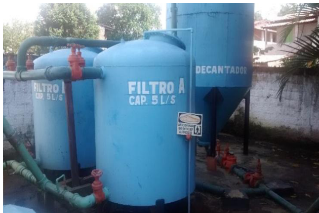
Figura 2.151 - Filtro A e Filtro B, ambos com capacidade de tratamento de 5 L/s
