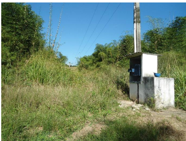
Figura 2.42 - Quadro de comando dos CMB
