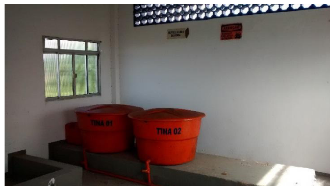
Figura 2.130 - Local de armazenamento de sulfato de alumínio, utilizado em situações emergenciais
