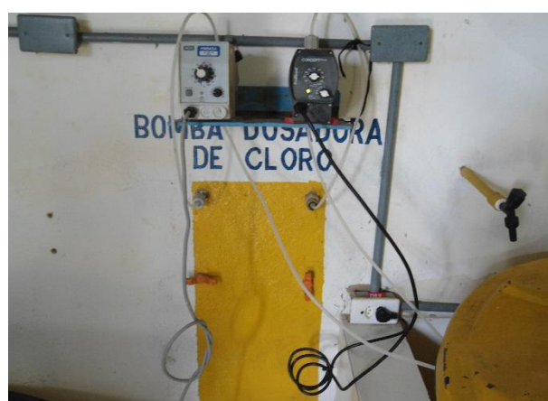
Figura 2.55 - Dosagem de cloro (hipoclorito de sódio) - bombas dosadoras
