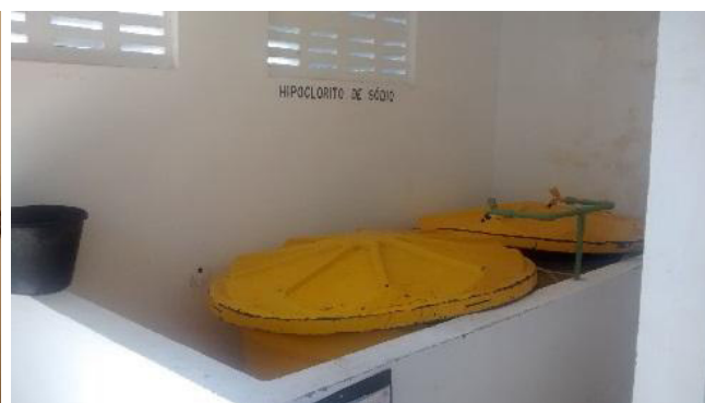
Figura 2.156 - Dosagem de hipoclorito de sódio
