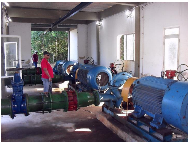
Figura 7.35 – Vista geral dos conjuntos motobomba
