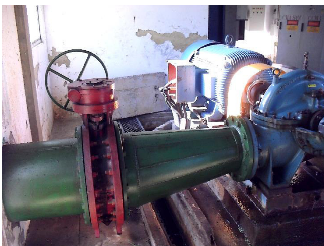
Figura 7.37 – Detalhe de conjunto motobomba
