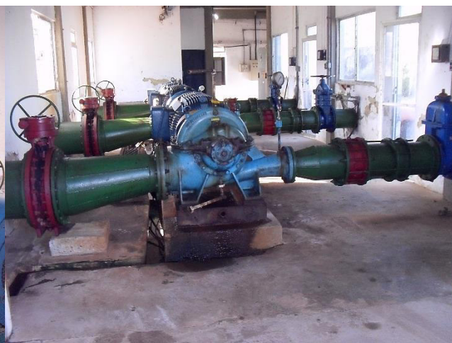
Figura 7.36 – Vista geral dos conjuntos motobomba
