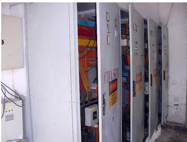
Figura 7.39 – Quadros elétricos dos motores
