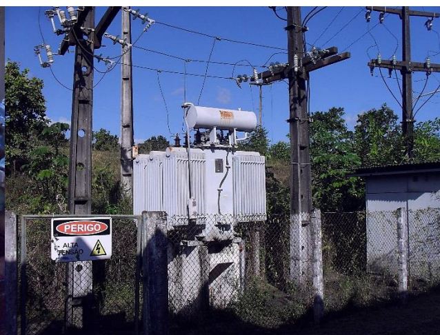
Figura 7.38 – Subestação de energia elétrica da EEAB
