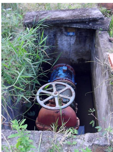
Figura 7.43 – Detalhe de registro da EEAB
