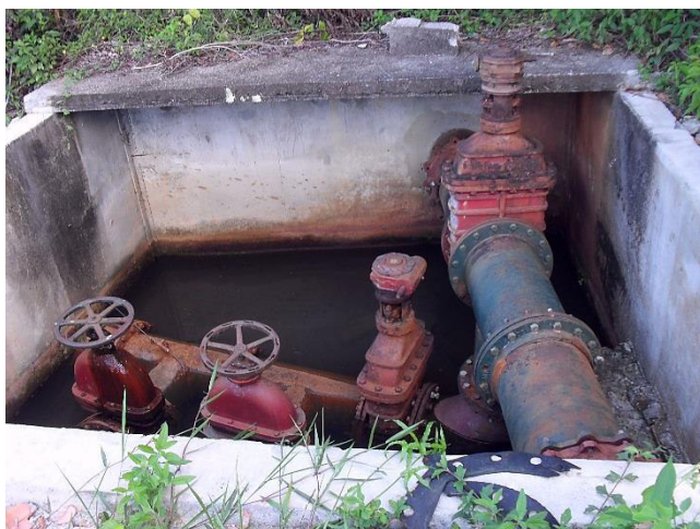
Figura 7.41 – Barrilete da EEAB
