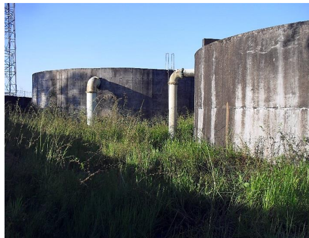
Figura 9.6 – Vista dos reservatórios do RAD3
