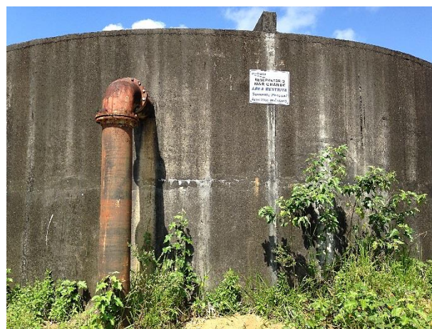
Figura 9.16 – Vista de reservatório do RAD9
