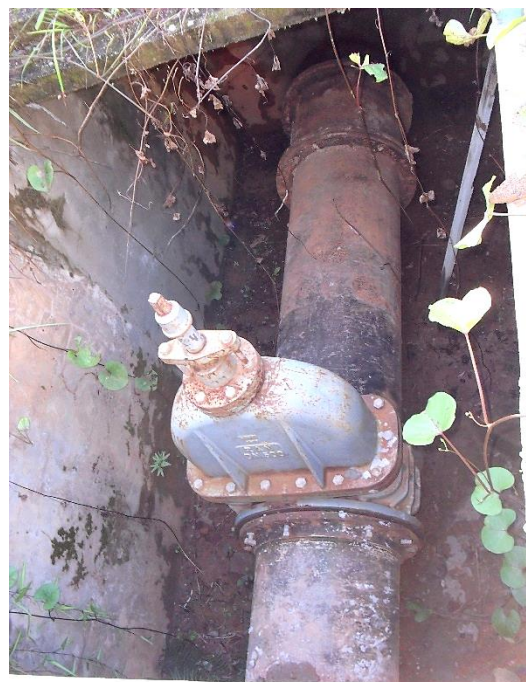
Figura 9.8 – Válvula de manobra em mau estado de conservação no RAD3
