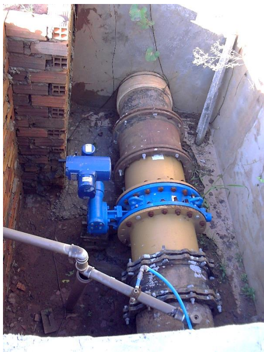
Figura 9.7 – Válvula de fechamento e abertura na área de reservação do RAD3
