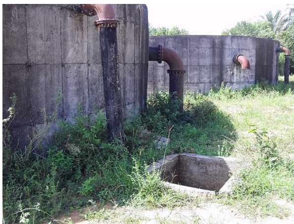
Figura 9.17 – Detalhe dos reservatórios do RAD9
