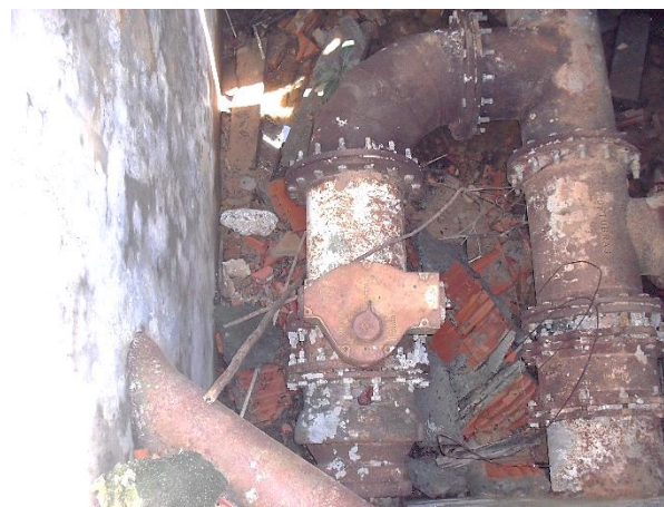
Figura 9.18 – Detalhe do barrilete do RAD9
