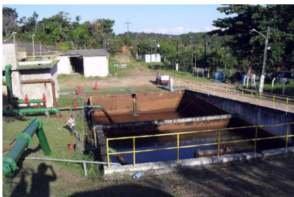
Figura 8.41 – Vista geral dos tanques de decantação da ETA
