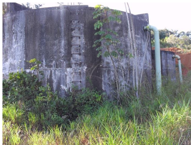
Figura 8.39 – Reservatórios de lavagem da ETA
