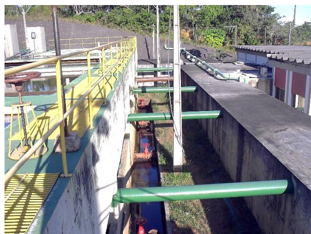
Figura 8.25 – Detalhe das saídas dos filtros para o reservatório e câmara de contato e tubulação de descarga na ETA
