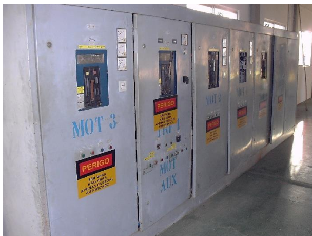
Figura 8.48 – Quadros de comando dos motores da EEAT1
