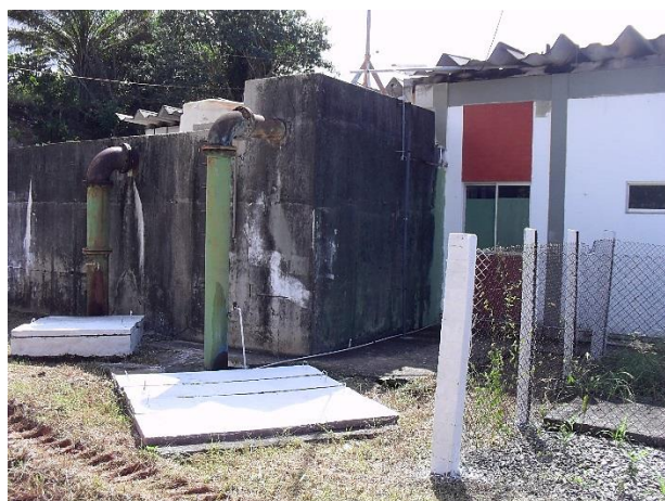
Figura 8.55 – Vista do poço de sucção da EEAT2
