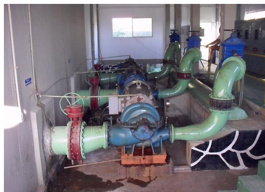
Figura 8.45 – Vista dos três conjuntos motobomba da EEAT1
