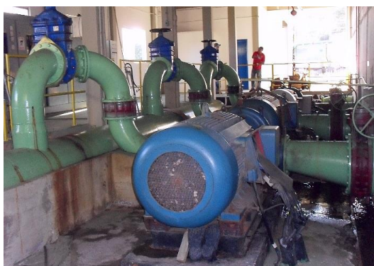
Figura 8.46 – Vista dos três conjuntos motobomba da EEAT1
