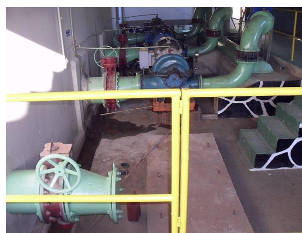
Figura 8.51 – Detalhe da espera para implantação de quarto conjunto motobomba na EEAT1
