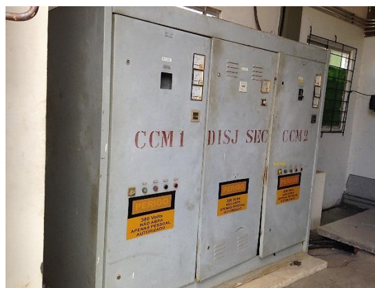
Figura 8.58 – Quadros dos motores da EEAT2
