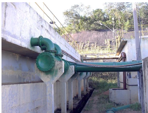
Figura 8.26 – Detalhe da saída dos filtros na ETA
