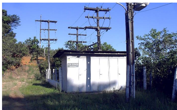
Figura 8.52 – Subestação elétrica da EEAT1
