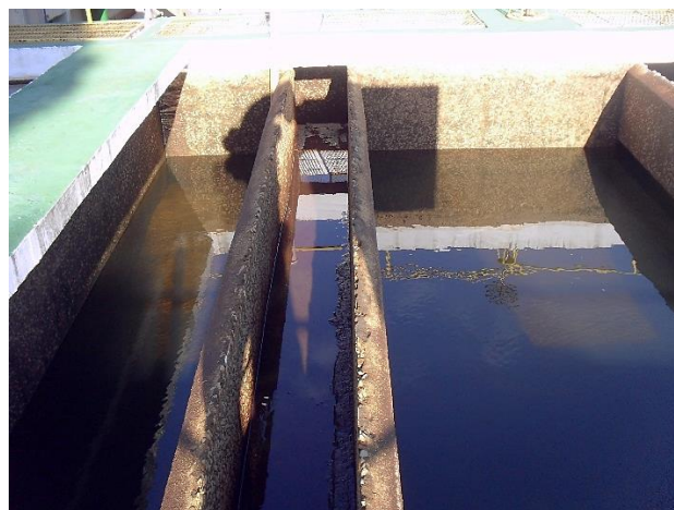
Figura 8.23 – Detalhe da calha coletora (filtro desligado) na ETA
