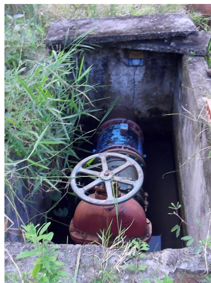
Figura 8.13 – Detalhe de válvula no início da adutora com macromedidor eletromagnético
