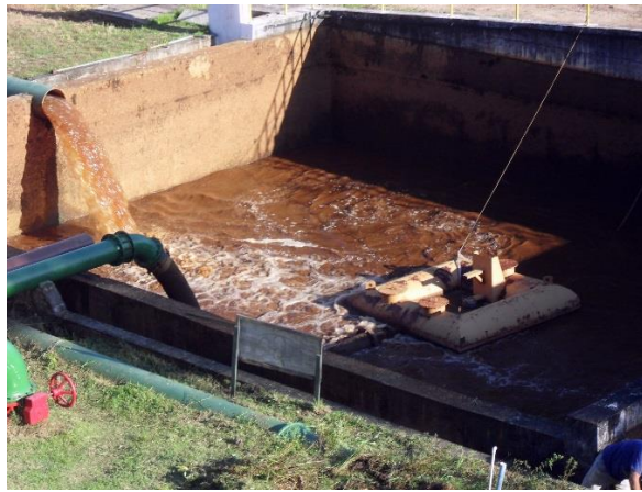
Figura 8.43 – Detalhe da entrada d'água e conjunto motobomba flutuante da ETA
