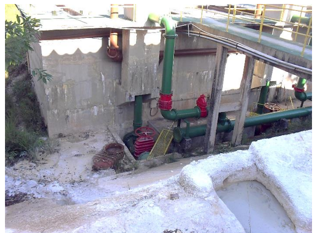
Figura 8.21 – Detalhe do barrilhete de entrada de filtro na ETA
