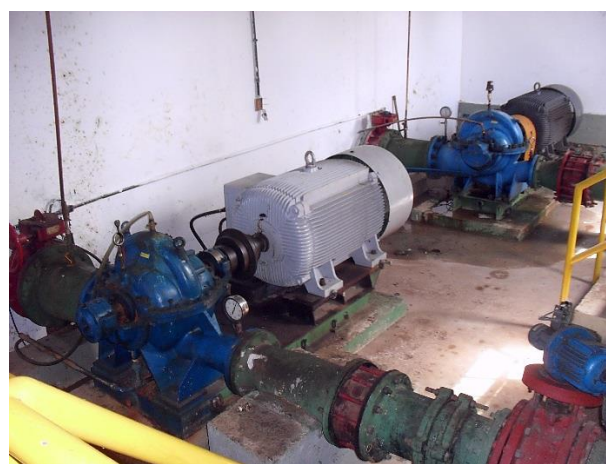
Figura 8.54 – Vista dos conjuntos motobomba da EEAT2
