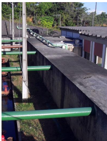
Figura 8.38 – Reservatório apoiado que funciona como câmara de contato na ETA
