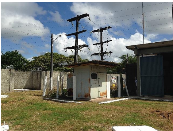
Figura 8.57 – Subestação elétrica da EEAT2
