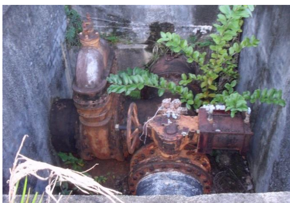
Figura 8.40 – Detalhe do barrilete dos reservatórios de lavagem da ETA
