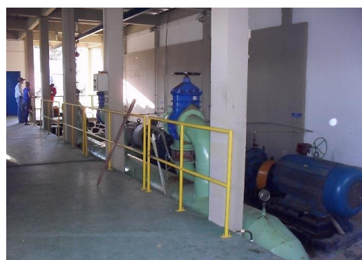
Figura 8.47 – Vista interna da EEAT1
