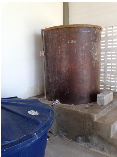
Figura 8.59 – Reservatórios da casa de recloração da EEAT2
