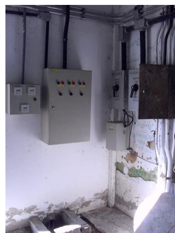
Figura 8.10 – Quadros dos motores da EEAB1
