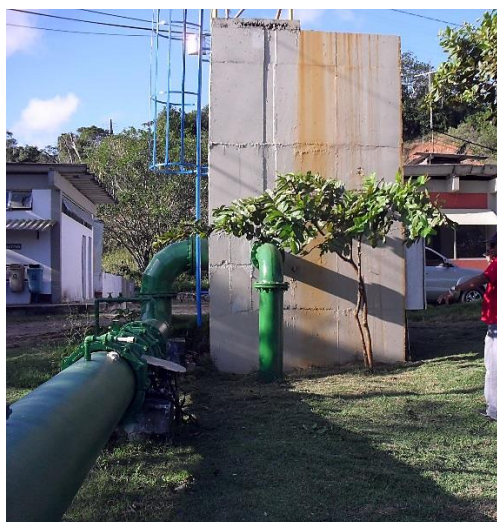
Figura 8.29 – Torre de mistura da ETA
