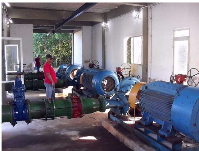
Figura 8.5 – Vista geral dos conjuntos motobomba da EEAB1
