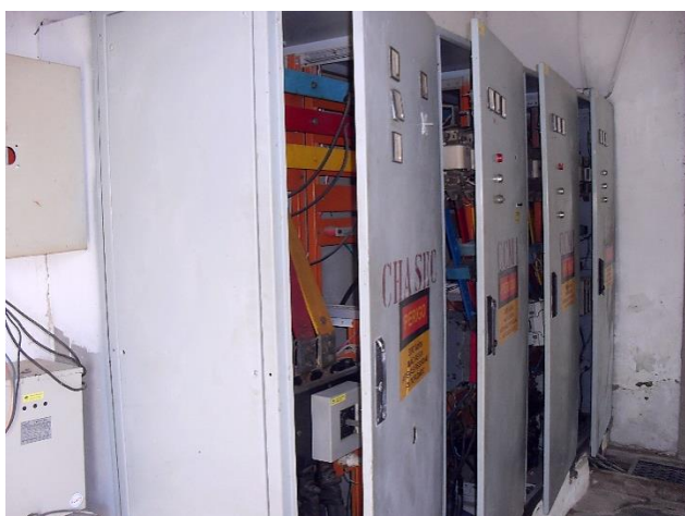
Figura 8.9 – Quadros elétricos dos motores da EEAB1
