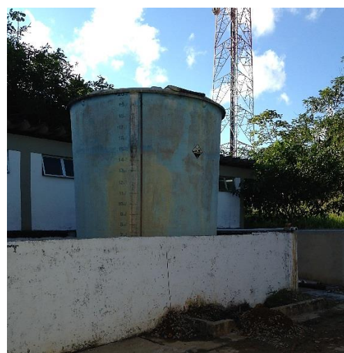
Figura 8.30 – Reservatório de armazenamento do sulfato de alumínio líquido da ETA
