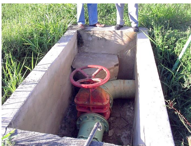
Figura 8.50 – Detalhe de válvula da EEAT1
