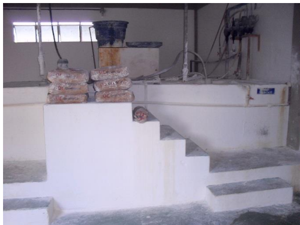
Figura 8.32 – Tanques de mistura de hidróxido de cálcio da ETA
