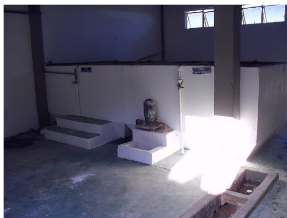
Figura 8.31 – Tanques de diluição do sulfato de alumínio da ETA
