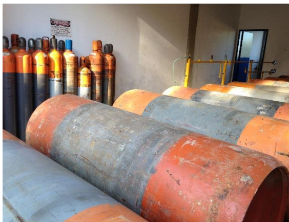
Figura 8.34 – Depósito de gás cloro da ETA. Cilindros de 900kg em primeiro plano.
