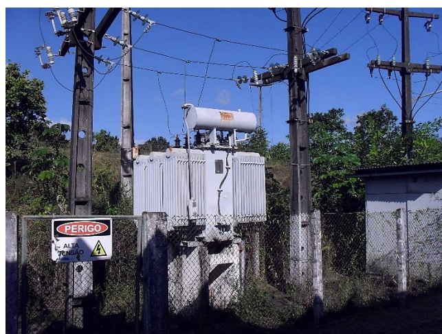
Figura 8.8 – Subestação de energia elétrica da EEAB1
