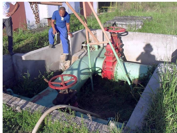
Figura 8.49 – Barrilete de saída da EEAT1
