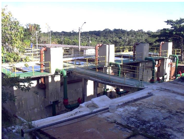
Figura 8.20 – Vista de quatro filtros russos da ETA
