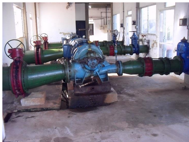
Figura 8.6 – Vista geral dos conjuntos motobomba da EEAB1
