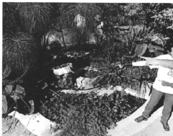
Figura 55: BSI unifamiliar no Espaço Almagestum, Pedra Bela-SP. O filtro anaeróbio e zona de raízes foram construídos sobre o biodigestor. No centro, o encanamento para saída do biogás
