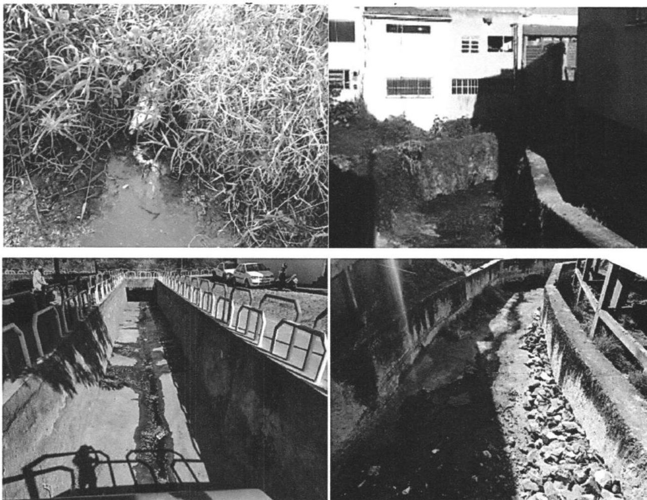
Figura 25: Entroncamento de esgoto no canal de drenagem na rua Manuel Messias Figueredo – Macaúbas/BA
