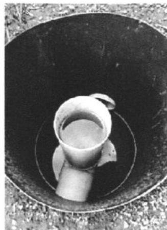
Figura 46: Mecanismo de controle de nível feito com tubos de PVC em sistema da EMBRAPA chamado de "jardins filtrantes"
