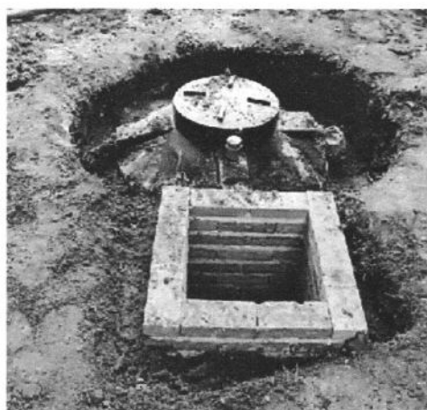
Figura 34: Vista geral de RAFA comercial, instalado ao lado da caixa para retirada e secagem do lodo, feita com tijolos
