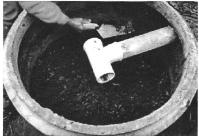
Figura 52: Vermifiltro construído com anéis de concreto em São Francisco Xavier- SP. Detalhe do Tê para distribuição do esgoto
