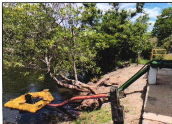
Figura 14 - Captação Flutuante e EEAB1
