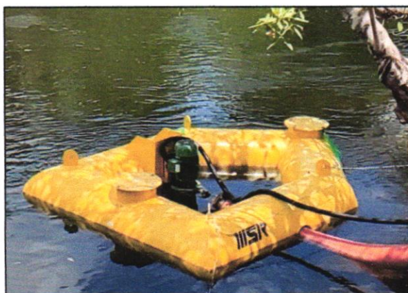
Figura 13 - Captação Flutuante – Rio Itaguari
