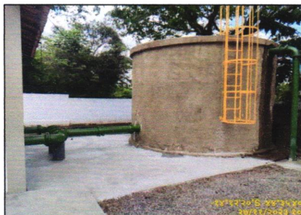
Figura 22 - Poço de sucção 50 m3 - EEAB2
