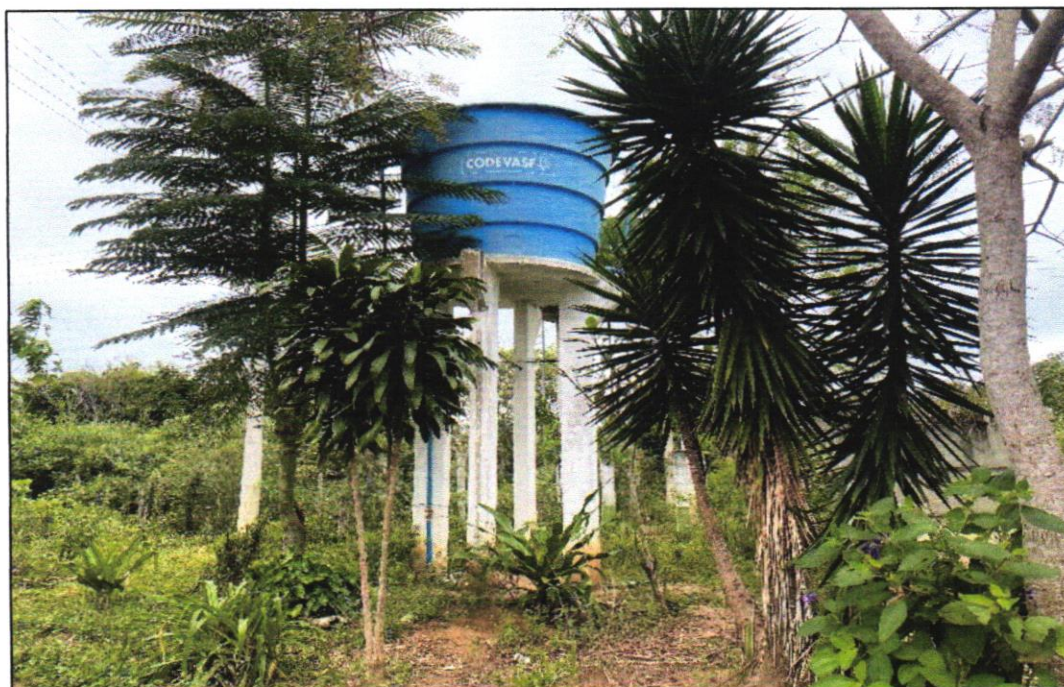
RED10 m3 desativado – PA Lagoa do Caldeirão
