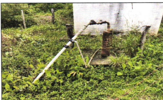
Poço CERB – PA Cipó
