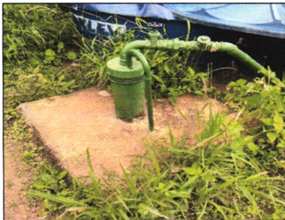
Poço – PA Lagoa do Caldeirão
