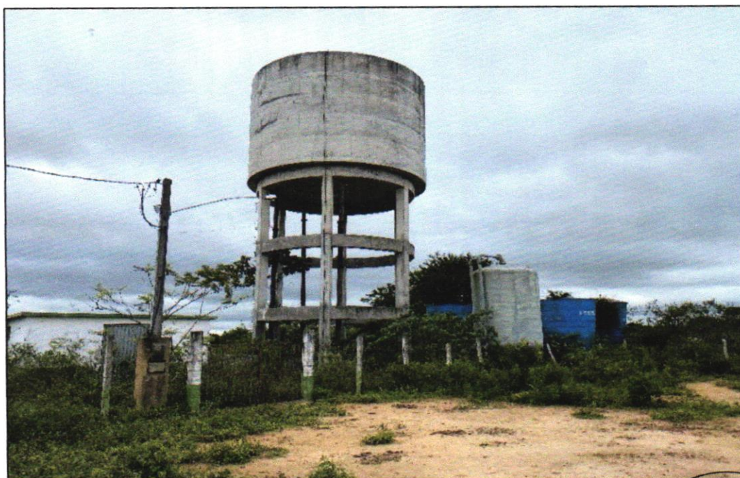
Estação de Tratamento de Água – RED300 m 3 , Padrão de entrada de energia
