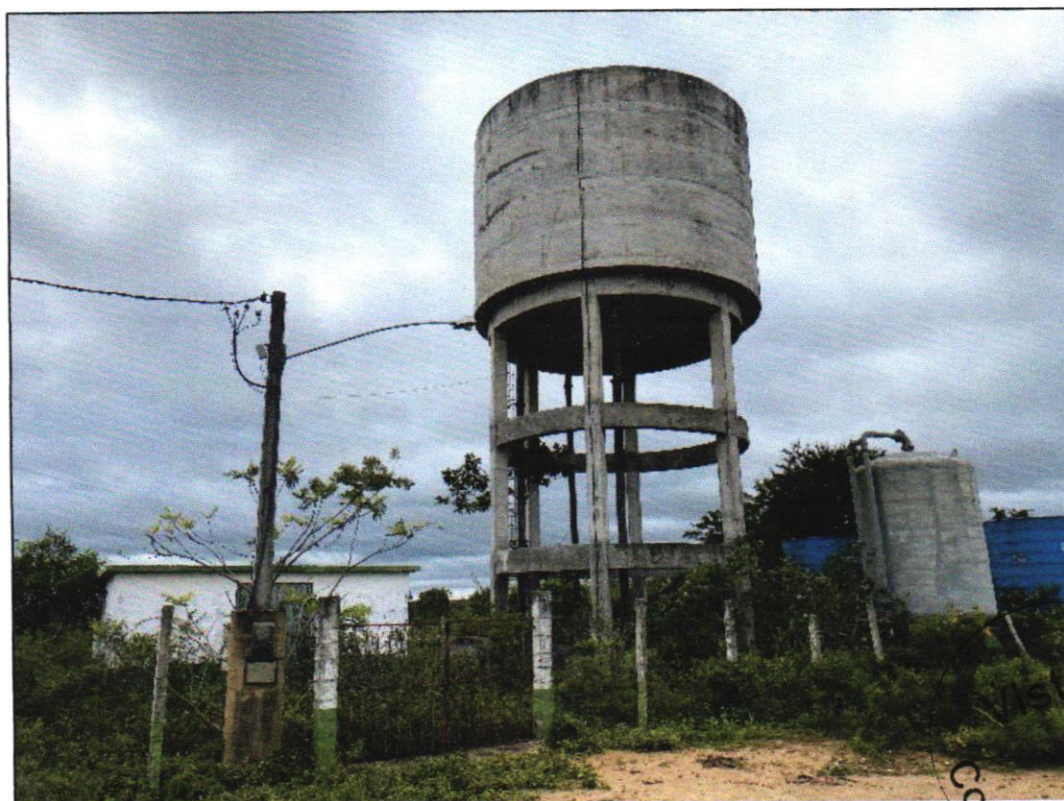
Estação de Tratamento de Água – Detalhe do Filtro, casa de química e RED instalados
