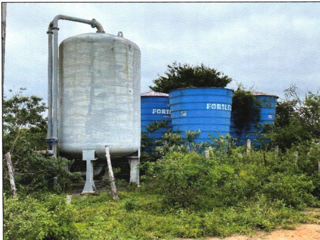
Estação de Tratamento de Água – Detalhe do Filtro e RADs instalados
