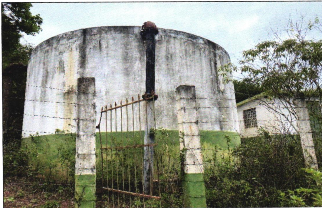
EEAB 2 – ADUTORA DE ÁGUA BRUTA
