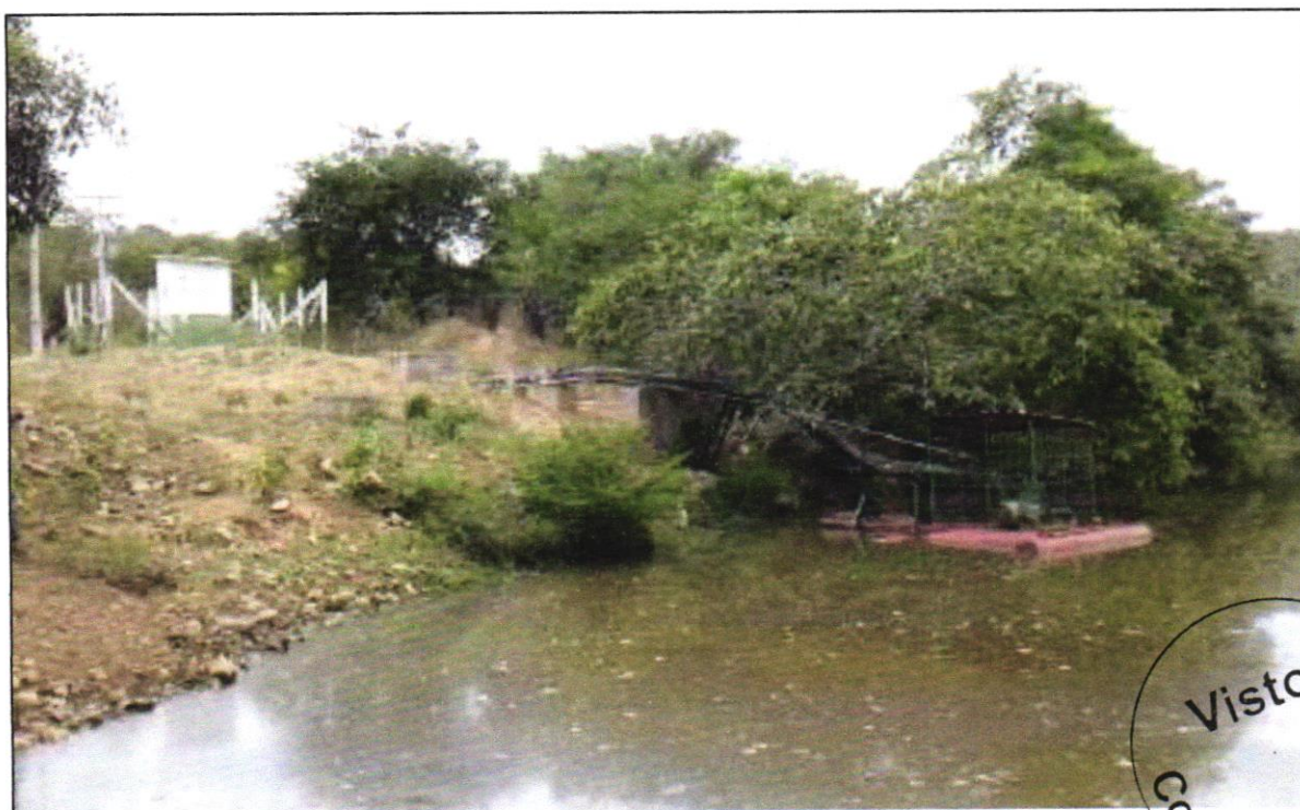
Captação Flutuante – Rio Pardo
