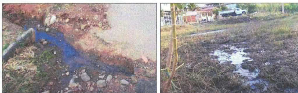
Figura 8. Registros de esgoto a céu aberto na Via de Acesso A Rua José Carlos II, Macaúbas-BA
