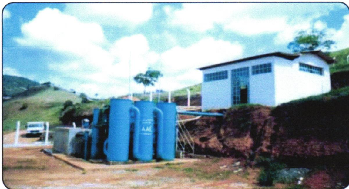
Figura 17. ETA compacta com casa de química
