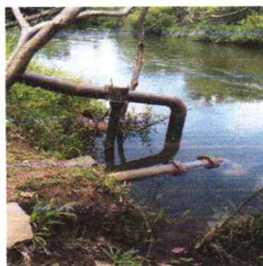
Captação no Rio Itaguari
