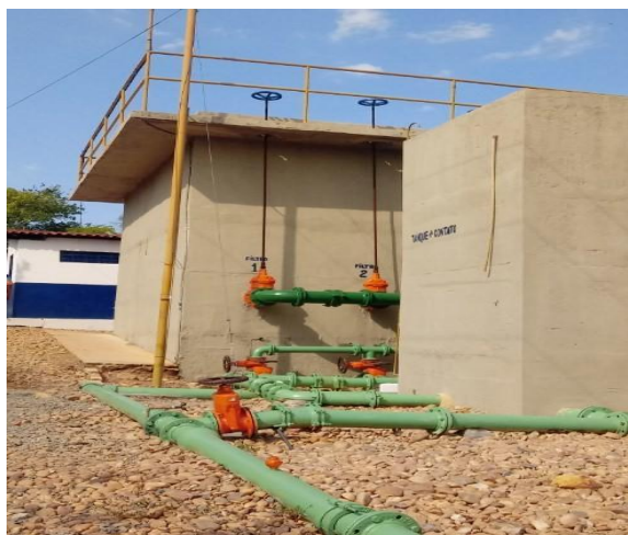
Figura 67 – ETA do Sistema Sede (Urandi)
