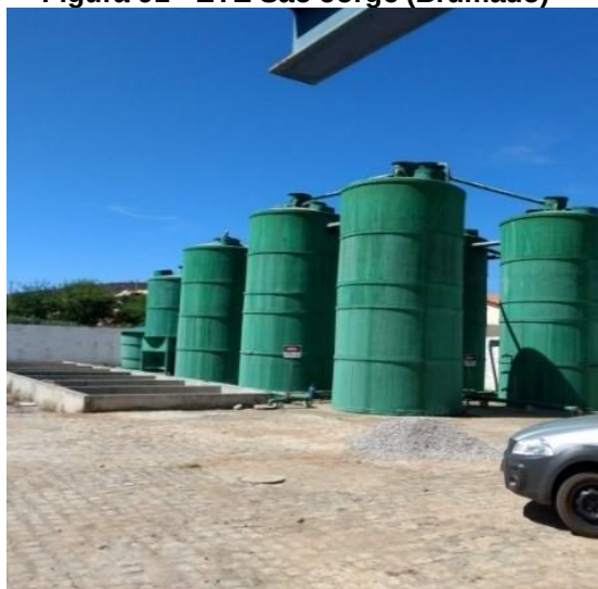
Figura 91 - ETE São Jorge (Brumado)
