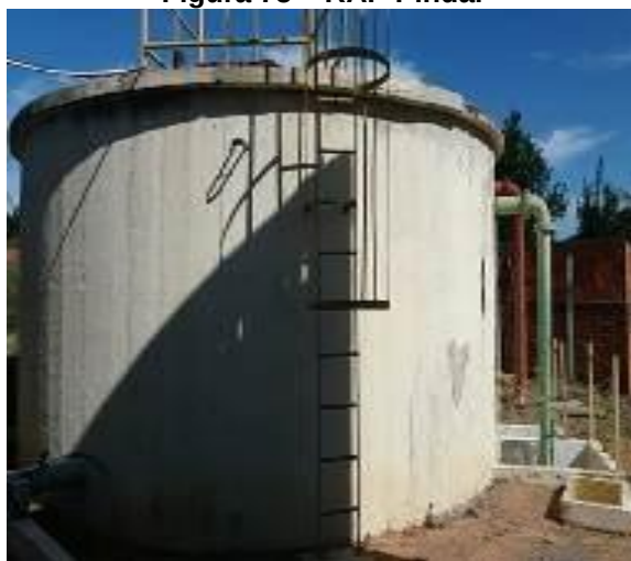
Figura 77 – REL Malhada de Pedras
