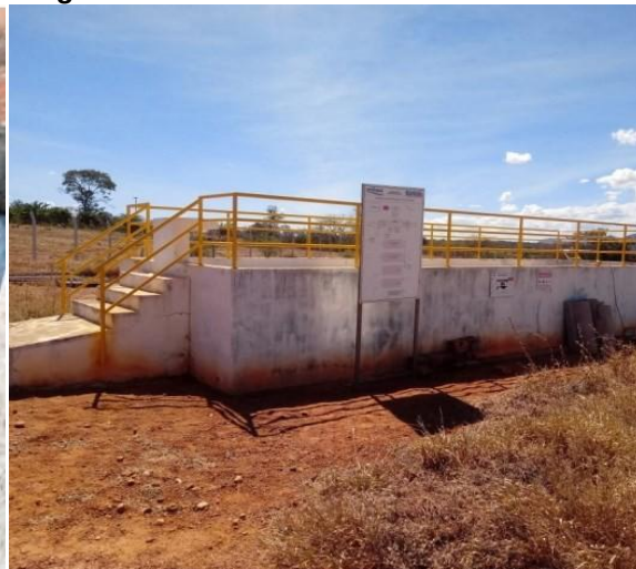
Figura 88 - Caixa de Areia ETE Caturama
