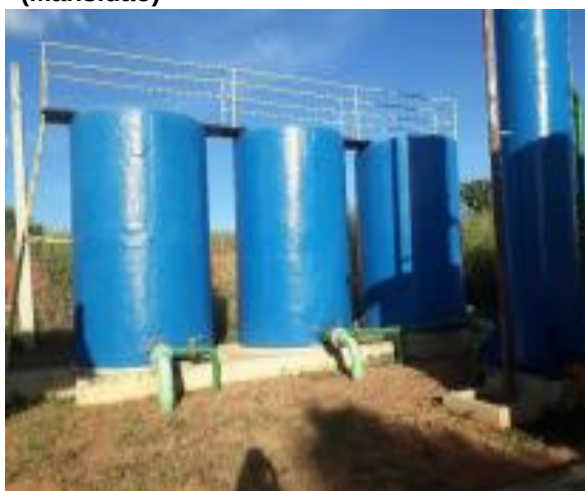
Figura 67 – ETA do Sistema Sede e Aroeiras (Mansidão)
