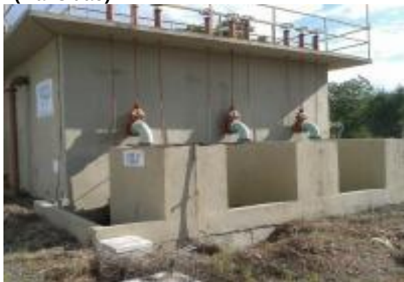
Figura 65 – ETA do Sistema Sede e Aroeiras (Mansidão)
