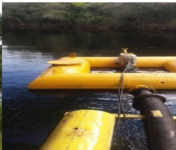
Figura 53 – Captação Iramaia Sede
