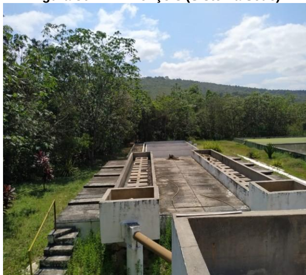
Figura 86 - ETE Lençóis (Sistema Sede)
