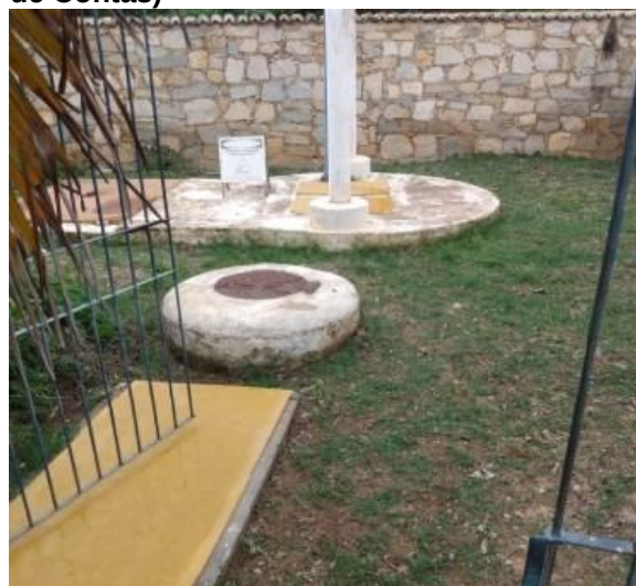
Figura 83 – EEE 02 do Sistema Sede (Rio de Contas)
