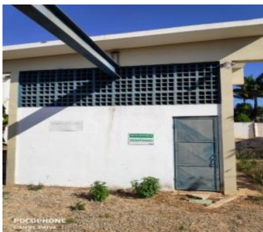
Figura 69 – EEAT (SIAA de Irecê – localizada em Canarana)
