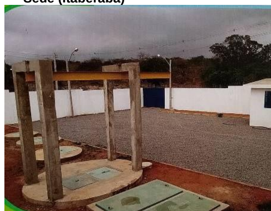
Figura 82 – EEE IT 02 do Sistema Sede (Itaberaba)
