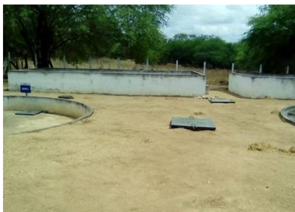
Figura 85 – ETE Ruy Barbosa (Sistema Sede)
