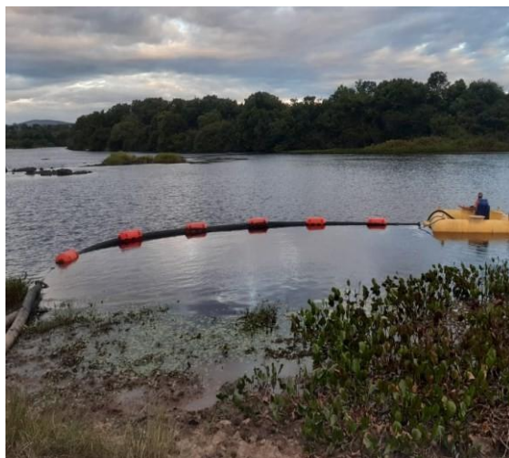
Figura 51 – Captação Boa Vista do Tupim SAA Sede
