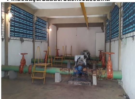
Figura 61 – EEAB2 SAA Pindobaçu/Saúde/Caém/Jacobina
