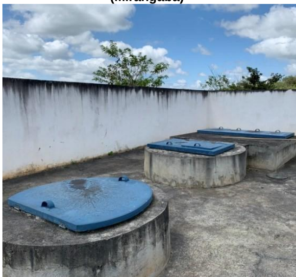
Figura 93 - EEE 02 do Sistema Sede (Mirangaba)
