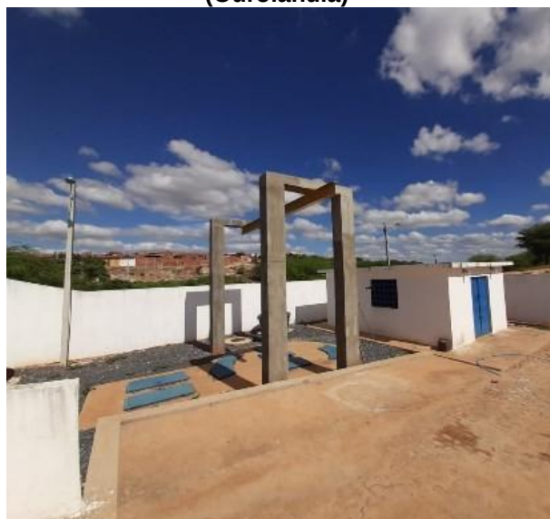
Figura 94 – EEE do Sistema Sede (Ourolândia)
