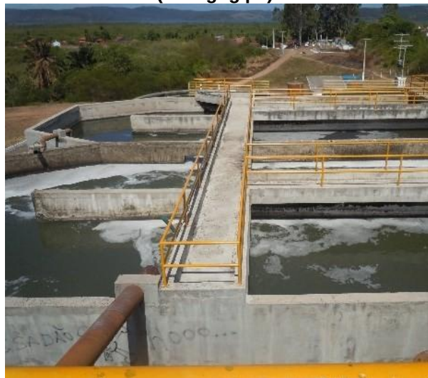
Figura 88 – ETE do Sistema Sede (Maragogipe)
