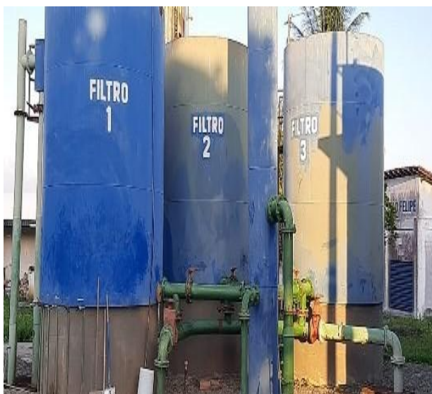
Figura 64 – Filtros ETA São Felipe
