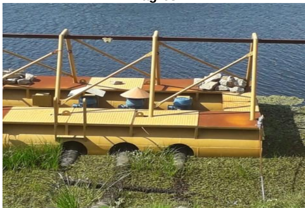
Figura 53 – Flutuante Captação Paraguaçu Milagres
