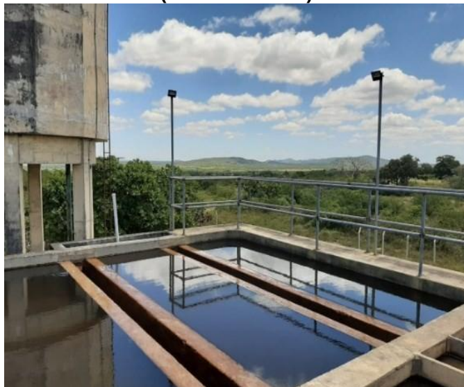
Figura 66 – Decantadores ETA do SAP (Rafael Jambeiro)
