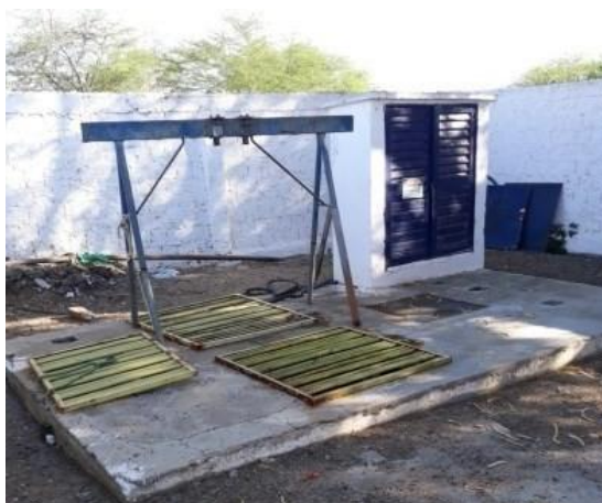
Figura 82 – EEE Quipá – Jaraguari (Sistema Pilar)
