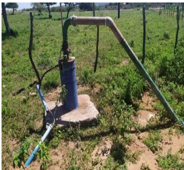
Figura 66– Poço 8 SAA Cipó Sede
