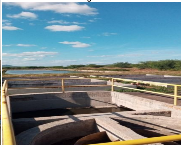
Figura 103 - ETE do Sistema Sede de Santa Brígida
