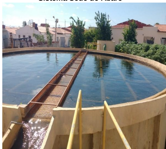
Figura 78 – Decantador da ETA do Sistema Sede de Abaré
