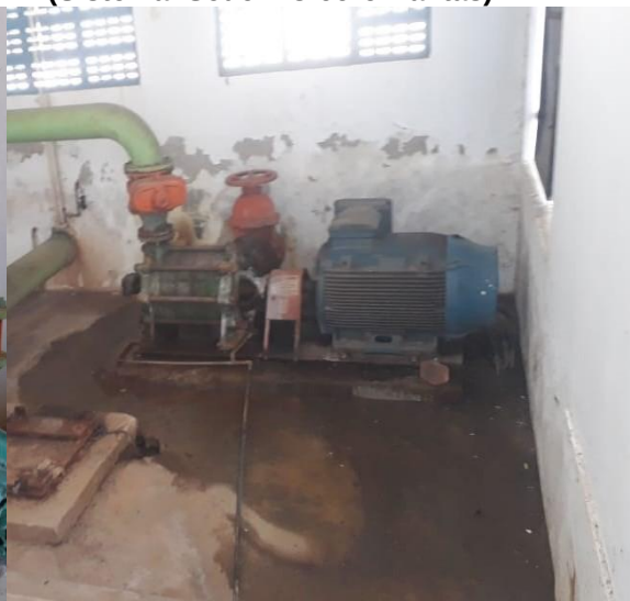
Figura 83– EEAT Lagoa Vermelha (Sistema Sede – Cícero Dantas)
