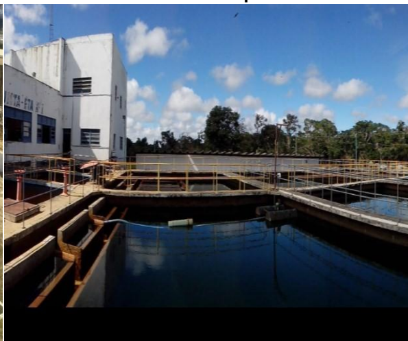
Figura 64 – Decantadores da ETA do SIAA Vitória da Conquista
