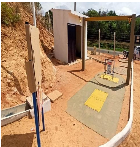
Figura 84 – Vista da Elevatória Final do SES de Jacaraci
