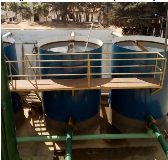
Figura 65 – ETA SBTVCBG (Condeúba)
