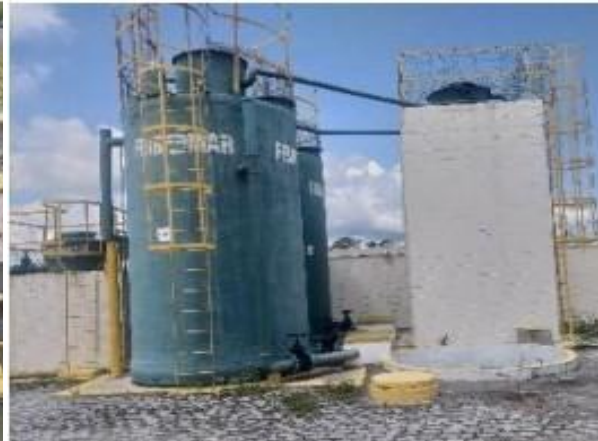
Figura 85 - ETE do Sistema Sede (São Gonçalo dos Campos)
