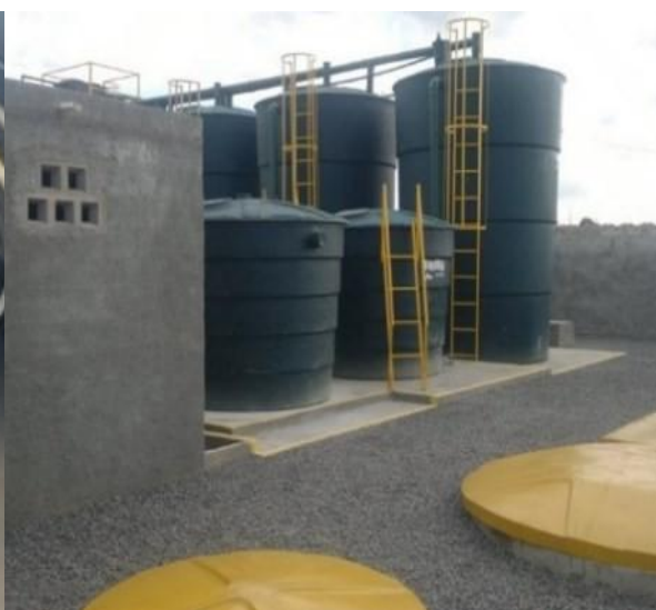
Figura 80 – EEE Parque Viver São Gonçalo do Sistema Povoado Ouro Verde (São Gonçalo dos Campos)
