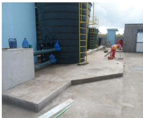
Figura 83 - ETE Vila Esperança do Sistema Sede (Conceição do Jacuípe)
