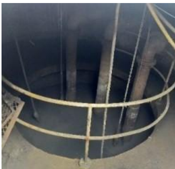
Figura 79 – Vista interna da EEE C do Sistema Sede (Santo Estevão)
