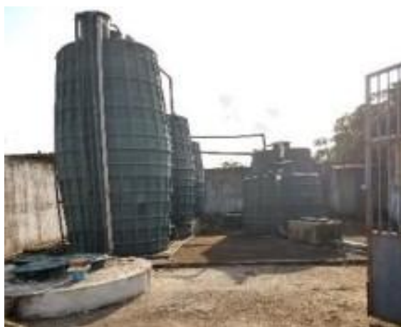
Figura 82 - ETE Recanto do Paraguaçu do Sistema Sede (Conceição da Feira)
