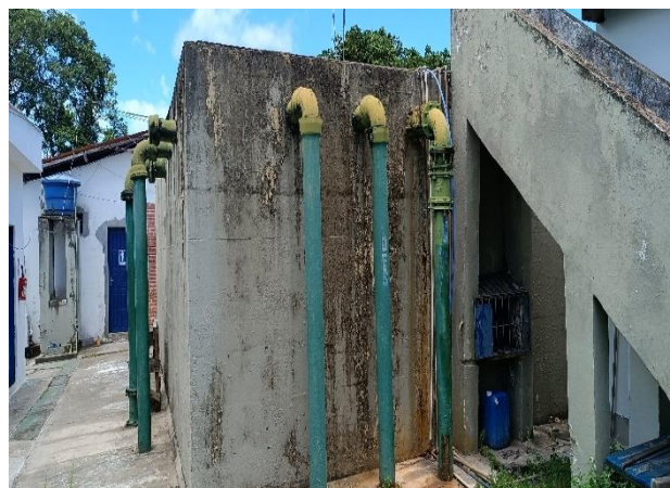
Figura 5.30 - ETA Dias d'Ávila: caixa de Reunião - CR1, chegada dos poços e aplicação dos produtos químicos Fonte: GEOHIDRO (2024).
