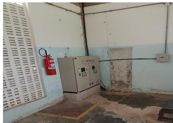
Figura 5.71 - Nova Dias d'Ávila: vista do quadro de comandos da EEAT
