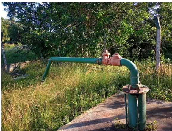
Figura 5.19 - SAA Biribeira: área do poço, proteção com cerca, vista do barrilete Fonte: Embasa (2024).
