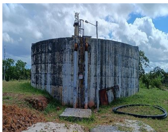
Figura 5.44 - ETA Canta Galo: vista do RAD 1.500m³, chegada da AAB e aplicação de produtos químicos Fonte: GEOHIDRO (2024).
