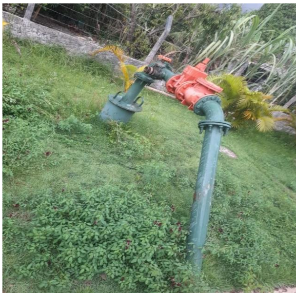
Figura 5.86 - Vista do barrilete do poço de Futurama. Fonte: Embasa (2024).
