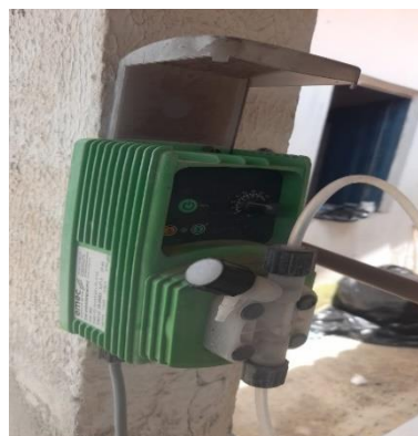
Figura 5.81 - Leandrino CSB1: vista da bomba dosadora da barrilha Fonte: Embasa (2024).
