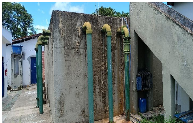
Figura 5.45 - Poço de sucção 158m 3 da EEAT1: vista das tubulações de chegada. Fonte: GEOHIDRO (2024).
