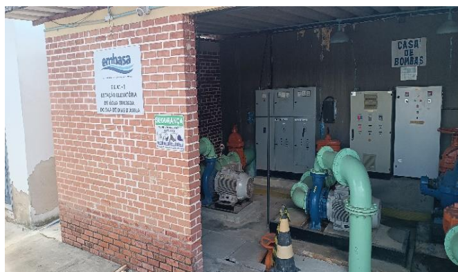
Figura 5.47 - EEAT1: vista dos conjuntos motobombas e quadros de comando Fonte: GEOHIDRO (2024).
