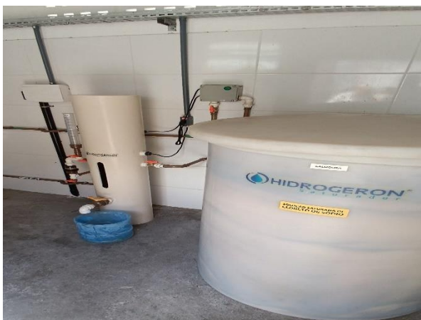
Figura 5.29 - ETA Dias d'Ávila: casa de química e sistema gerador de hipoclorito de sódio, através de cloreto de sódio Fonte: GEOHIDRO (2024).
