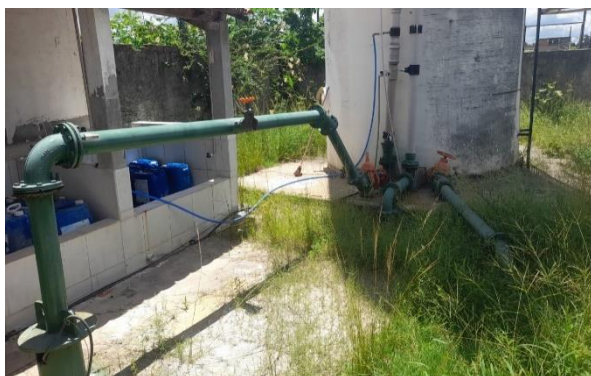
Figura 5.76 - Leandrino CSB 1: vista do barrilete e RAP 100 m 3 ao fundo Fonte: Embasa (2024).
