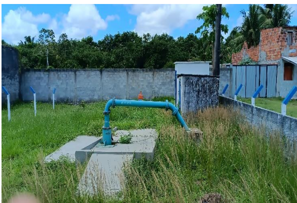
Figura 5.27 - EEAB7A: barrilete da bomba e inexistência de pau de carga Fonte: GEOHIDRO (2024).
