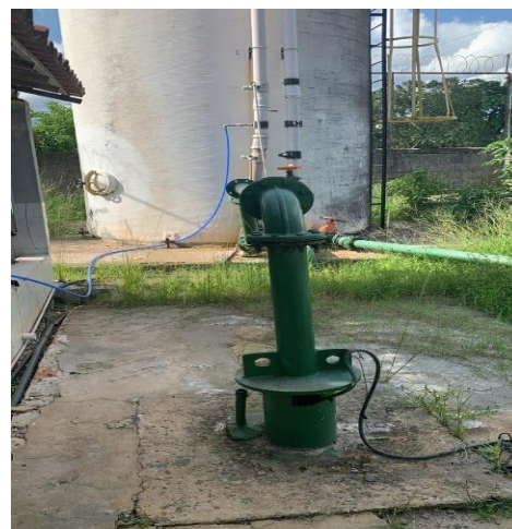
Figura 5.16 - SAA Leandrinho: poço 1 - vista do barrilete e reservatório ao fundo
