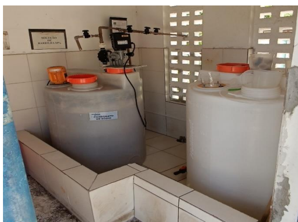
Figura 5.31 - ETA Dias d'Ávila: casa de Química, equipamento de dosagem da Barrilha Fonte: GEOHIDRO (2024).
