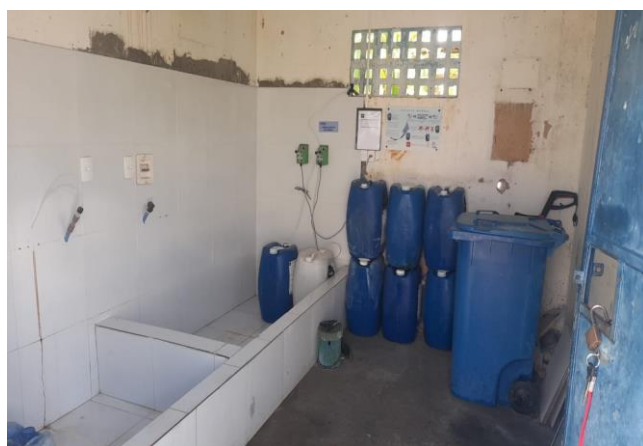
Figura 5.89 - Futurama: vista dos tanques de preparo e bombas dosadoras de hipoclorito Fonte: Embasa (2024).
