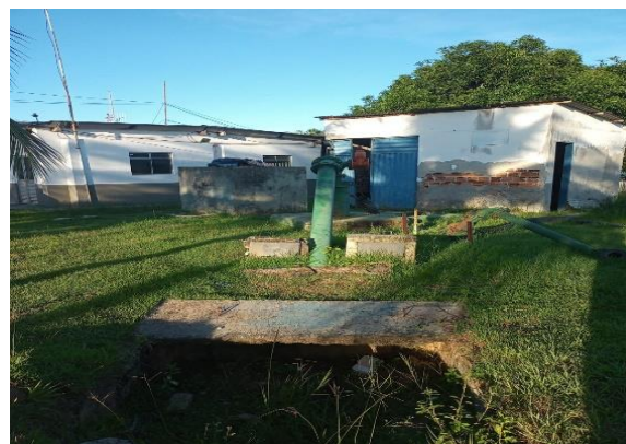
Figura 5.28 - EEAB10: barrilete da bomba e caixa do medidor de vazão, sem tampa Fonte: GEOHIDRO (2024).
