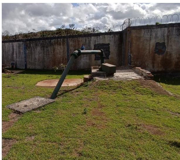
Figura 5.60 - Nova Dias d'Ávila: vista do barrilete da EEAB2, com ausência de pau de carga Fonte: GEOHIDRO (2024).
