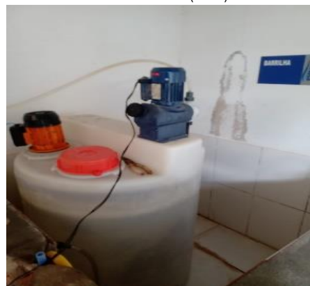
Figura 5.99 - Biribeira: vista dos tanque de preparo, bomba dosadora de barrilha Fonte: Embasa (2024).
