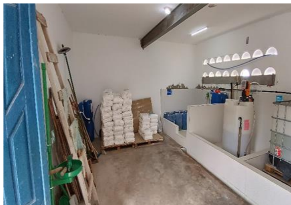
Figura 5.42 - ETA Canta Galo: vista dos tanques de produtos químicos e área de armazenamento Fonte: GEOHIDRO (2024).
