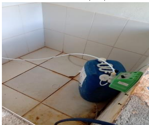
Figura 5.98 - Biribeira: vista da bomba dosadora de hipoclorito Fonte: Embasa (2024).
