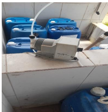
Figura 5.80 - Leandrino CSB1: vista da bomba dosadora do hipoclorito de sódio Fonte: Embasa (2024).
