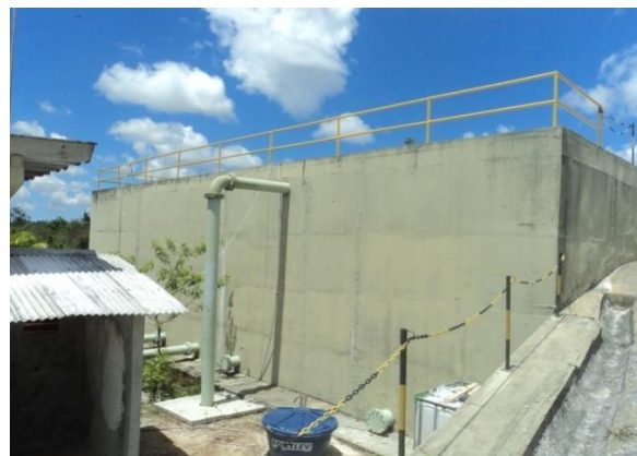
Figura 5.73 - Nova Dias d'Ávila: RAP 900m³, vista dos tubos de extravasão e sucção
