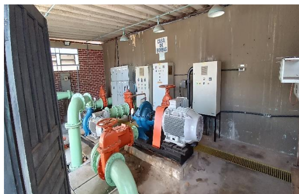
Figura 5.46 - EEAT1: vista das instalações das três bombas Fonte: GEOHIDRO (2024).
