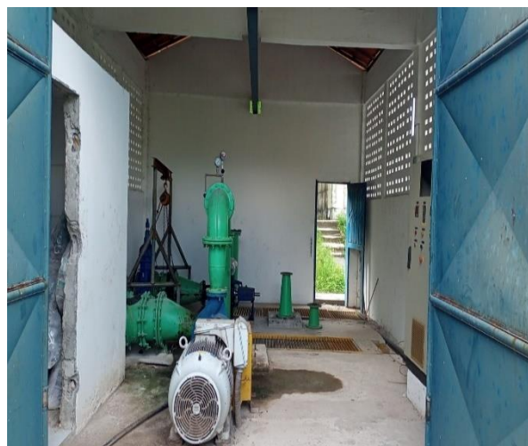
Figura 5.50 - EEAT2: vista das instalações
