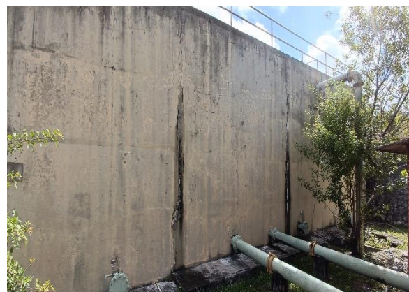
Figura 5.63 - Nova Dias d'Ávila: vista do reservatório Apoiado 900m 3 , chegada AAB2 Fonte: GEOHIDRO (2024).
