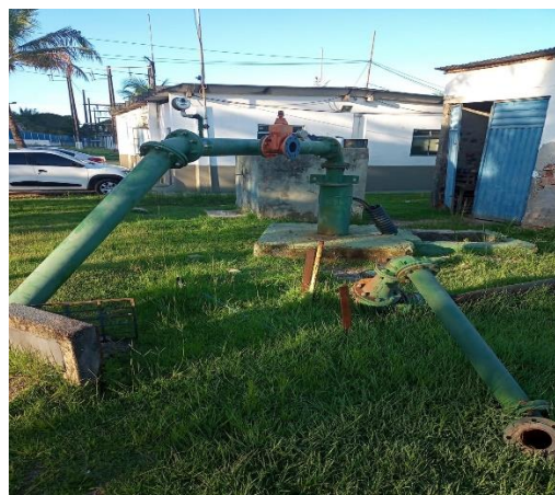
Figura 5.10 - Poço CSB10: proteção e sinalização deficientes
