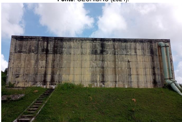
Figura 5.55 - Zonas 1 e 2: vista do RAD1 1.500m 3 e tubulações de entrada Fonte: Embasa (2024).
