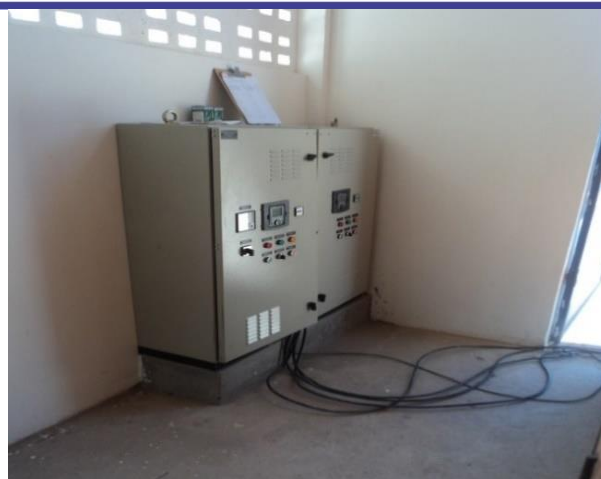
Figura 5.52 - EEAT2: vista das instalações Fonte: Embasa (2024).
