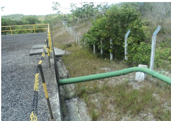
Figura 5.72 - Nova Dias d'Ávila: reservatório apoiado 900 m³-RAP, tubo de chegada no poço
