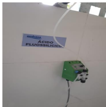
Figura 5.90 - Futurama: vista da bomba dosadora de flúor Fonte: Embasa (2024).
