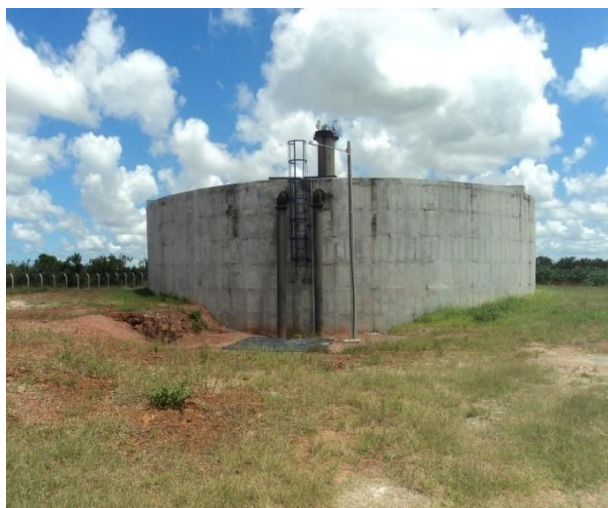
Figura 5.57 - Zona 3: vista do RAD3 1.500 m 3 e tubulações de entrada Fonte: Embasa (2024).
