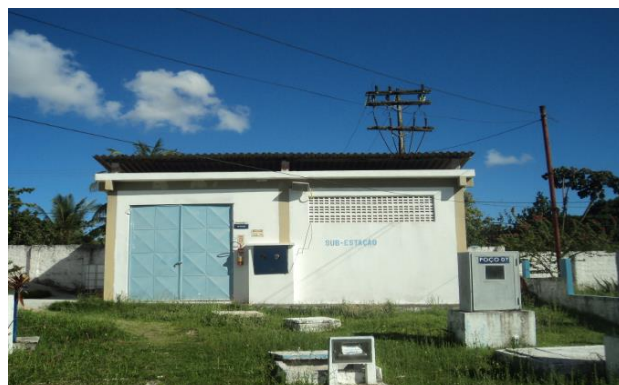
Figura 5.48 - EEAT1: vista da subestação. Fonte: GEOHIDRO (2024).
