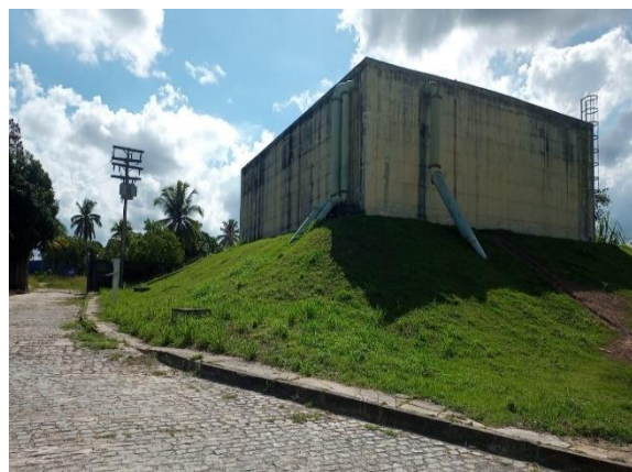
Figura 5.54 - Zonas 1 e 2: vista do RAD1 1.500 m 3 e tubulação de extravasão para RAD2 Fonte: Embasa (2024).
