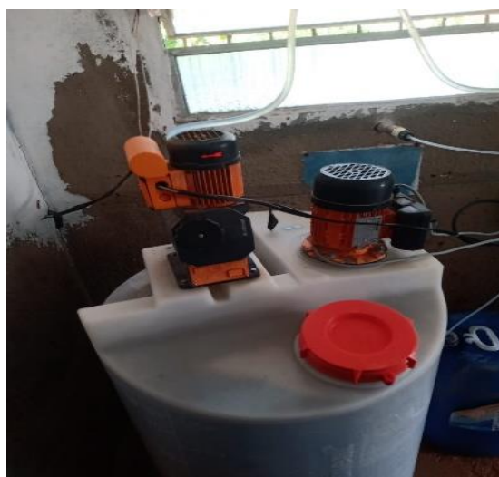
Figura 5.105 - Boa Vista de Santa Helena: vista dos tanques de preparo, bombas dosadora, barrilha Fonte: Embasa (2024).
