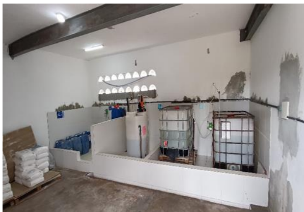
Figura 5.41 - ETA Canta Galo: vista do estrado de armazenamento e tanques de produtos químicos Fonte: GEOHIDRO (2024).
