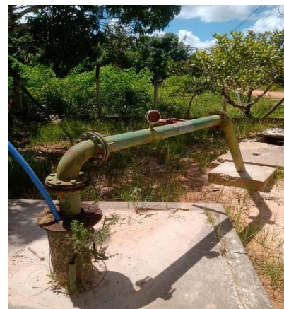
Figura 5.22 - SAA Boa Vista de Santa Helena: vista do barrilete Fonte: Embasa (2024).
