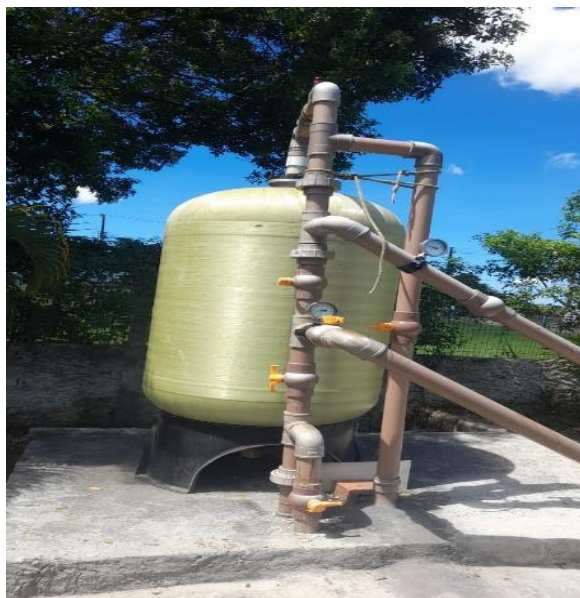
Figura 5.87 - Futurama: vista do filtro com carvão ativado Fonte: Embasa (2024).
