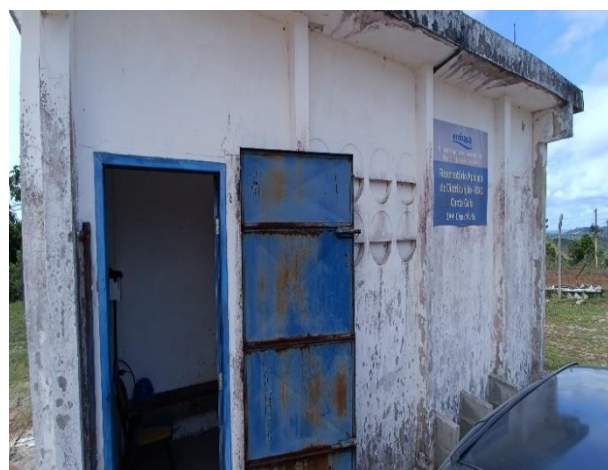
Figura 5.40 - ETA Canta Galo: vista da casa de química e placa com identificação Fonte: GEOHIDRO (2024).
