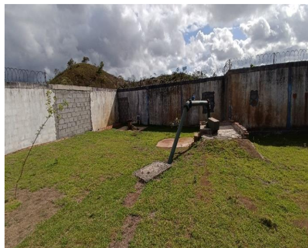
Figura 5.14 - Poço CSB2: vista do barrilete; ausência de pau de carga
