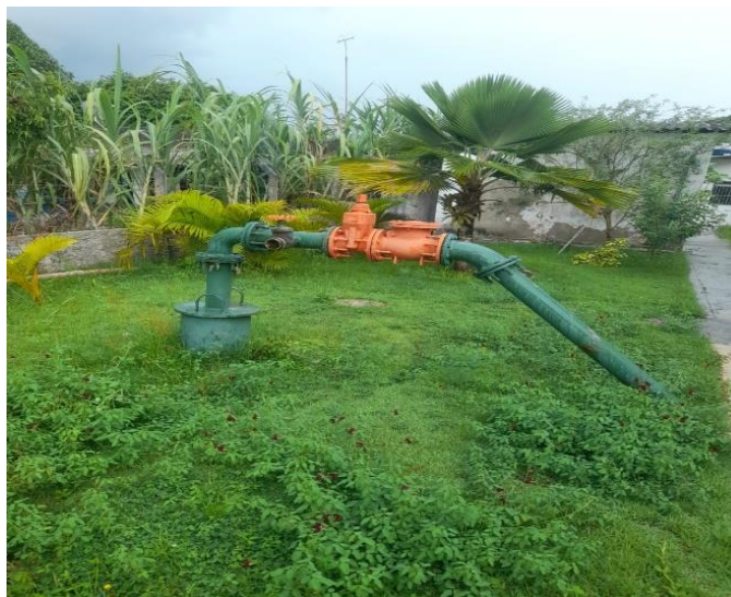
Figura 5.18 - SAA Futurama: vista da área do poço, proteção com cerca e vista do barrilete Fonte: Embasa (2024).
