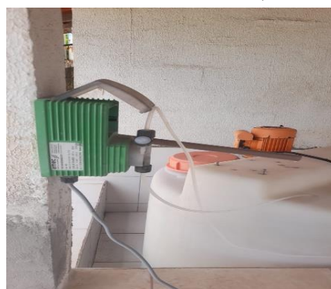
Figura 5.83 - Leandrino CSB2: vista da bomba dosadora da barrilha Fonte: Embasa (2024).
