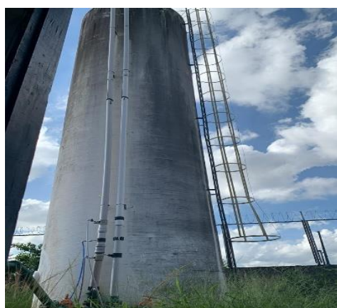
Figura 5.82 - Leandrino CSB1: vista do RAP – tanque de contato Fonte: Embasa (2024).
