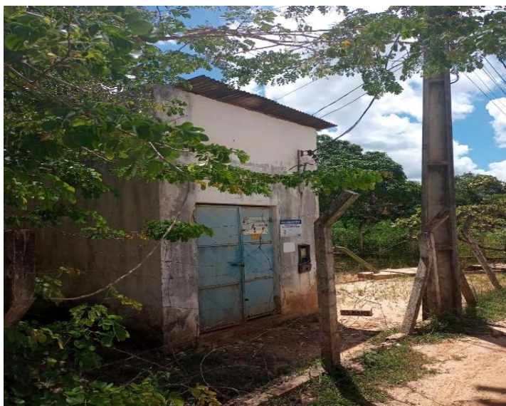
Figura 5.103 - Boa Vista de Santa Helena: vista da casa de química e cerca de proteção, necessitando de reparos. Fonte: Embasa (2024).
