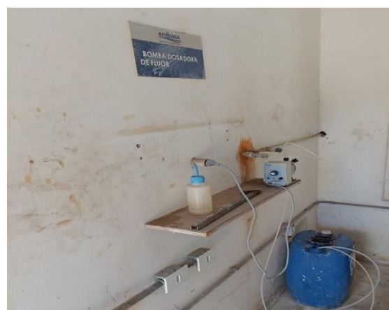
Figura 5.32 - ETA Dias d'Ávila: casa de química, dosagem de Flúor Fonte: GEOHIDRO (2024).
