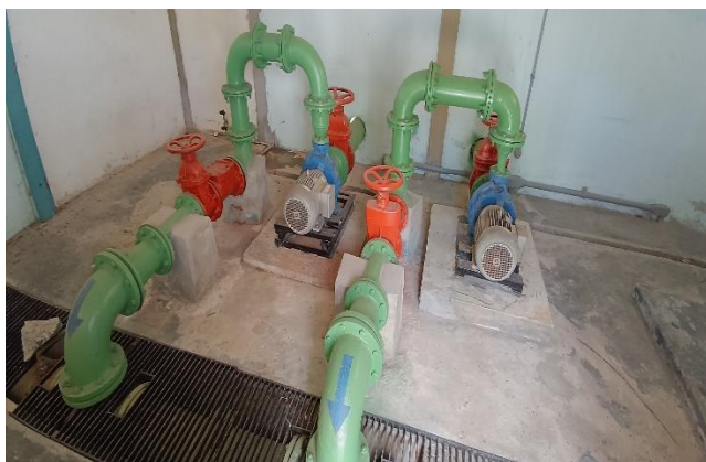
Figura 5.70 - Nova Dias d'Ávila: vista dos conjuntos motobombas da EEAT
