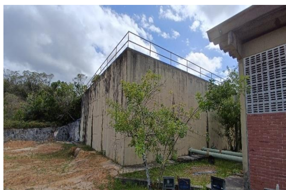
Figura 5.69 - Nova Dias d'Ávila: vista reservatório apoiado 900 m 3 e tubos de sucção da EEAT Fonte: GEOHIDRO (2024).
