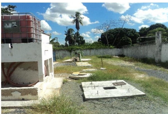
Figura 5.25 - EEAB8: vista do barrilete ao fundo e caixa do medidor de vazão Fonte: GEOHIDRO (2024).
