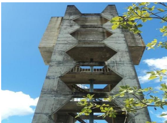
Figura 5.53 - Reservatório elevado de distribuição - RED 400 m 3 : Desativado - a ser demolido Fonte: GEOHIDRO (2024).
