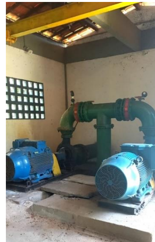
Figura 6.10 - Conjuntos motobomba da EEAB2 Fonte: GEOHIDRO (2024).
