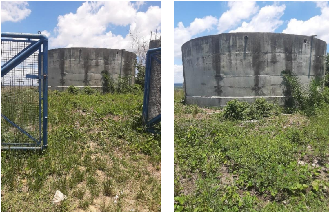
Figura 2.76 - Reservatório Apoiado de Gurugê
