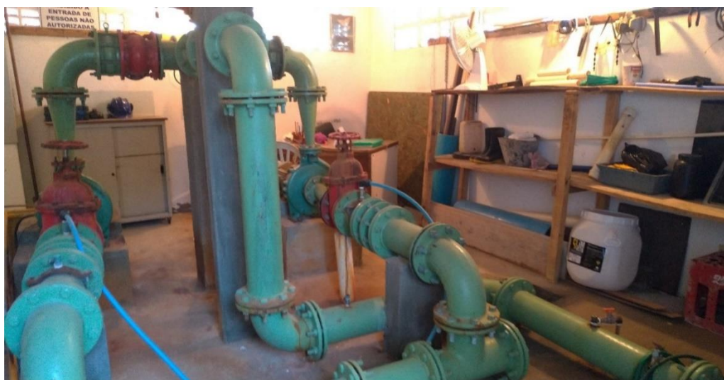
Figura 2.58 - Conjuntos Motobombas da EEAT de Bom Jesus dos Passos
