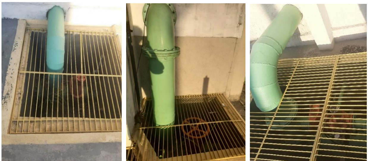
Figura 2.33 - Tubulações de saída do RZB-II Fonte: GEOHIDRO (2024).
