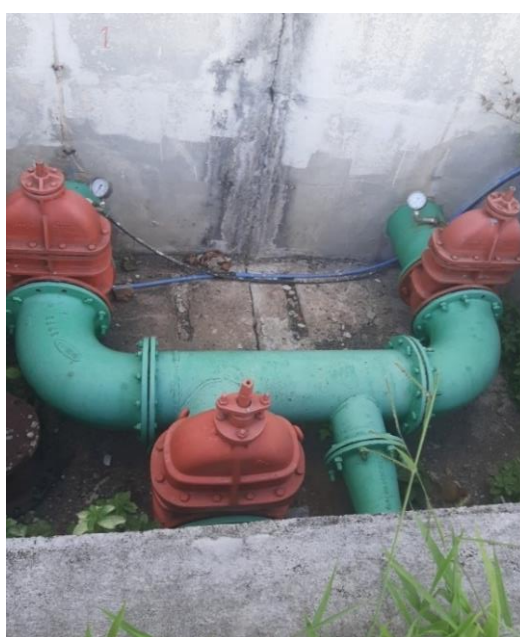
Figura 2.38 - Tubulações de entrada do RZM
