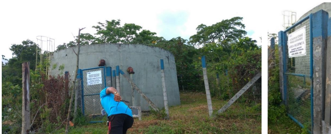
Figura 2.47 - Área do Reservatório Apoiado de Praia Grande
