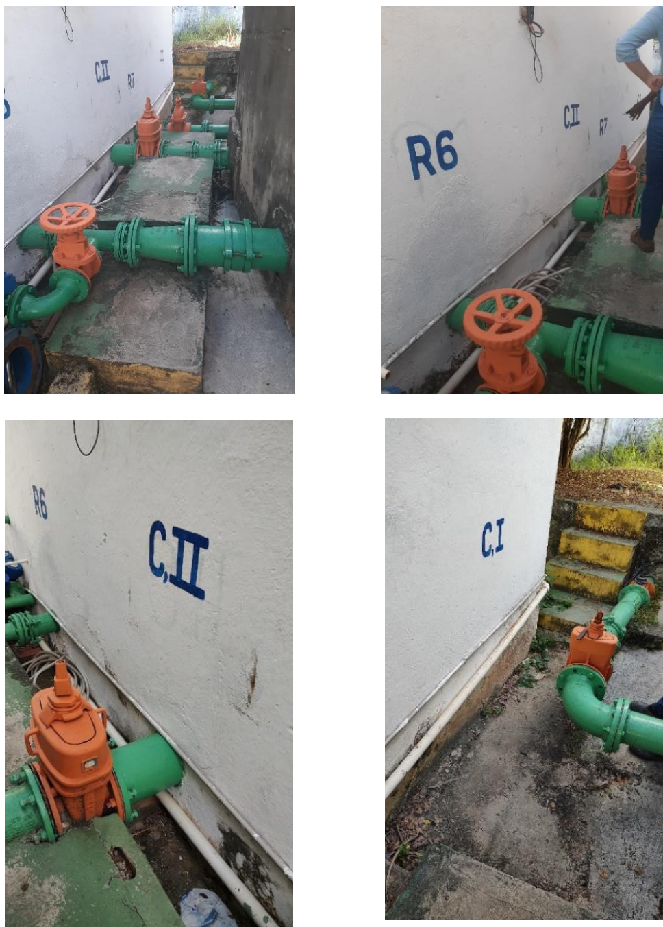
Figura 2.41 - Tubulações de Saída do Reservatório Apoiado R5
