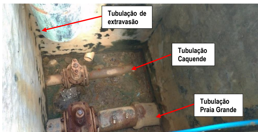
Figura 2.49 - Tubulações de saída do Reservatório Apoiado de Praia Grande
