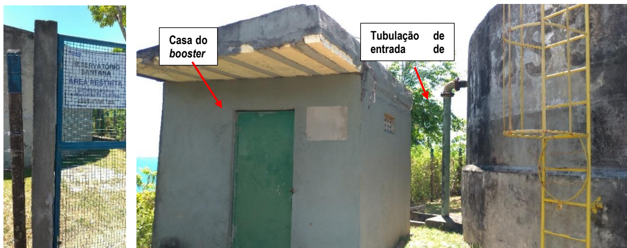
Figura 2.45 - Reservatório Apoiado de Santana das Neves
