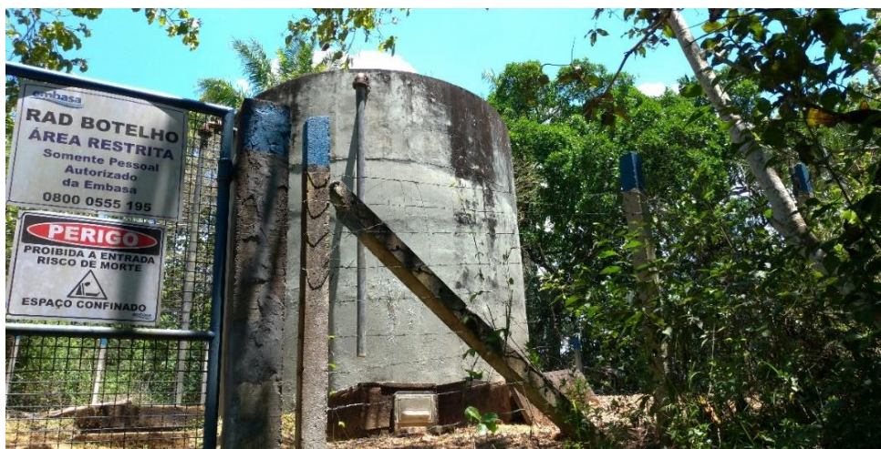
Figura 2.50 - Reservatório de Botelho
