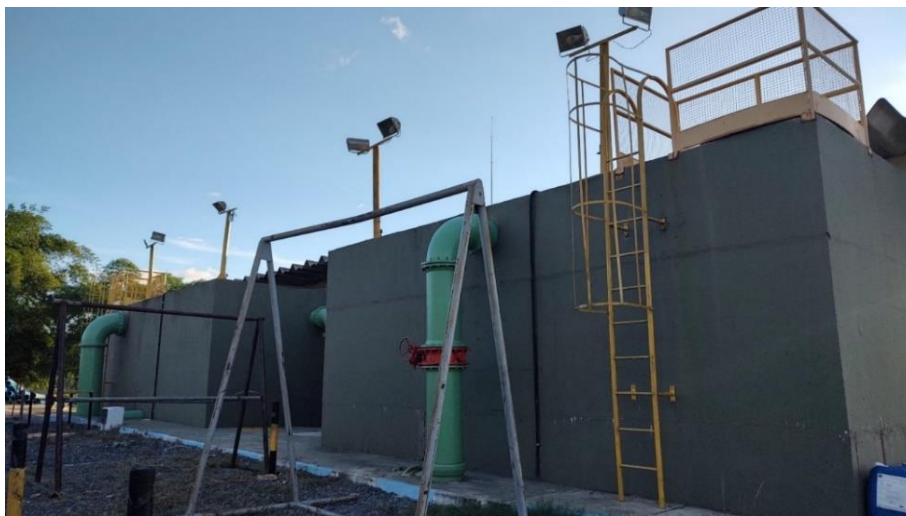
Figura 2.35 - Reservatórios Apoiados de 75 m 3 , localizados na área do RZB-II Fonte: GEOHIDRO (2024).
