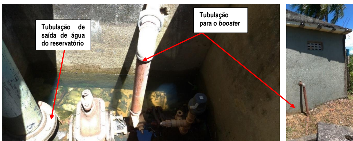
Figura 2.46 - Tubulações de Saída do Reservatório Apoiado de Santana das Neves
