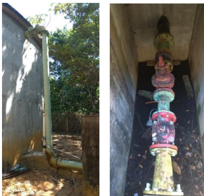
Figura 2.66 - Tubulação de chegada da água
