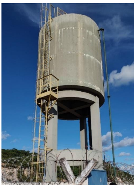
Figura 2.12 - Reservatório Elevado Fazenda Mamão
