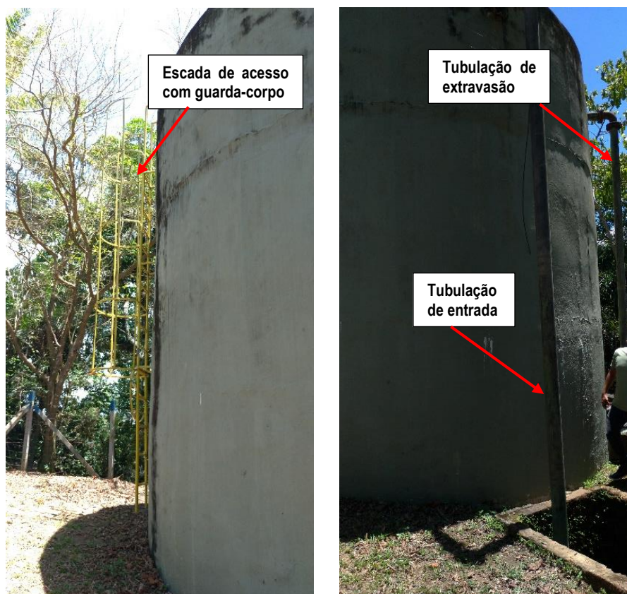
Figura 2.51 - Escada de acesso, tubulação de entrada e extravasor do RAD de Botelho
