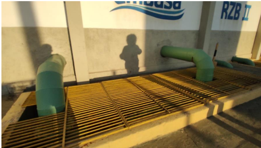
Figura 2.32 - Tubulações de saída do RZB-II Fonte: GEOHIDRO (2024).
