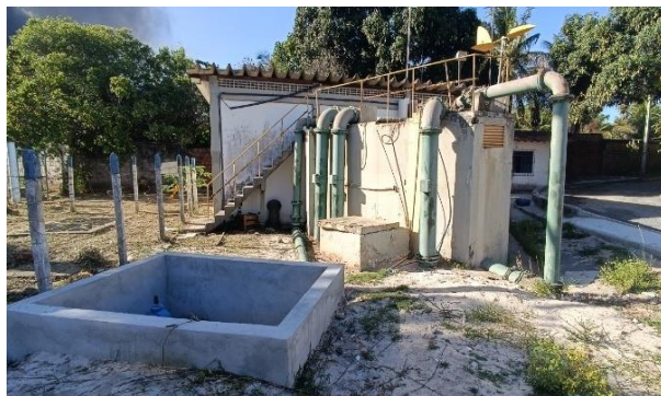
Figura 4.42 - Caixa de reunião com capacidade de 50 m 3 localizado na zona Alpha (a ser desativada) Fonte: GEOHIDRO (2024).
