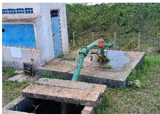
Figura 4.208 - Poço CSB6 Fonte: GEOHIDRO (2024).
