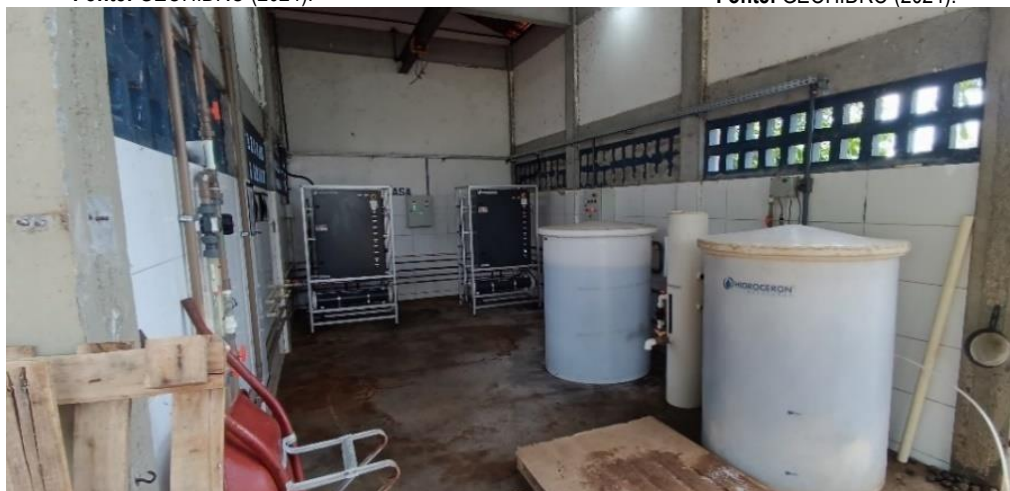
Figura 4.223 - Sistema Hidrogeron gerador de hipoclorito de sódio in loco (vista 1)
