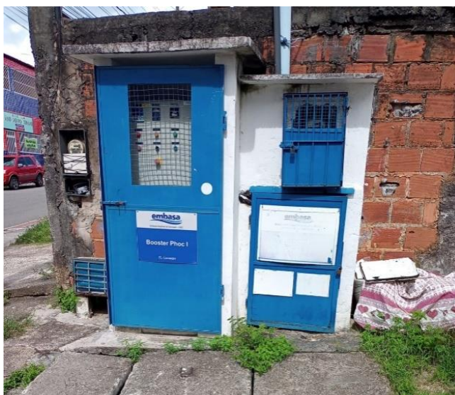
Figura 4.84 - Estrutura de abrigo do booster Phoc I Fonte: Embasa (2024).
