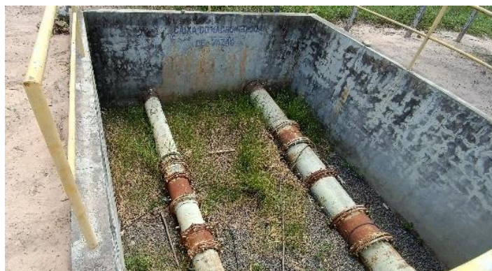
Figura 4.210 - Caixa de medição da ETA Fonte: GEOHIDRO (2024).
