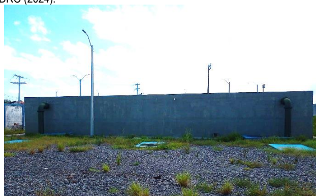
Figura 4.96 - RAD 1500 zona estádio - previsto para entrar em operação em meados de 2024 Fonte: Embasa (2024).
