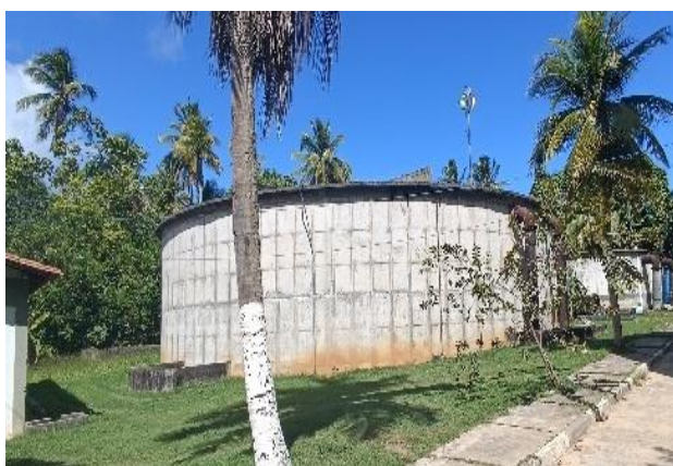
Figura 4.235 - RAD 1500 - Centro de Reservação
