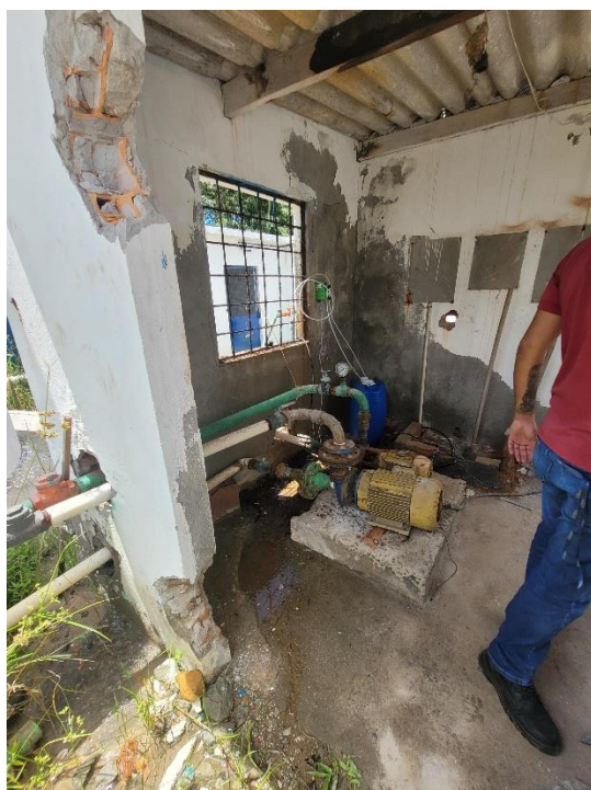
Figura 4.260 - EEAT1 Fonte: Embasa (2024).
