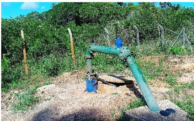
Figura 4.157 - Poço CSB5 do SAA Machadinho Norte Fonte: GEOHIDRO (2024).
