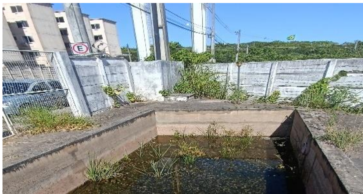
Figura 4.64 - Tanque de descarte de lodo da ETA Terra Brasilis Fonte: GEOHIDRO (2024).
