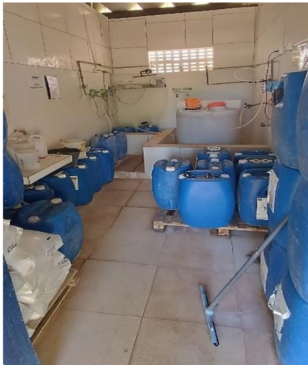
Figura 4.249 - Depósito de produtos químicos da ETA do SAA Parafuso Fonte: GEOHIDRO (2024).
