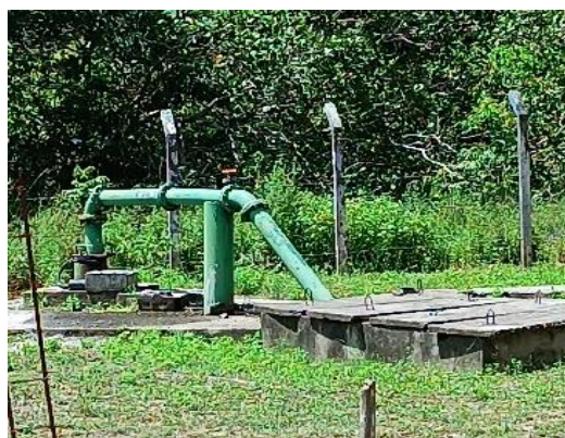
Figura 4.205 - Poço CSB2 Fonte: GEOHIDRO (2024).
