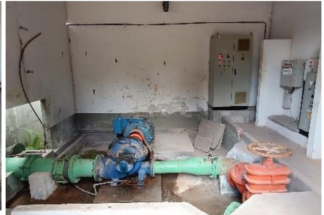
Figura 4.230 - Conjunto motobomba EEAT1 Fonte: GEOHIDRO (2024).
