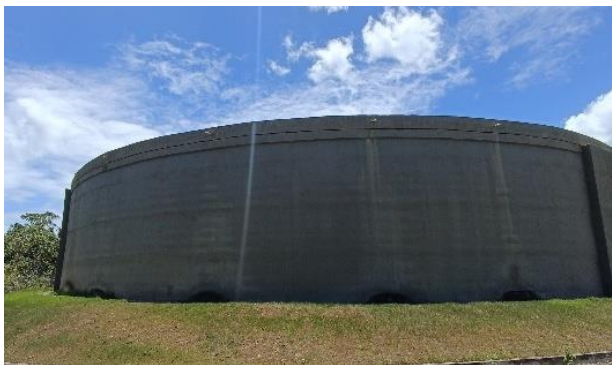
Figura 4.143 - RAD 4000 Fonte: GEOHIDRO (2024).
