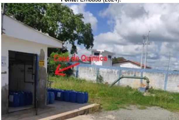
Figura 4.58 - Sistema de tratamento do poço CSB13 Fonte: Embasa (2024).
