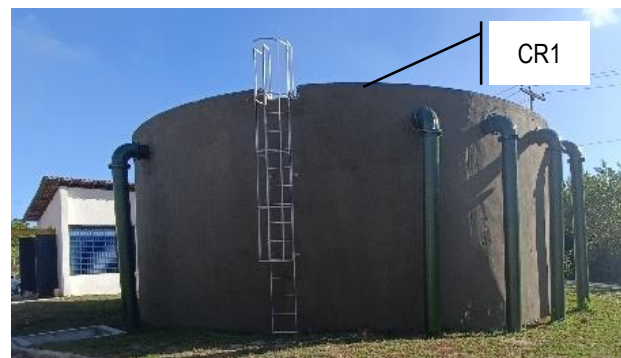
Figura 4.43 - Nova CR1 (Caixa de reunião 1) de 600 m 3 localizada na zona Alpha (previsão para entrar em operação em abril/2024) Fonte: GEOHIDRO (2024).
