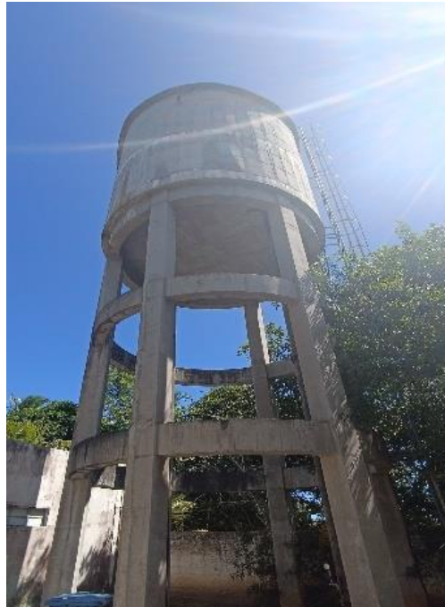
Figura 4.237 - RED 150 – Centro de Reservação Fonte: GEOHIDRO (2024).
