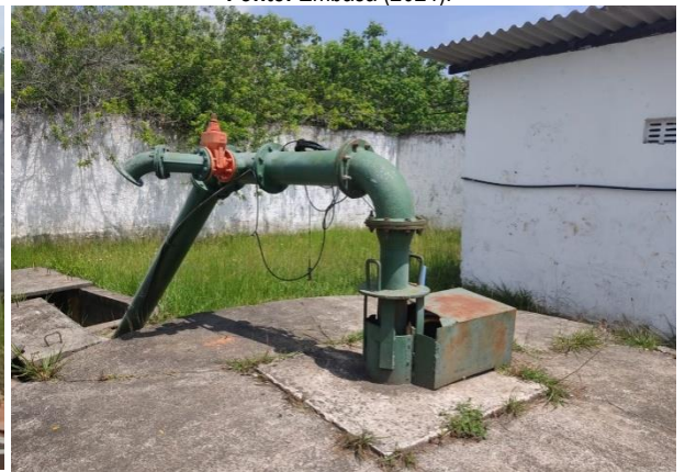
Figura 4.26 - Poço CSB6, localizado na zona Alpha Fonte: Embasa (2024).
