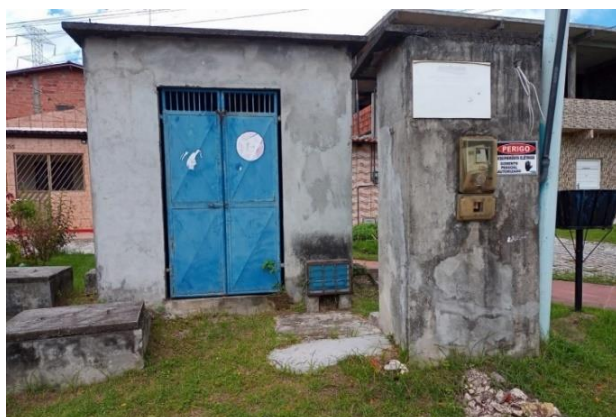
Figura 4.74 - Estrutura de abrigo do booster Alto da Guiné Fonte: Embasa (2024).
