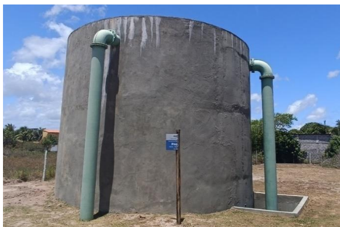
Figura 4.121 - Caixa de reunião instalada no mesmo local do poço CSB7, a ser colocada em operação Fonte: GEOHIDRO (2024).
