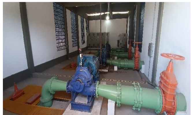
Figura 4.135 - EEAT1 Machadinho Sul - Equipamentos Fonte: GEOHIDRO (2024).
