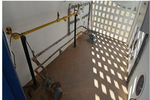
Figura 4.166 - Bombas dosadoras de cloro gás Fonte: GEOHIDRO (2024).
