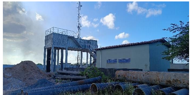
Figura 4.93 - CR3 Caixa de reunião de água bruta, localizada no Morro da Manteiga Fonte: GEOHIDRO (2024).
