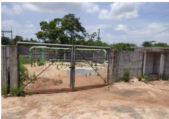
Figura 4.13 - Entrada do poço CSB 9 (Manteiga IV) Fonte: Embasa (2024).
