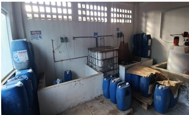
Figura 4.167 - Casa de Química - Dosadores de flúor, hipoclorito e Barrilha Fonte: GEOHIDRO (2024).
