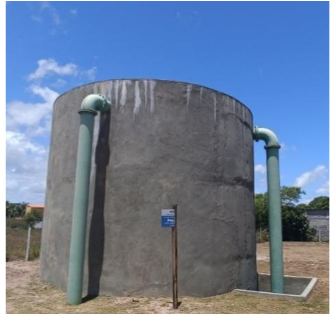
Figura 4.139 - CR1 - Caixa de Reunião (próximo ao poço CSB 7) Fonte: GEOHIDRO (2024).
