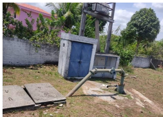
Figura 4.111 - Área do poço 10 Fonte: GEOHIDRO (2024).
