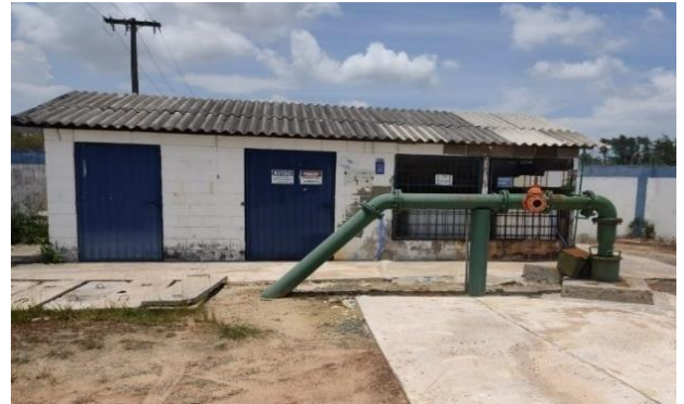
Figura 4.30 - Poço CSB10 localizado no bairro Parque das Palmeiras Fonte: Embasa (2024).
