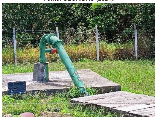
Figura 4.206 - Poço CSB3 Fonte: GEOHIDRO (2024).
