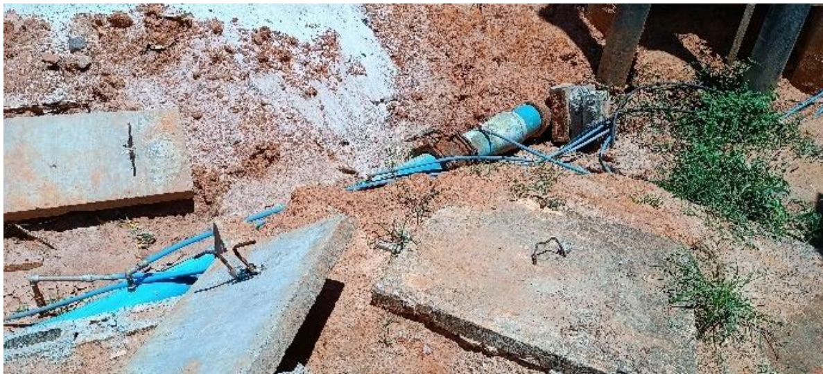
Figura 4.189 - Aplicação dos produtos diretamente na linha adutora Fonte: GEOHIDRO (2024).
