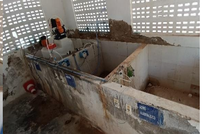
Figura 4.222 - Local de instalação das bombas dosadoras
