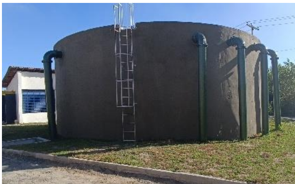
Figura 4.94 - CR1 - Poço de sucção e caixa de reunião zona Alpha RAD 600 m 3 , previsto para entrar em operação em meados de 2024 Fonte: GEOHIDRO (2024).
