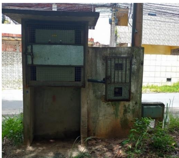
Figura 4.88 - Estrutura de abrigo do booster Parque Satélite Fonte: Embasa (2024).
