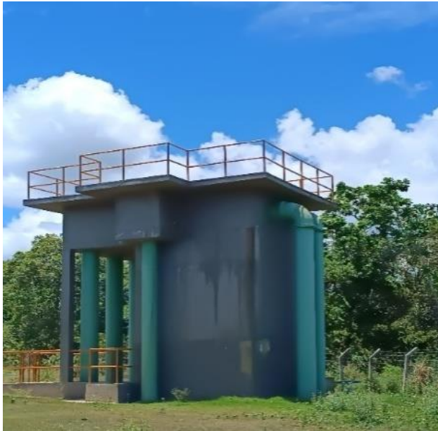
Figura 4.138 - CRD - Caixa de Reunião do Centro de Reservação Fonte: GEOHIDRO (2024).
