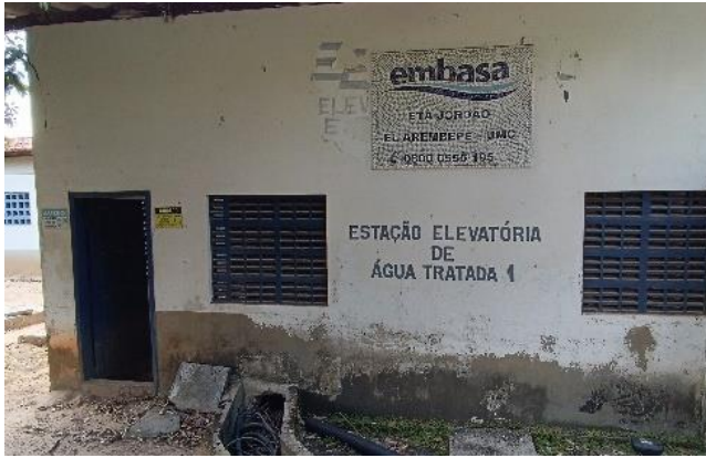
Figura 4.229 - Entrada EEAT1 Fonte: GEOHIDRO (2024).
