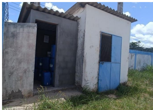
Figura 4.57 - Sistema de tratamento do poço CSB12 Fonte: Embasa (2024).
