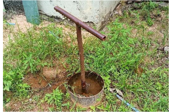
Figura 4.217 - Registro de Manobra Fonte: GEOHIDRO (2024).
