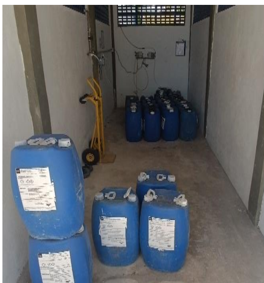
Figura 4.129 - Dosagem Fluor e Hipoclorito de sódio da ETA Machadinho Sul Fonte: GEOHIDRO (2024).
