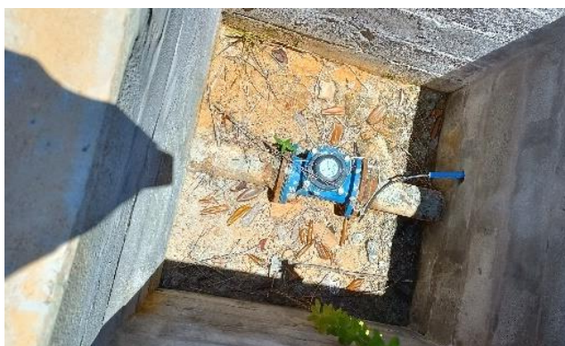
Figura 4.183 - Macro medidor do poço CSB1 Fonte: GEOHIDRO (2024).
