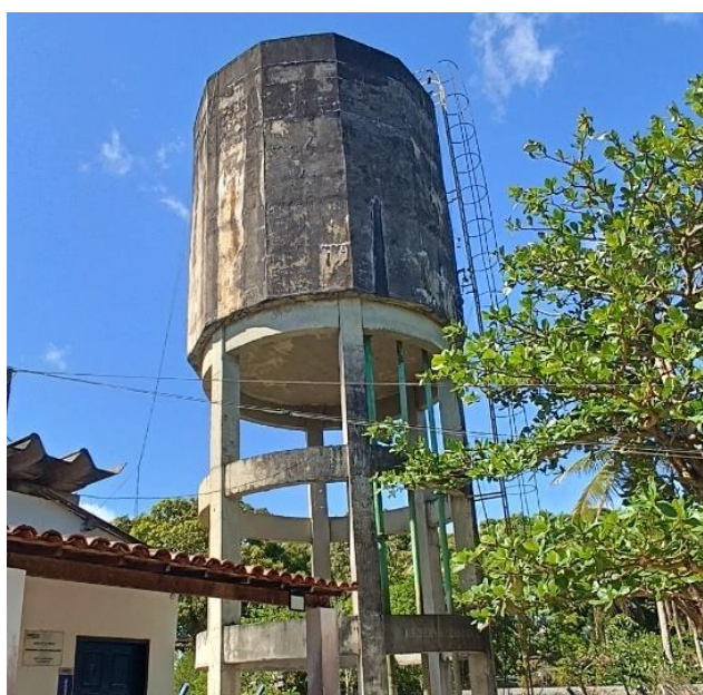
Figura 4.251 - Reservatório elevado de distribuição (150 m 3 ) do SAA Parafuso
