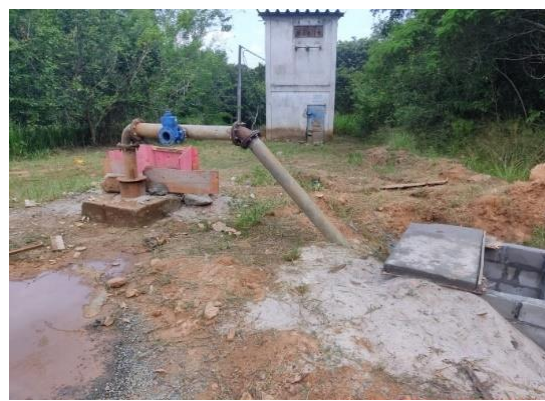
Figura 4.120 - Poço CSB12 Fonte: GEOHIDRO (2024).
