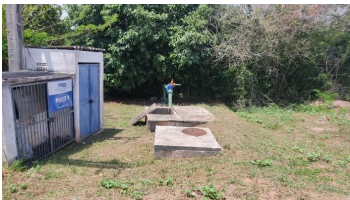
Figura 4.110 - Área do poço 9 Fonte: GEOHIDRO (2024).
