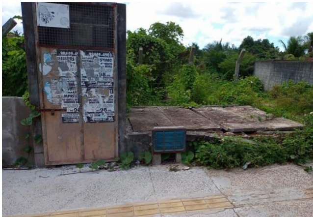
Figura 4.82 - Estrutura de abrigo do booster Parque Verde II Fonte: Embasa (2024).
