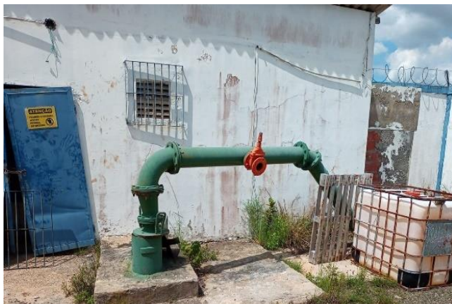
Figura 4.31 - Poço URCA (CSB11), localizado na zona Estádio Fonte: Embasa (2024).
