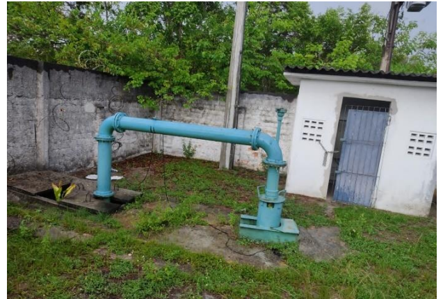
Figura 4.22 - Poço CSB2 localizado na zona Alpha Fonte: Embasa (2024).
