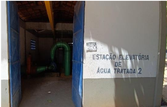
Figura 4.231 - Entrada EEAT1A Fonte: GEOHIDRO (2024).
