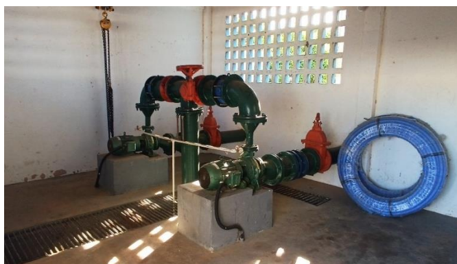
Figura 4.170 - Conjuntos motobomba da elevatória de água tratada do SAA Machadinho Norte Fonte: GEOHIDRO (2024).
