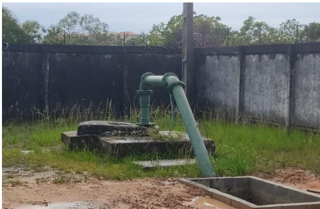
Figura 4.25 - Poço CSB5 localizado na zona Alpha Fonte: Embasa (2024).
