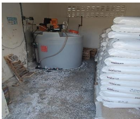
Figura 4.47 - ETA Alpha - Dosador e estoque de barrilha Fonte: GEOHIDRO (2024).
