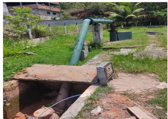
Figura 4.116 - Poço CSB6 Fonte: GEOHIDRO (2024).
