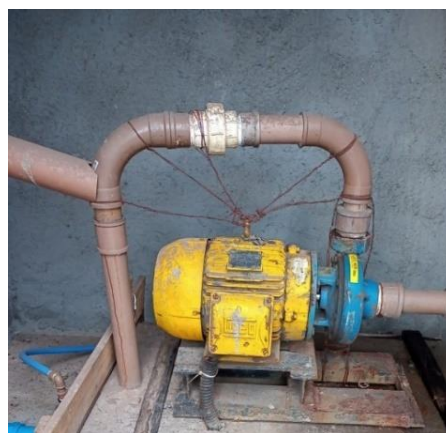
Figura 4.75 - Booster Alto da Guiné Fonte: Embasa (2024).
