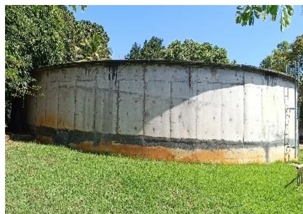
Figura 4.236 - RAD 1500 - Centro de Reservação
