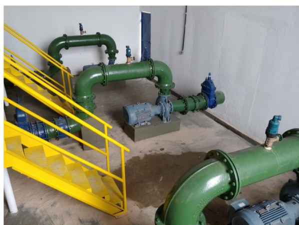
Conjuntos Motobombas da EEAT-1
