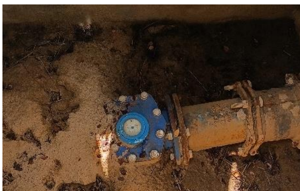
Figura 4.211 - Medidor de vazão do poço CSB4 Fonte: GEOHIDRO (2024).
