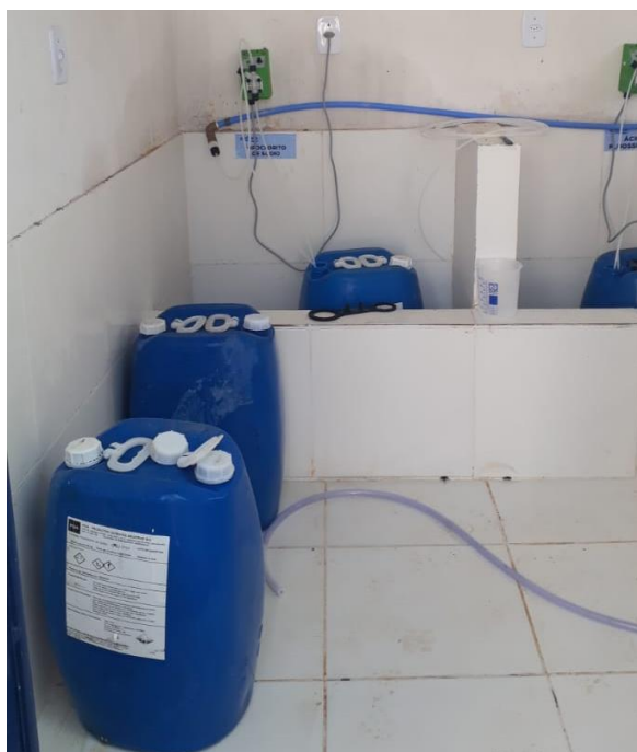
Figura 4.258 - Interior da casa de química Fonte: Embasa (2024).
