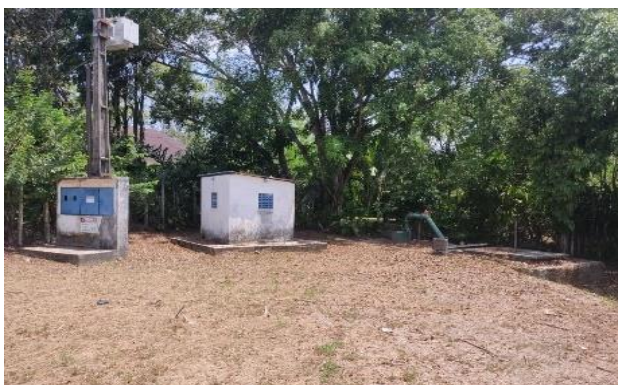
Figura 4.117 - Poço CSB7 Fonte: GEOHIDRO (2024).
