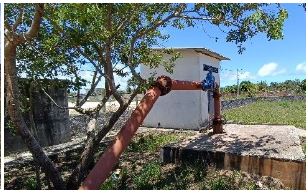
Figura 4.182 - Poço CSB2 Fonte: GEOHIDRO (2024).
