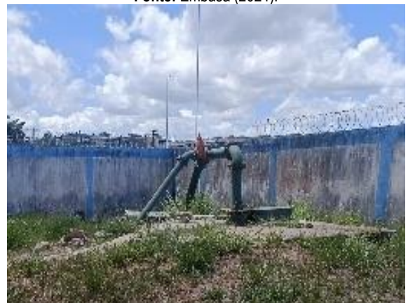
Figura 4.32 - Poço CSB12 - Alpha V, localizado na zona Estádio Fonte: GEOHIDRO (2024).
