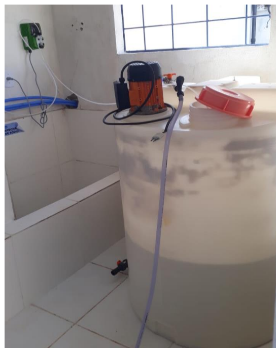
Figura 4.259 – Interior da Casa de química Fonte: Embasa (2024).
