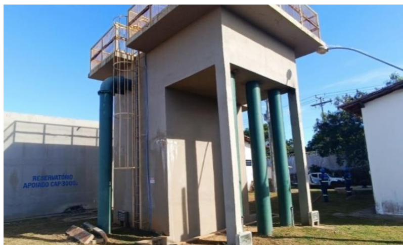
Figura 4.164 - Caixa de reunião 2 - CR2 - situada na área da ETA
