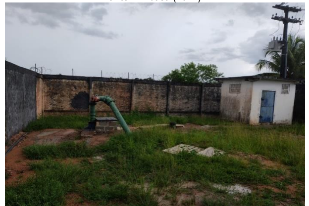
Figura 4.24 - Poço CSB4A localizado na zona Alpha Fonte: Embasa (2024).
