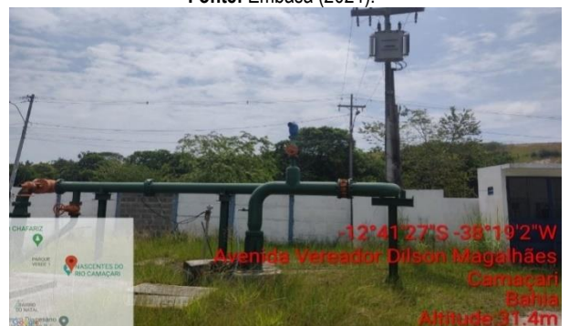
Figura 4.28 - Poço CSB8, localizado na zona Alpha Fonte: Embasa (2024).
