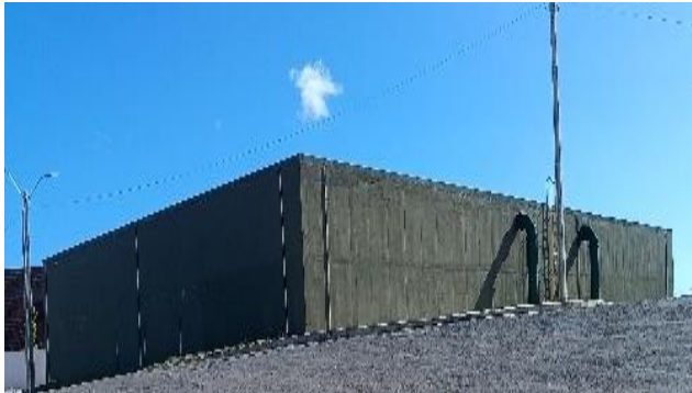
Figura 4.90 - Reservação zona Estádio - RAD 4000 m 3 Fonte: GEOHIDRO (2024).
