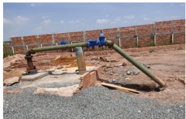
Figura 4.118 - Poço CSB8 Fonte: GEOHIDRO (2024).
