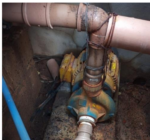
Figura 4.89 - Booster Parque Satélite Fonte: Embasa (2024).
