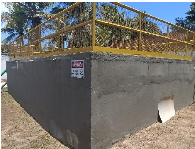
Figura 4.140 - RAD160 1 da ETA Fonte: GEOHIDRO (2024).
