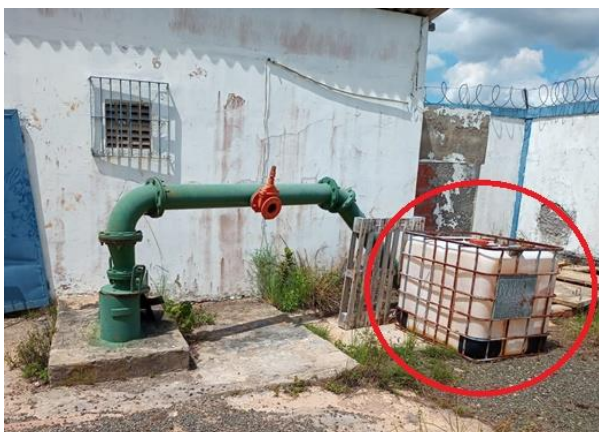
Figura 4.56 - Sistema de tratamento no poço CSB11 – Urca Fonte: Embasa (2024).
