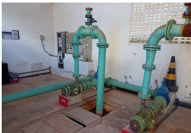
Figura 4.73 - EEAT Terra Brasilis Fonte: Embasa (2024).
