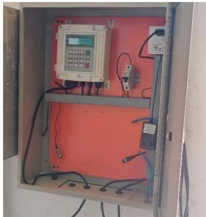
Figura 4.136 - Medidor de vazão ultrassônico
