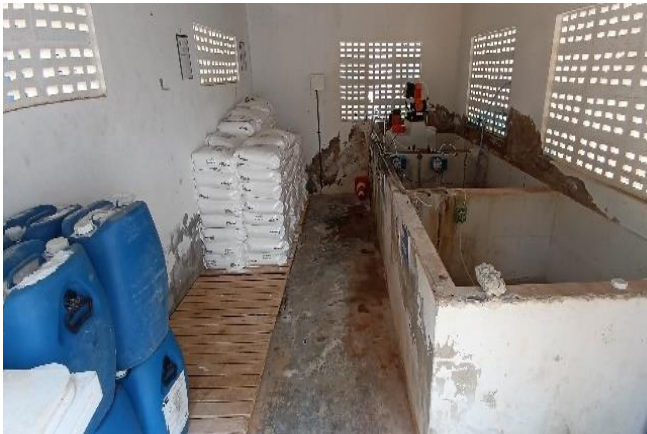
Figura 4.221 - Visão ampla do interior da casa de química
