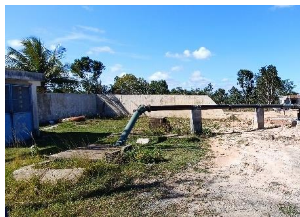
Figura 4.156 - Poço CSB2 do SAA Machadinho Norte Fonte: GEOHIDRO (2024).
