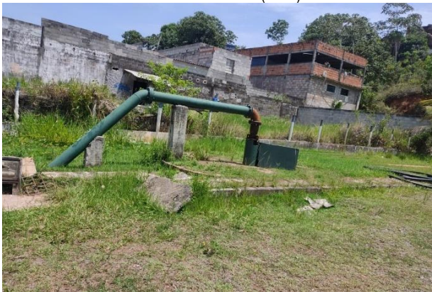
Figura 4.115 - Poço CSB5 Fonte: GEOHIDRO (2024).
