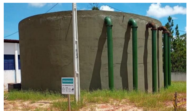
Figura 4.95 - CR2 - Poço de sucção e caixa de reunião zona Centro, próximo ao Morro da Manteiga - RAD 600 m 3 - previsto para entrar em operação em meados de 2024 Fonte: Embasa (2024).
