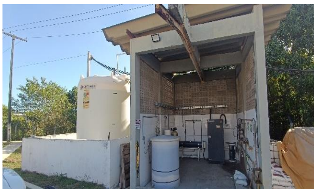
Figura 4.45 - ETA Alpha – Gerador de Hipoclorito de sódio in loco (Hidrogeron) Fonte: GEOHIDRO (2024).
