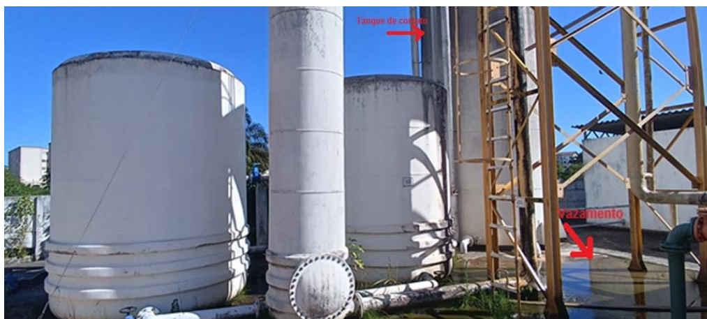
Figura 4.61 - Filtros russos e tanque de contato da ETA Terra Brasilis com indicativos de vazamentos Fonte: GEOHIDRO (2024).
