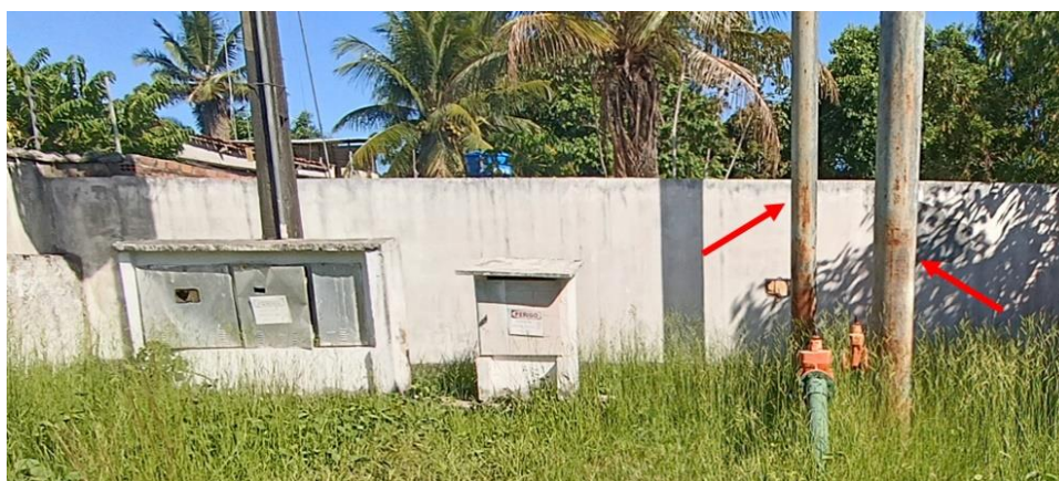
Figura 4.244 - Poço CSB3 (vista através portão de acesso)
