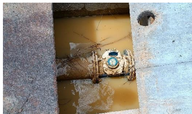
Figura 4.212 - Medidor de vazão do poço CSB6 Fonte: GEOHIDRO (2024).
