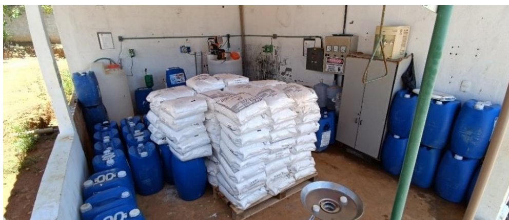
Figura 4.191 - Casa de química e laboratório do SAA Canto dos Pássaros (vista 2) Fonte: GEOHIDRO (2024).
