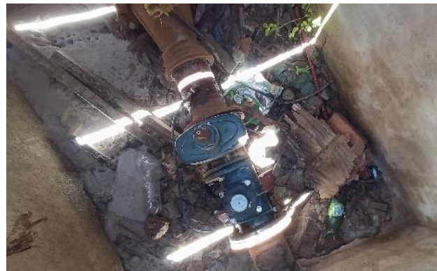
Figura 4.184 - Macro medidor do poço CSB2 Fonte: GEOHIDRO (2024).
