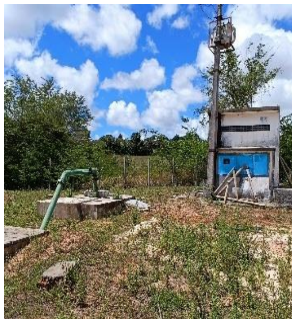
Figura 4.200 - Área do poço CSB4 Fonte: GEOHIDRO (2024).
