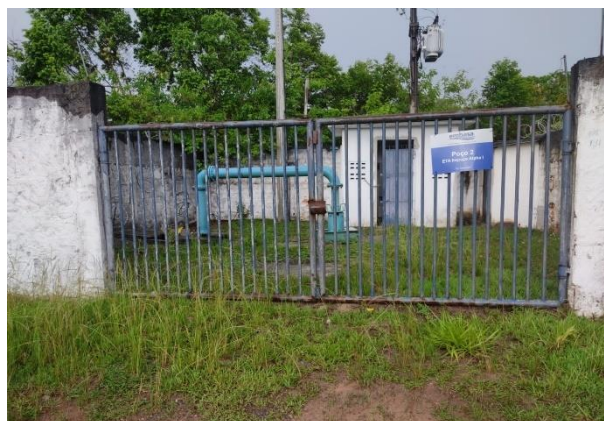
Figura 4.6 - Entrada do poço CSB 2
