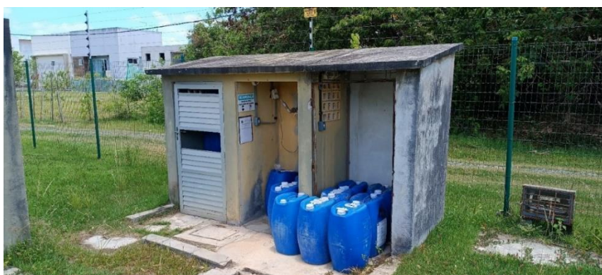
Figura 4.133 - Casa de química do sistema Terras Alphaville Fonte: GEOHIDRO (2024).
