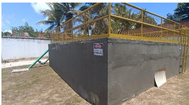
Figura 4.125 - Tanque de Contato 1 RAD 160 m 3 Fonte: GEOHIDRO (2024).
