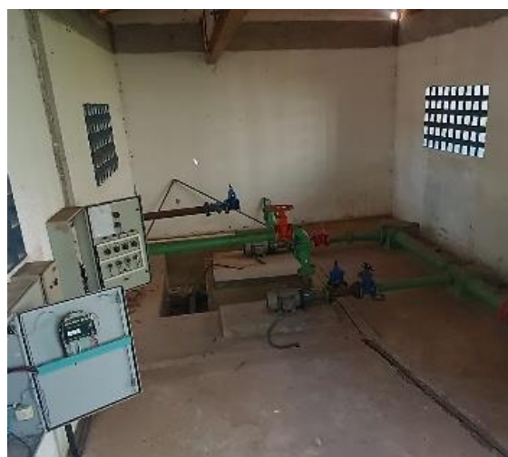
Figura 4.234 - Conjuntos motobombas da EEAT2
