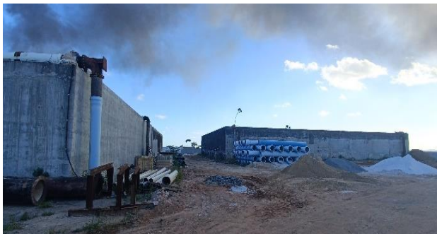
Figura 4.92 - Reservação da zona Centro/Alpha, Morro da Manteiga – 2 RAD 4000 m 3 e RAD 6000 m 3 Fonte: GEOHIDRO (2024).
