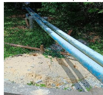
Figura 7.30 – Tubulação de extravasamento. Fonte: GEOHIDRO (2024).
