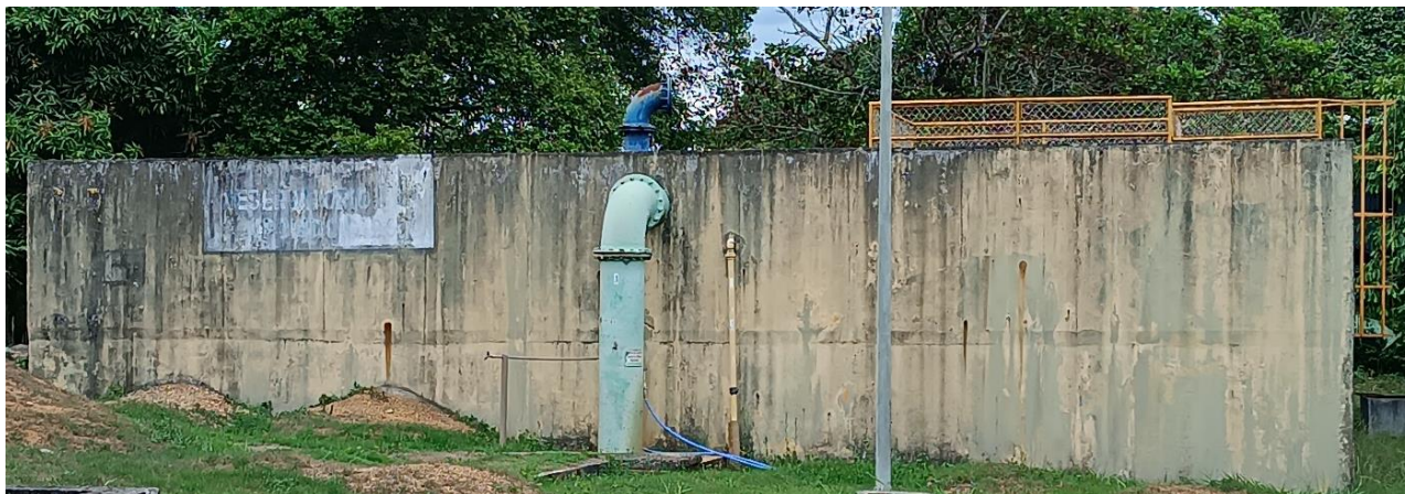
Figura 7.46 – Reservatório apoiado de distribuição (900m 3 ). Fonte: GEOHIDRO (2024).
