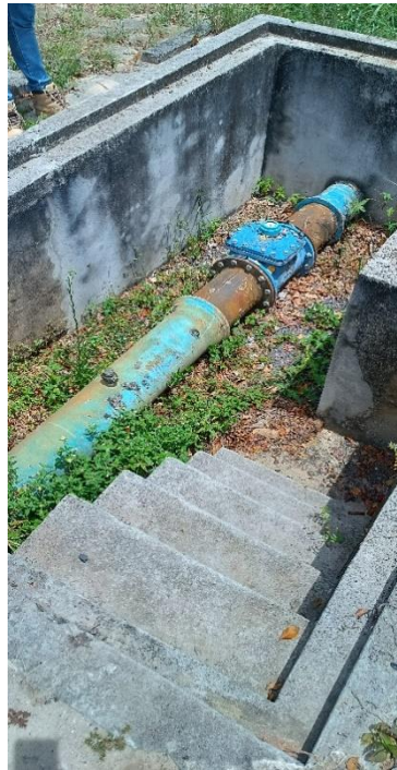
Figura 7.48 – Medidor de vazão Woltmann na saída da ETA para a distribuição. Fonte: GEOHIDRO (2024).
