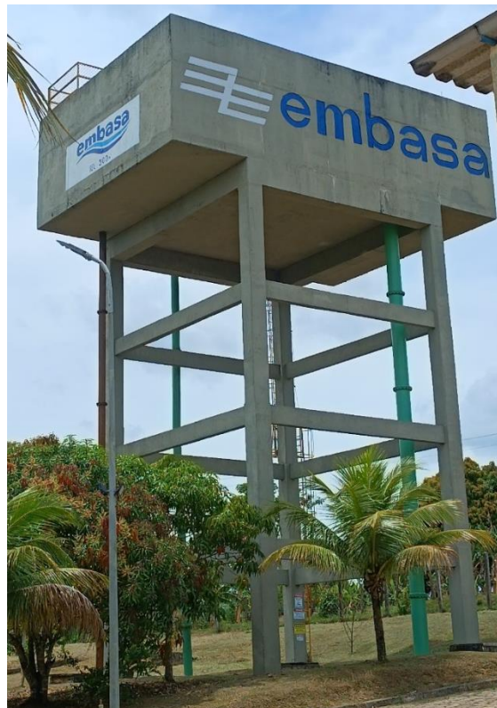
Figura 7.49 - Reservatório elevado para lavagem de filtros (300m 3 ). Fonte: GEOHIDRO (2024).
