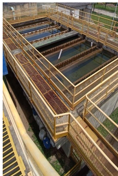
Figura 7.39 – Filtro Ascendente 02. Fonte: GEOHIDRO (2024).
