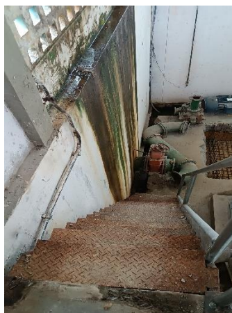
Figura 7.33 – Extravasamento da água captada por meio dos cobogós. Fonte: Elaboração própria (2024).
