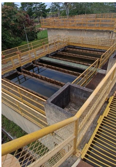
Figura 7.38 – Filtro Ascendente 01. Fonte: GEOHIDRO (2024).
