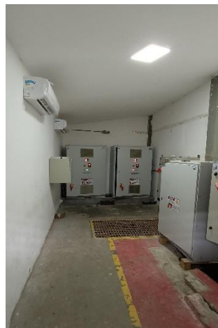
Figura 7.32 – Sala de Comando. Fonte: Elaboração própria (2024).
