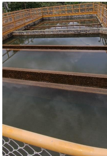
Figura 7.37 – Decantadores. Fonte: GEOHIDRO (2024).
