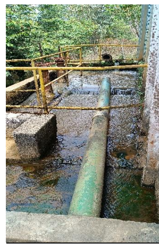
Figura 7.28 – Canaleta da caixa de areia. Fonte: GEOHIDRO (2024).
