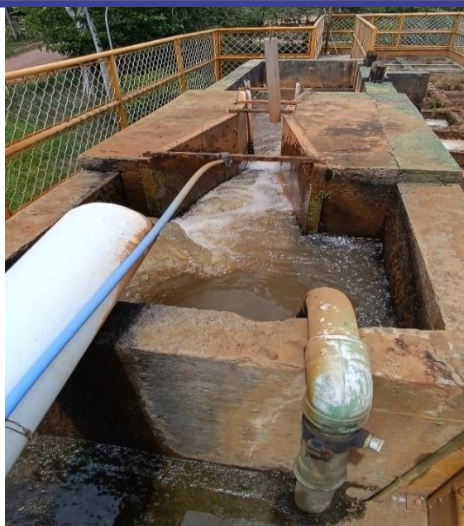
Figura 7.35 – Chegada da água bruta na calha Parshall. Fonte: GEOHIDRO (2024).
