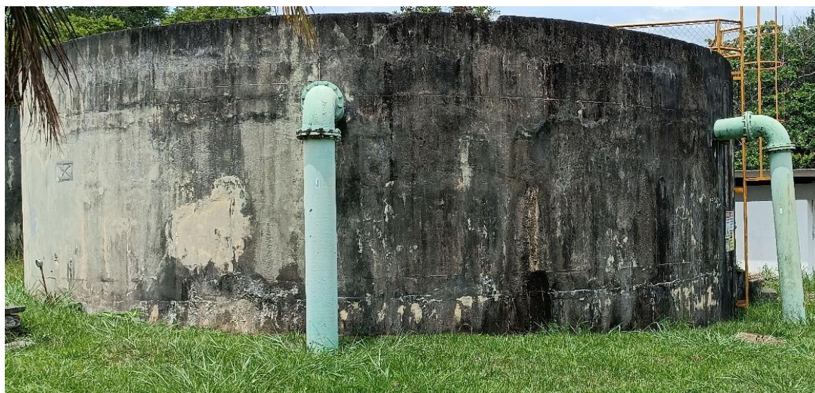
Figura 7.47 - Reservatório apoiado para lavagem de filtros (500m 3 ). Fonte: GEOHIDRO (2024).
