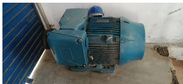
Figura 7.34 – Bomba Centrífuga em fase de substituição. Fonte: Elaboração própria (2024).
