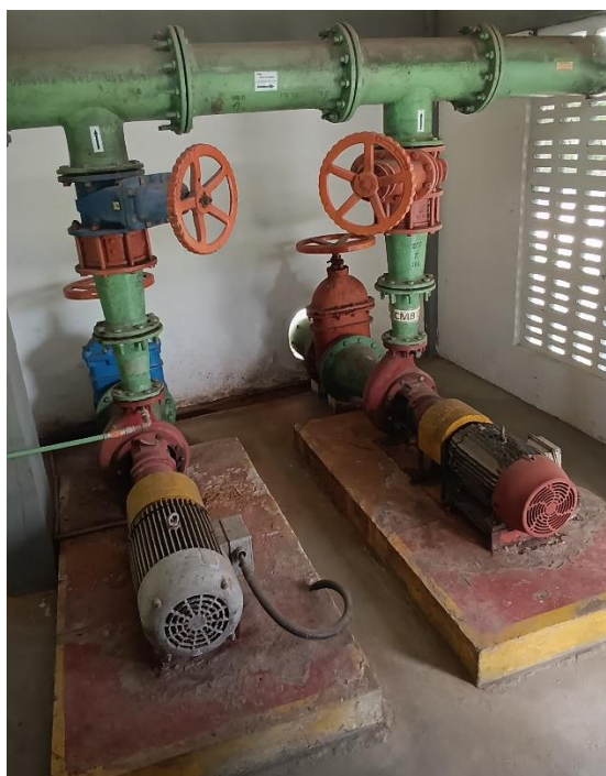
Figura 7.44 – Estação elevatória para reservatório de lavagem de filtros.
