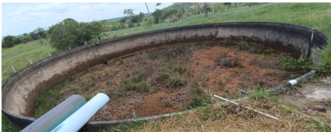
Figura 7.42 - Reservatório de água reaproveitada. Fonte: GEOHIDRO (2024).
