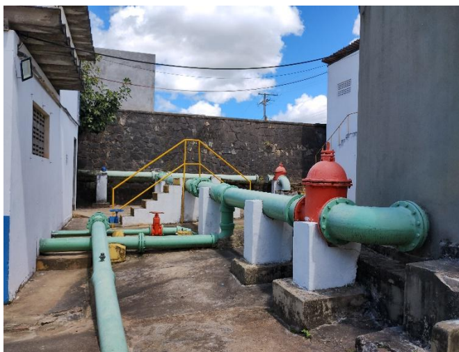
Figura 8.36 - EEAT1 – Vista da Tubulação de sucção da EEAT1/RAD 2
