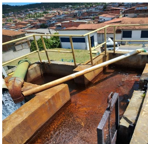
Figura 8.20 - Vista da Torre de chegada (canal vertical descendente e ascendente) e canal de distribuição da vazão para os módulos dos Filtros. Fonte: GEOHIDRO (2024).
