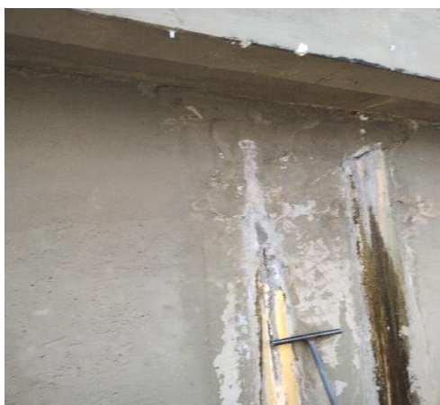
Figura 8.24 - Vista da parede do filtro apresentando infiltração
