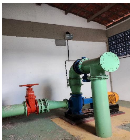
Figura 8.28 - Vista da EEAT-2 – Recalque para lavagem dos filtros (1+0)
