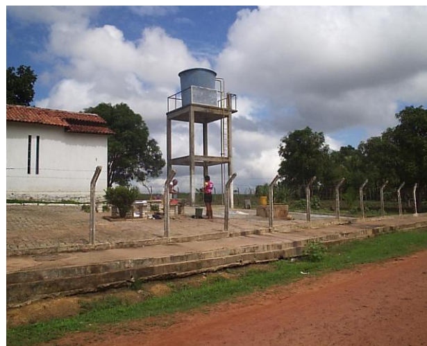
Figura 8.48 - Reservatório de Geari – Tanque em Fibra de 10m 3
