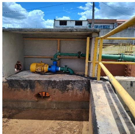
Figura 8.25 - Vista do recalque da água de reaproveitamento da lavagem dos filtros
