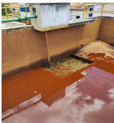
Figura 8.26 - Vista do Tanque de decantação da água de lavagem dos Filtros
