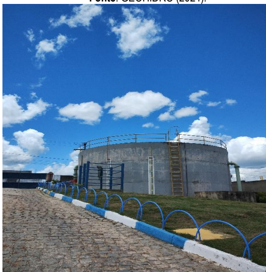
Figura 8.39 - Vista do RAD3 500 m 3 Fonte: GEOHIDRO (2024).
