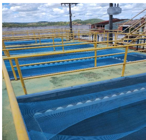
Figura 8.21 - Vista das calhas coletoras dos Filtros russos, protegidas por telas devido a presença de aves. Fonte: GEOHIDRO (2024).
