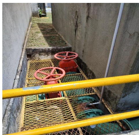
Figura 8.23 - Vista da caixa do tubo de água tratada e derivação para o RAD 2 e RAD3. Fonte: GEOHIDRO (2024).
