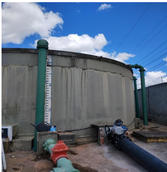
Figura 8.41- Vista do RAD2 250 m 3 Fonte: GEOHIDRO (2024).
