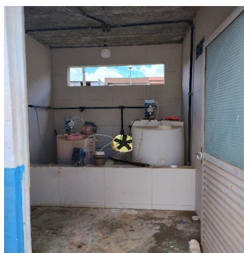
Figura 8.31 - Vista da casa de Química – Sistema de Fluoretação Fonte: GEOHIDRO (2024).
