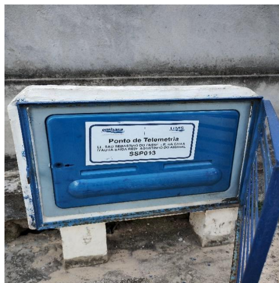
Figura 8.42 - Vista do Ponto de Telemetria da caixa de saída do RAD-2 para rede de distribuição Fonte: GEOHIDRO (2024).
