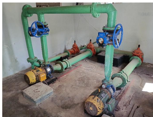
Figura 8.35 - EEAT1 – Vista dos conjuntos motobomba Fonte: GEOHIDRO (2024)
