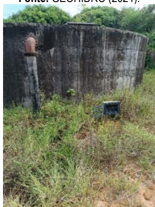
Figura 9.205 - Vista do extravasor e do ponto de telemetria danificado Fonte: GEOHIDRO (2024).
