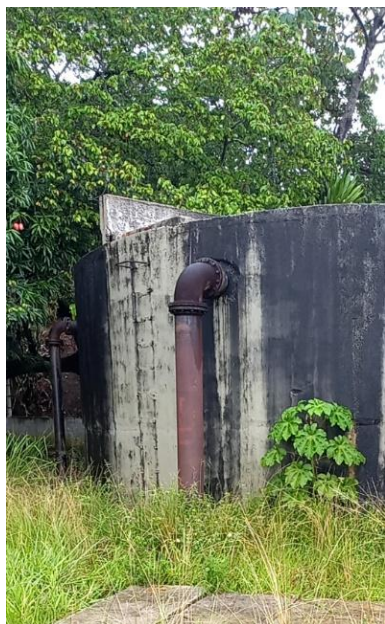
Figura 9.222 - Tubulação de entrada à esquerda e extravasor à direita do reservatório mais antigo Fonte: GEOHIDRO (2024).
