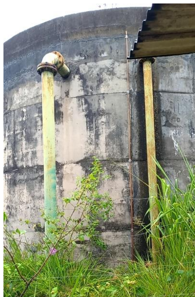
Figura 9.210 - Vista das tubulações de entrada no reservatório Fonte: GEOHIDRO (2024).
