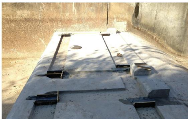
Figura 9.20 - Plataforma para os fusegates da barragem do Rio Tapera (2016)
