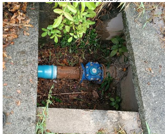
Figura 9.218 - Caixa do macromedidor na chegada do reservatório Fonte: GEOHIDRO (2024).
