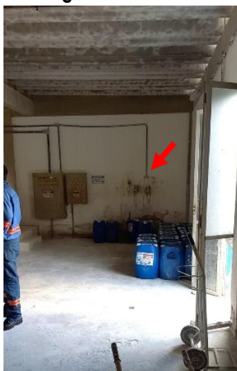
Figura 9.101 - Área destinada ao armazenamento das bombonas de flúor. Em vermelho a indicação das bombas dosadoras de flúor.
