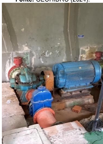
Figura 9.130 - Vista do conjunto motobomba e da válvula gaveta na tubulação de recalque Fonte: GEOHIDRO (2024).
