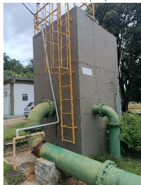
Figura 9.123 - Vista da torre de chegada com as tubulações de chegada da água bruta e do recalque das águas de lavagem
