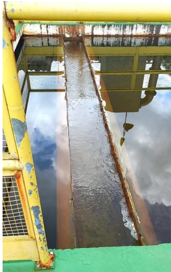
Figura 9.82 - Vista calha coletora de água tratada e dos vertedores longitudinais Fonte: GEOHIDRO (2024).
