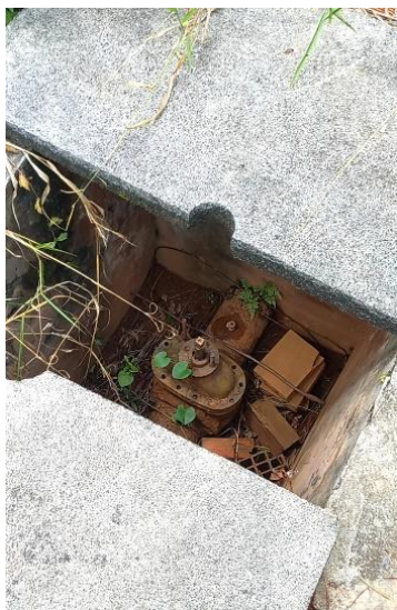
Figura 9.178 - Caixa de válvula de descarga do reservatório Fonte: GEOHIDRO (2024).
