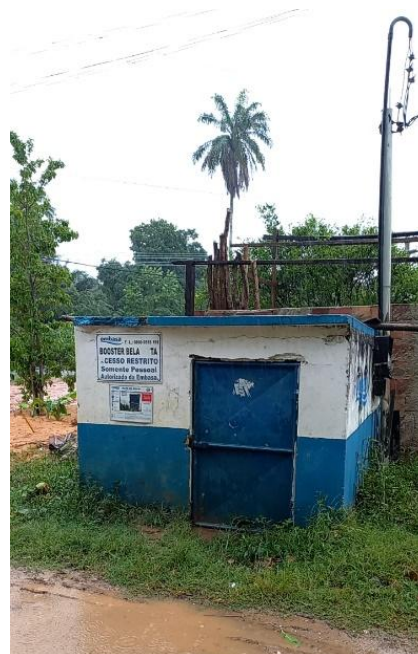
Figura 9.158 - Booster Bela Vista. Fonte: GEOHIDRO (2024).
