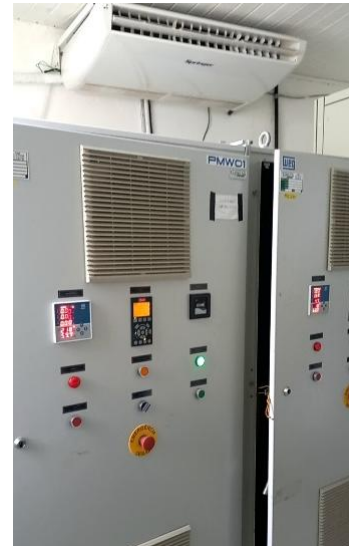
Figura 9.145 - Sala dos inversores climatizada Fonte: GEOHIDRO (2024).
