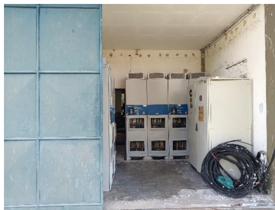
Figura 9.54 - Vista geral da casa de controle das bombas da EEAB Fonte: GEOHIDRO (2024).
