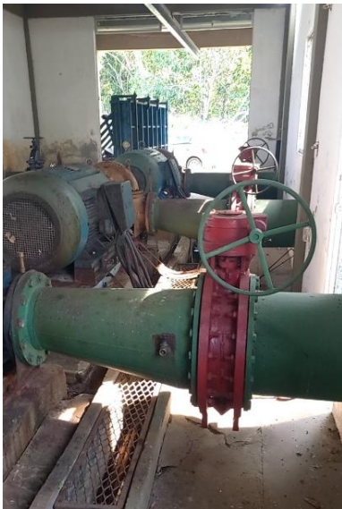
Figura 9.49 - Vista das válvulas na tubulação de sucção Fonte: GEOHIDRO (2024).
