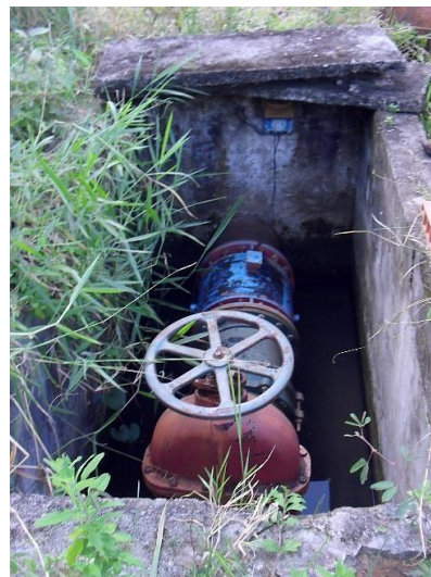
Figura 9.62 - Detalhe do macromedidor eletromagnético instalado Fonte: PARMS (2016).
