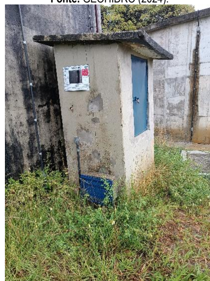
Figura 9.225 - Abrigo dos comandos elétricos e do ponto de telemetria Fonte: GEOHIDRO (2024).
