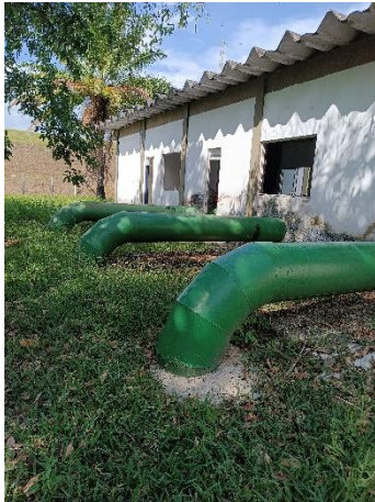
Figura 9.47 - Detalhes das tubulações de sucção do EEAB Fonte: GEOHIDRO (2024).
