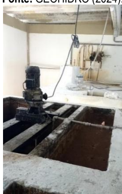
Figura 9.95 - Detalhe do misturador mecânico acoplado no tanque de diluição. Fonte: GEOHIDRO (2024).
