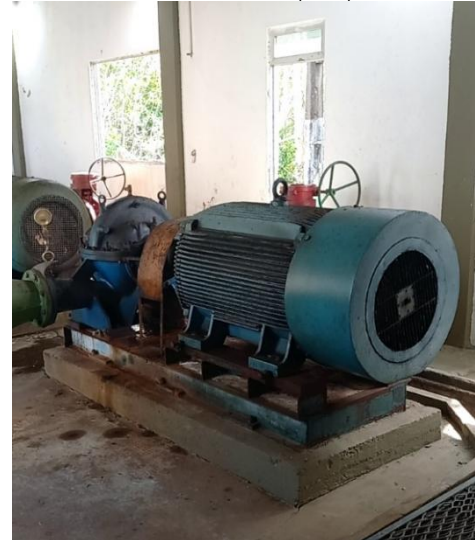
Figura 9.50 - Vista do conjunto motobomba: bomba e motor existentes implantados em base de apoio Fonte: GEOHIDRO (2024).
