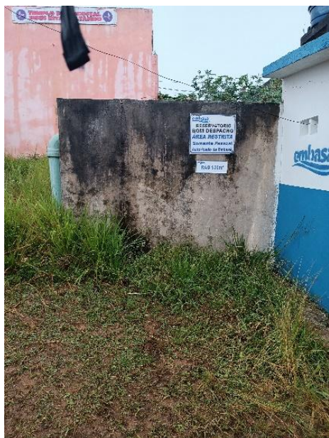
Figura 9.226 - Vista do RAD 13 – Bom Despacho ao lado do abrigo de comando da EEAT3 Fonte: GEOHIDRO (2024).
