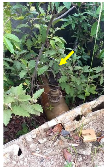
Figura 9.66 - Detalhe da AAB2 em RPVC, próximo ao Standpipe e vista da ventosa instalada Fonte: GEOHIDRO (2024).
