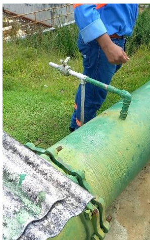
Figura 9.74 - Ponto de tomada de água bruta para análises de laboratório Fonte: GEOHIDRO (2024).
