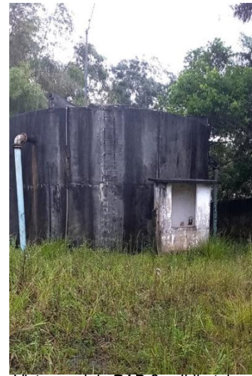
Figura 9.173 - Vista geral do RAD 2 – Jiribatuba e da tubulação de entrada Fonte: GEOHIDRO (2024).
