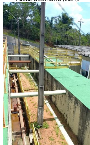
Figura 9.87 - Vista da interligação entre o módulo 2 dos filtros com o tanque de contato (tubulações aéreas) Fonte: GEOHIDRO (2024).
