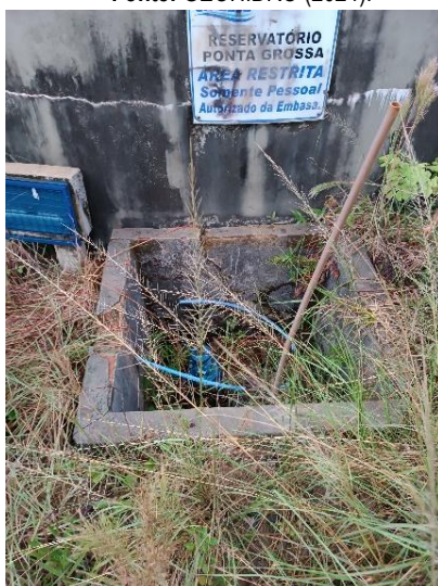
Figura 9.200 - Caixa da tubulação da saída do reservatório Fonte: GEOHIDRO (2024).
