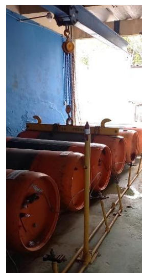
Figura 9.104 - Vista geral interna do abrigo de cilindros de cloro-gás com a monovia na parte superior
