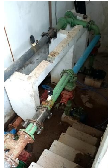
Figura 9.153 - Barrilete dos conjuntos motobomba da EEAT3 Fonte: GEOHIDRO (2024).
