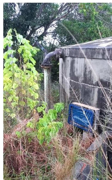
Figura 9.199 - Vista da tubulação do extravasor e ponto de telemetria no reservatório Fonte: GEOHIDRO (2024).
