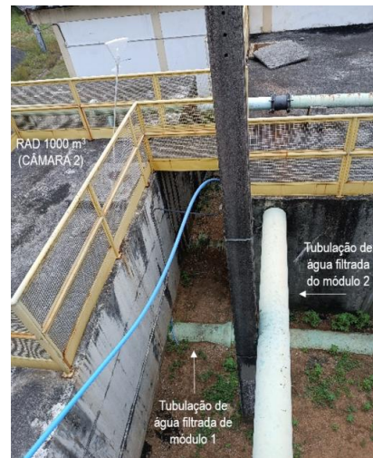
Figura 9.113 -Tubulações de chegada no RAD 1000 m 3 (módulo 2) derivada dos filtros Fonte: GEOHIDRO (2024).
