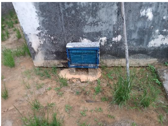
Figura 9.169 - Ponto de telemetria do reservatório Fonte: GEOHIDRO (2024).
