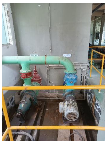
Figura 9.128 - Vista geral das bombas utilizadas para o reservatório de lavagem dos filtros Fonte: GEOHIDRO (2024).
