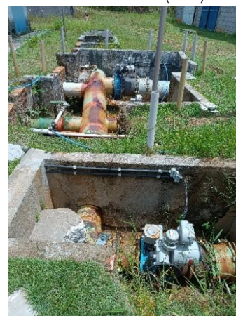
Figura 9.127 - Válvulas automatizadas na tubulação de recalque da EEAT1 Fonte: GEOHIDRO (2024).
