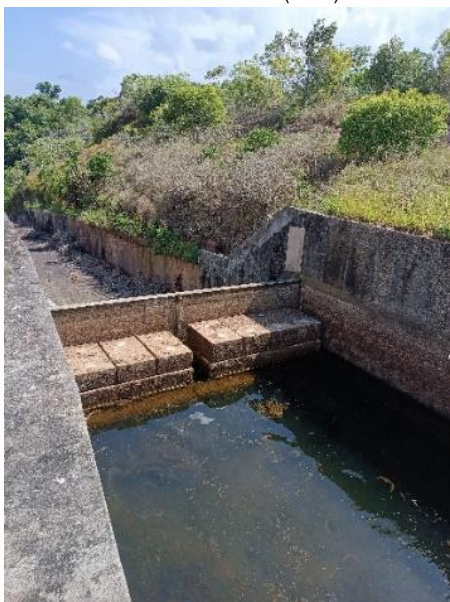
Figura 9.25 - Vista geral do fusegate sobre a soleira do vertedor da barragem Fonte: GEOHIDRO (2024).
