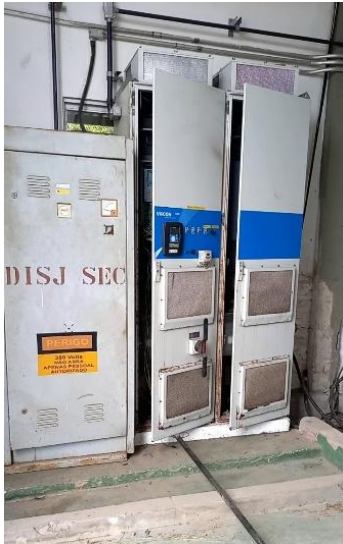
Figura 9.144 - Painel elétrico da EEAT2 Fonte: GEOHIDRO (2024).
