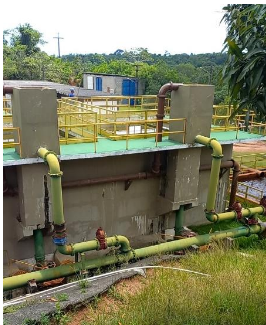
Figura 9.78 - Vista geral dos filtros russos e do barrilete de distribuição da água floculada no módulo 1 (4 filtros) Fonte: GEOHIDRO (2024).
