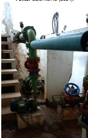
Figura 9.154 - Vista dos conjuntos motobomba da EEAT3 Fonte: GEOHIDRO (2024).
