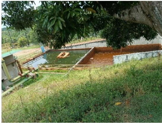
Figura 9.118 - Vista geral dos tanques de decantação com bombas flutuantes
