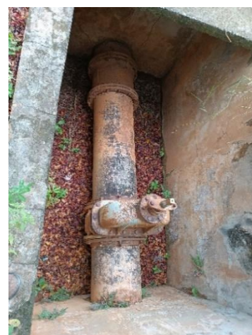
Figura 9.185 - Vista da adutora de saída dos reservatório com válvula gaveta Fonte: GEOHIDRO (2024).
