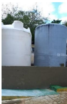
Figura 9.93 - Reservatórios de sulfato de alumínio localizados na área externa da Casa de Química Fonte: GEOHIDRO (2024).
