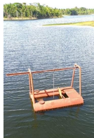
Figura 9.16 - Vista da captação flutuante do SIAA de Vera Cruz e Itaparica Fonte: GEOHIDRO (2024).
