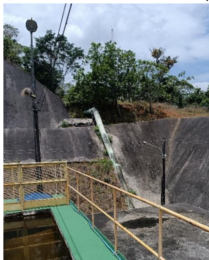
Figura 9.116 - Vista da tubulação de saída dos reservatórios de água de lavagem Fonte: GEOHIDRO (2024).
