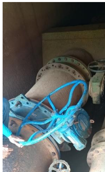
Figura 9.28 - Detalhe da válvula de descarga da barragem Tapera. Fonte: GEOHIDRO (2024).
