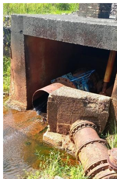
Figura 9.46 - Vista da galeria de drenagem com a descarga de fundo (à esquerda) e a adutora de água bruta (à direita)
