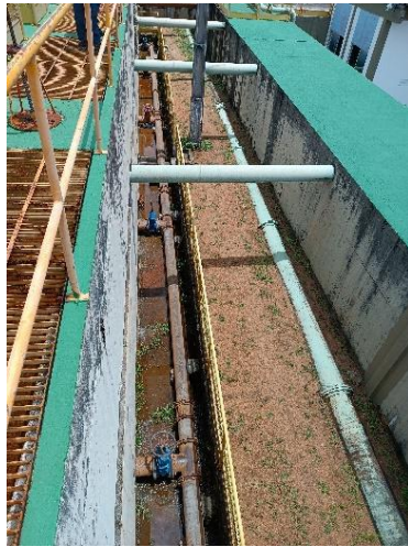
Figura 9.88 - Válvulas e barriete de descarga na parte inferior, e canal de drenagem do módulo de filtros 2 Fonte: GEOHIDRO (2024).
