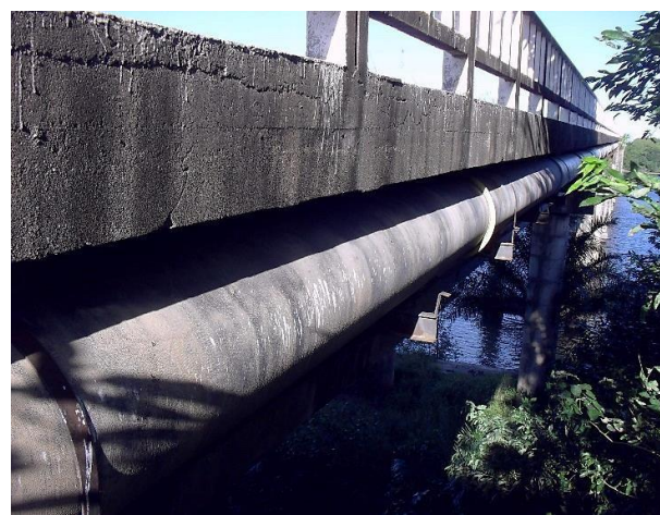
Figura 9.70 - Vista geral da travessia da AAB2 pela Ponte do Funil Fonte: PARMS (2016).
