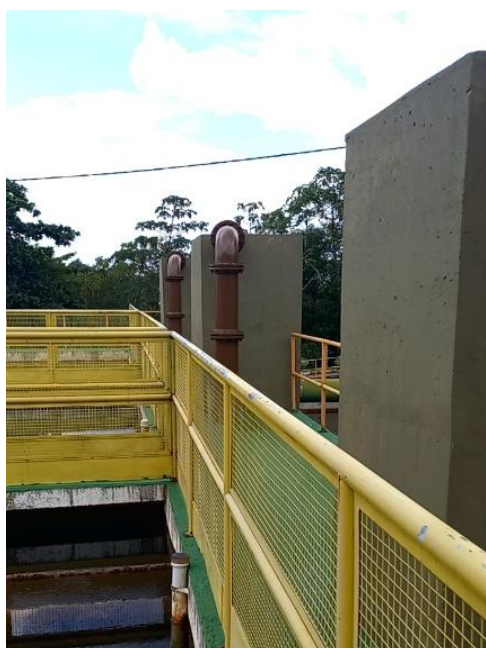
Figura 9.80 - Vista das caixas de distribuição da vazão nos filtros e do extravasor no módulo 1 (4 filtros) Fonte: GEOHIDRO (2024).
