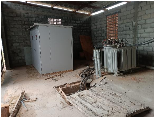
Figura 9.146 - Vista da área da subestação em condições inadequadas Fonte: GEOHIDRO (2024).
