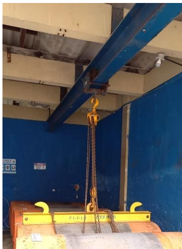
Figura 9.105 - Detalhe da talha e trolley instalados. Fonte: GEOHIDRO (2024).
