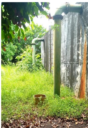
Figura 9.193 - Vistas das tubulações de alimentação do reservatório Fonte: GEOHIDRO (2024).
