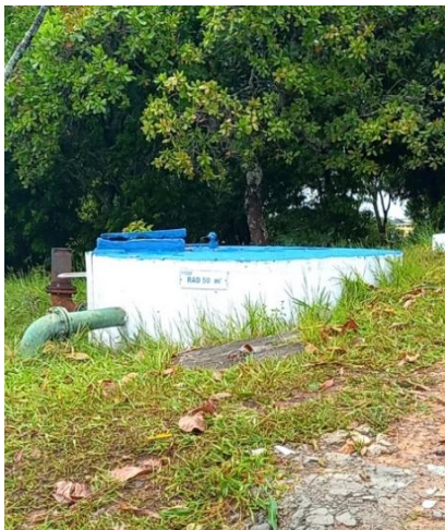
Figura 9.215 - Vista do reservatório RAD 11 Fonte: GEOHIDRO (2024).
