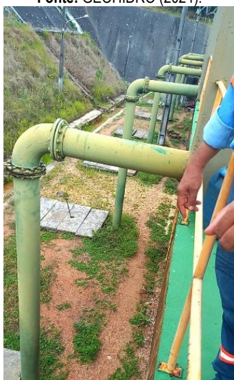
Figura 9.86 - Barrilete de distribuição de água bruta no módulo 2 (6 entradas) Fonte: GEOHIDRO (2024).
