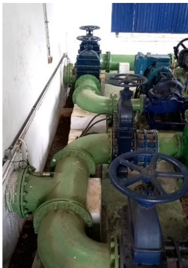
Figura 9.140 - Vista da sucção dos dois conjuntos motobomba da EEAT2 Fonte: GEOHIDRO (2024).
