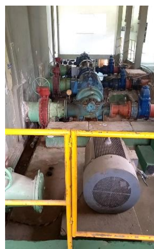
Figura 9.129 - Vista geral das 3 bombas utilizadas para o abastecimento do SIAA de Vera Cruz e Itaparica Fonte: GEOHIDRO (2024).
