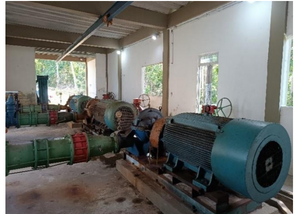
Figura 9.48 - Vista geral interna da casa de bombas com os conjuntos motobomba e a monovia na parte superior Fonte: GEOHIDRO (2024).
