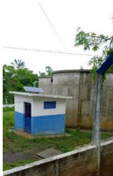
Figura 9.237 - Abrigo de comando elétrico para a automação do sistema Fonte: GEOHIDRO (2024).
