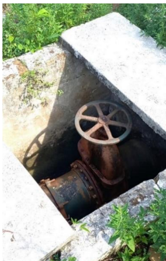
Figura 9.57 - Caixa da válvula gaveta localizada após o barrilete de sucção da elevatória Fonte: GEOHIDRO (2024).
