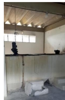
Figura 9.94 - Tanques de diluição do sulfato de alumínio Fonte: GEOHIDRO (2024).
