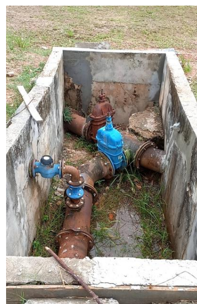
Figura 9.143 - Caixa de derivação das adutoras de recalque da EEAT2 Fonte: GEOHIDRO (2024).
