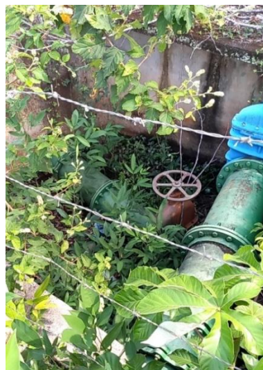
Figura 9.58 - Caixa de derivação das adutoras de água bruta Fonte: GEOHIDRO (2024).
