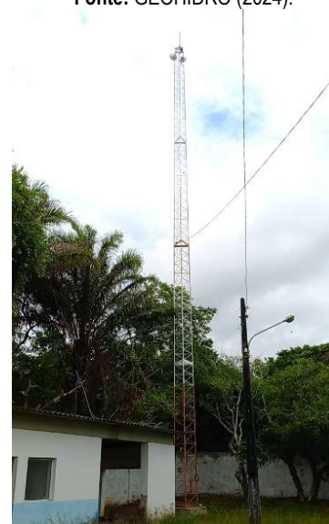
Figura 9.149 - Torre de telemetria para operação da EETA2 a partir da ETA Fonte: GEOHIDRO (2024).
