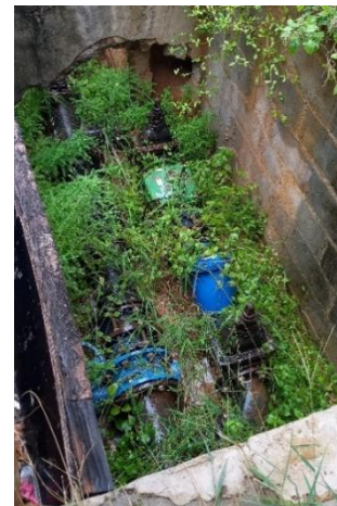
Figura 9.232 - Caixa das válvulas nas tubulações de entrada no reservatório Fonte: GEOHIDRO (2024).
