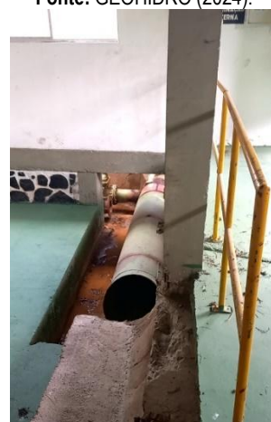
Figura 9.131 - Vista da calha do sistema de drenagem da EEAT1 Fonte: GEOHIDRO (2024).
