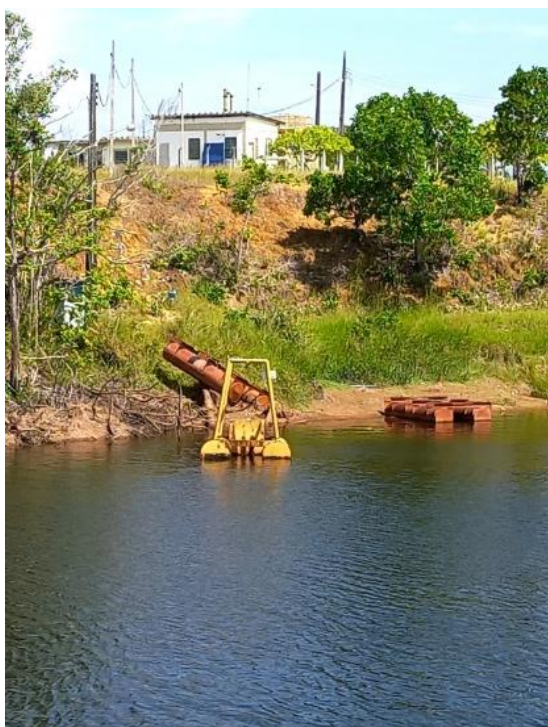
Figura 9.17 - Vista da captação flutuante do SAA Caçoes Fonte: GEOHIDRO (2024).
