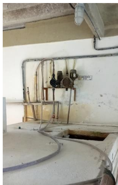
Figura 9.100 - Bombas dosadoras de hidróxido de cálcio Fonte: GEOHIDRO (2024).
