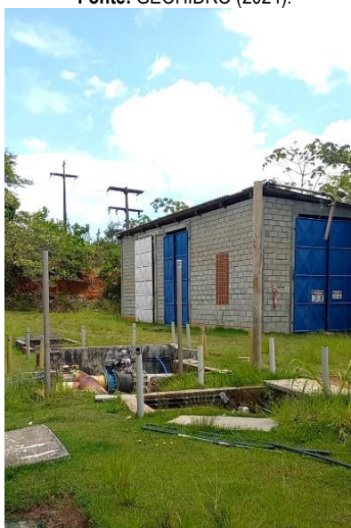
Figura 9.134 - Vista da caixa de válvulas do recalque da EEAT1 e da subestação existente Fonte: GEOHIDRO (2024).
