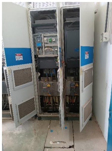
Figura 9.133 - Vista geral interna do quadro de comando Fonte: GEOHIDRO (2024).
