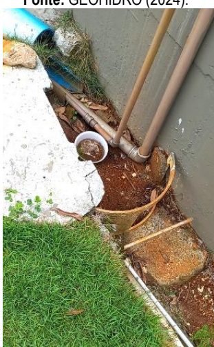
Figura 9.76 - Vista das tubulações de dosagem química seguindo para o topo da torre de mistura Fonte: GEOHIDRO (2024).
