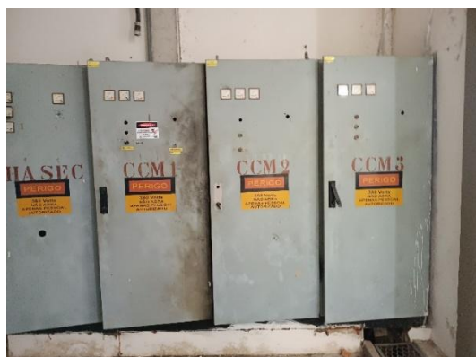
Figura 9.55 - Quadro de comando das bombas do EEAB Fonte: GEOHIDRO (2024).
