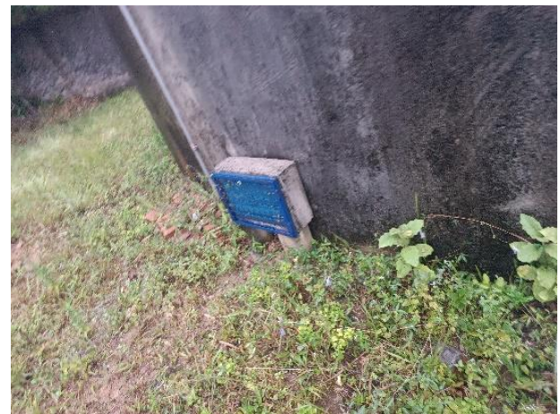
Figura 9.175 - Ponto de telemetria do reservatório Fonte: GEOHIDRO (2024).
