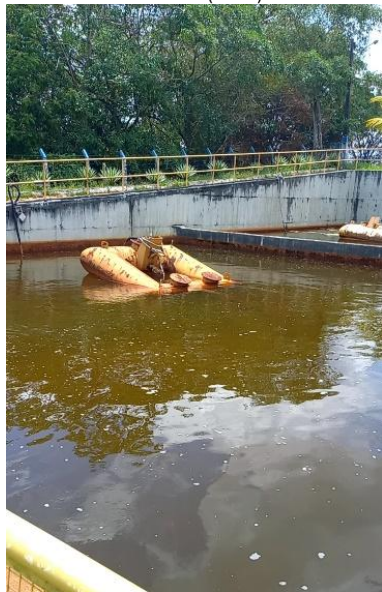
Figura 9.120 - Vista de uma das bombas com problema na estrutura de flutuação no tanque de adensamento
