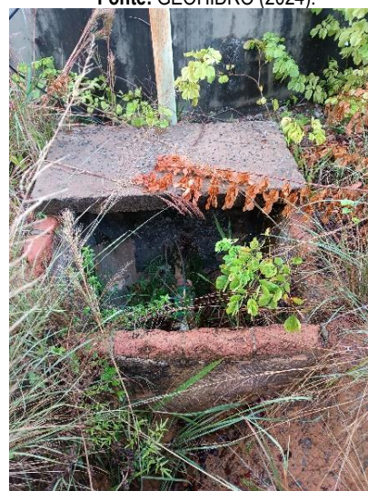
Figura 9.201 - Caixa da tubulação da chegada do reservatório Fonte: GEOHIDRO (2024)..
