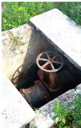
Figura 9.61 - Caixa de registro geral da AAB1, após a casa de bombas, no qual está instalado o macromedidor da AAB1 Fonte: GEOHIDRO (2024).
