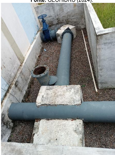
Figura 9.142 - Tubulação de recalque da EEAT2 que deriva dos conjuntos motobomba Fonte: GEOHIDRO (2024).
