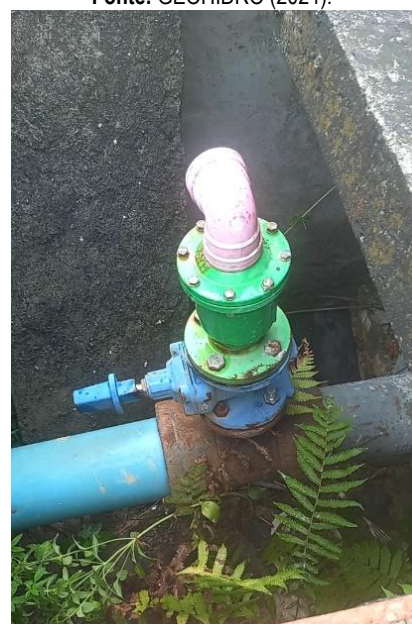
Figura 9.213 - Caixa da tubulação de saída do reservatório Fonte: GEOHIDRO (2024).
