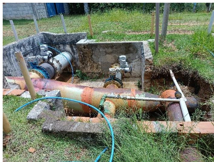
Figura 9.135 - Caixa das válvulas automatizadas no recalque da EEAT1 Fonte: GEOHIDRO (2024).
