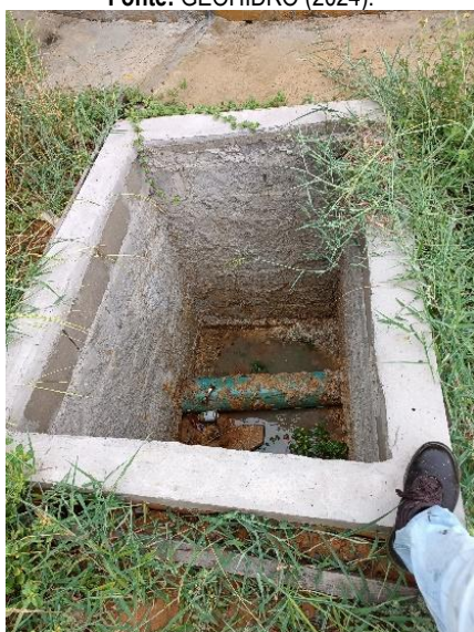
Figura 9.224 - Caixa de interligação entre os reservatórios Fonte: GEOHIDRO (2024).
