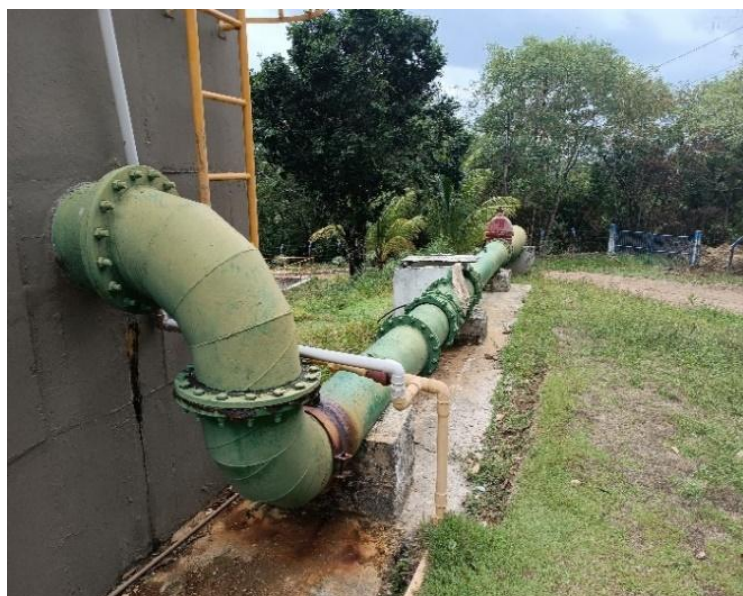
Figura 9.73 - Adutora de água bruta (DN 700 mm) entroncando na torre de mistura Fonte: GEOHIDRO (2024).
