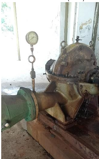
Figura 9.51 - Manômetros instalados na tubulação de recalque após o conjunto motobomba Fonte: GEOHIDRO (2024)..
