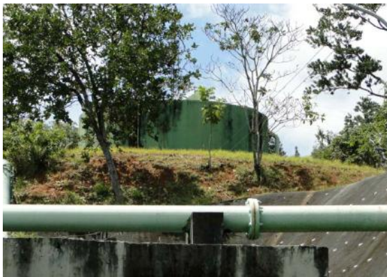
Figura 9.114 - Vista dos reservatórios de lavagem da ETA de Itaparica. Fonte: Embasa (2022).
