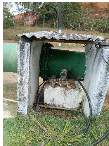
Figura 9.75 - Macromedidor de chegada na ETA de Itaparica Fonte: GEOHIDRO (2024).
