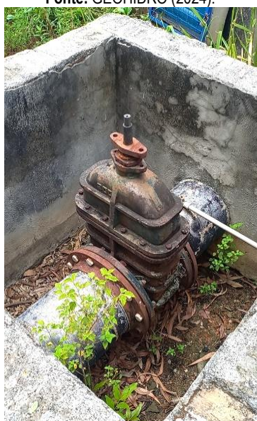
Figura 9.188 - Válvula gaveta da caixa de interligação entre os reservatórios Fonte: GEOHIDRO (2024).
