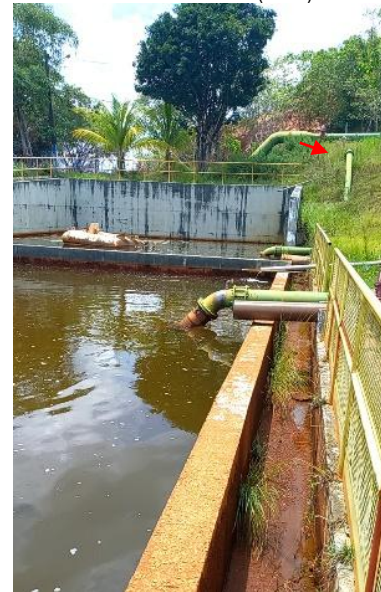
Figura 9.121 - Vista do recalque das águas de lavagem do tanque de adensamento
