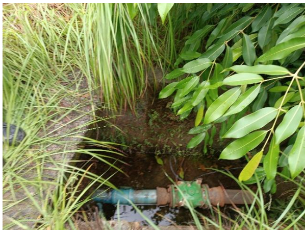
Figura 9.195 - Caixa da tubulação de chegada do reservatório Fonte: GEOHIDRO (2024).
