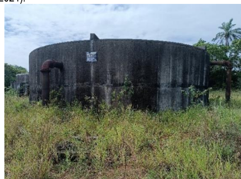
Figura 9.204 - Vista da tubulação de entrada (à esquerda) e da tubulação do extravasor (à direita) Fonte: GEOHIDRO (2024).
