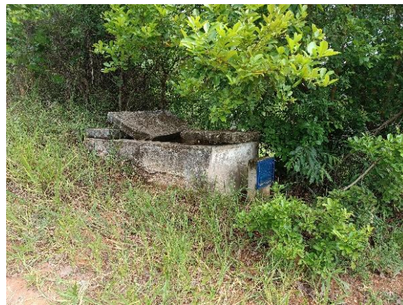
Figura 9.196 - Caixa das tubulações de chegada e saída do reservatório com macromedidor e ponto de telemetria Fonte: GEOHIDRO (2024).
