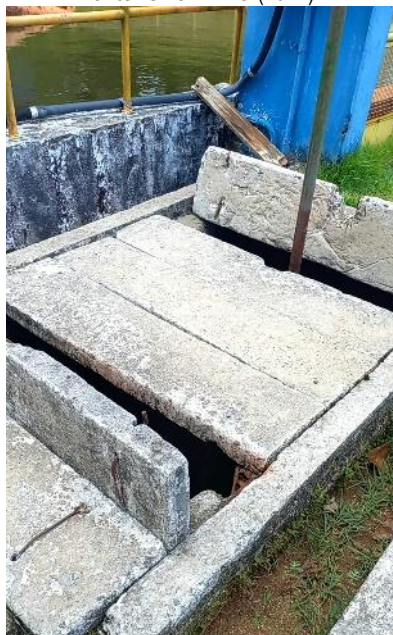
Figura 9.122 - Caixa de registros de descarga de fundo dos tanques de decantação
