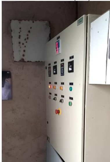
Figura 9.152 - Quadro de comando da EEAT3 Fonte: GEOHIDRO (2024).
