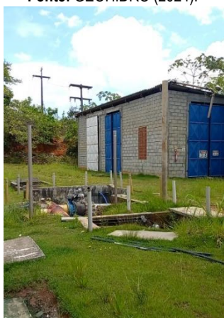
Figura 9.126 - Vista da caixa de válvulas automatizadas da EEAT1 dentro da área da ETA Fonte: GEOHIDRO (2024).
