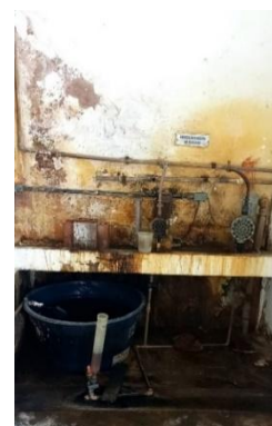
Figura 9.96 - Detalhe das bombas dosadoras de sulfato de alumínio situadas atrás dos tanques de diluição Fonte: GEOHIDRO (2024).
