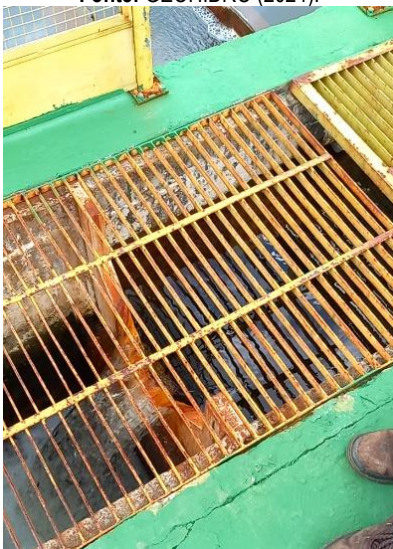
Figura 9.84 - Vista do trecho final da calha coletora e derivação com vertedor e derivação para o tanque de contato Fonte: GEOHIDRO (2024).
