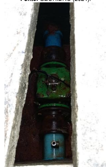
Figura 9.155 - Vista do macromedidor do reservatório do RAD Bom Despacho Fonte: GEOHIDRO (2024).
