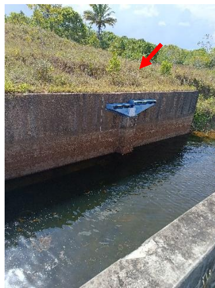
Figura 9.24 - Vista geral do canal de lateral a montante do fusegate. Em vermelho, o dispositivo de acionamento do fusegate. Fonte: GEOHIDRO (2024).
