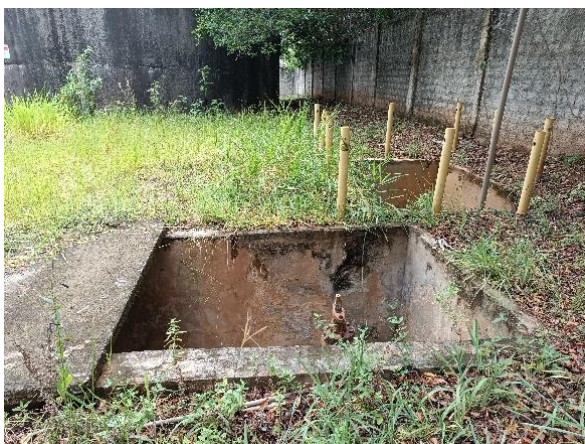
Figura 9.184 - Vista das caixas de válvulas para operação das linhas de saída do reservatório Fonte: GEOHIDRO (2024).
