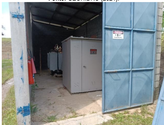
Figura 9.56 - Subestação Fonte: GEOHIDRO (2024).
