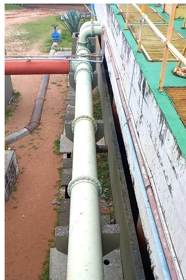
Figura 9.85 - Barrilete das tubulações de coleta de água filtrada e vista da conexão para o tanque de contato do módulo 2 Fonte: GEOHIDRO (2024).
