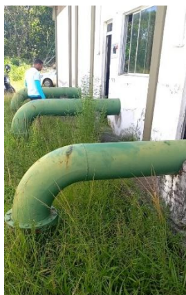
Figura 9.53 - Vista geral das tubulações que se interligam ao barrilete de recalque com diâmetro de 400 mm Fonte: GEOHIDRO (2024).
