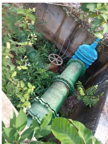
Figura 9.63 - Vista geral da caixa de derivação, situado próximo a barragem Tapera Fonte: GEOHIDRO (2024).
