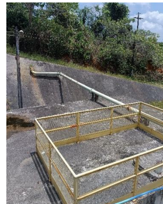
Figura 9.115 - Vista da tubulação de recalque para os reservatórios elevatórios de água de lavagem Fonte: GEOHIDRO (2024).
