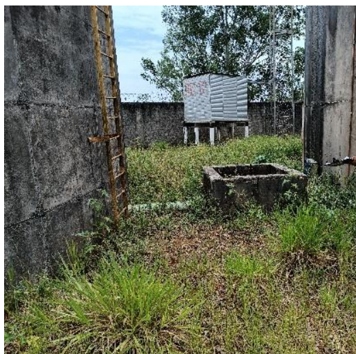
Figura 9.187 - Caixa de válvula para interligação entre os reservatórios Fonte: GEOHIDRO (2024).
