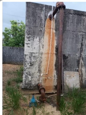
Figura 9.168 - Vista da tubulação de entrada na parte superior e da tubulação de saída na parte inferior
