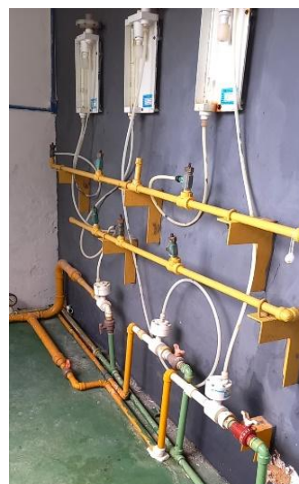
Figura 9.106 - Barrilete do sistema de dosagem de cloro Fonte: GEOHIDRO (2024).
