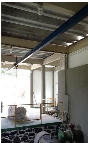
Figura 9.132 - Vista geral da monovia com talha Fonte: GEOHIDRO (2024).
