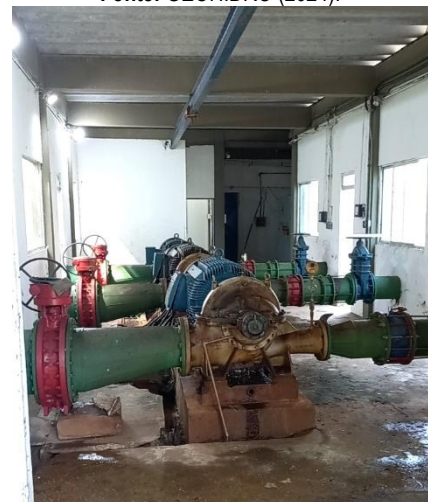
Figura 9.52 - Vista dos conjuntos motobomba com válvulas na tubulação de sucção e juntas de desmontagem e válvulas na tubulação de recalque Fonte: GEOHIDRO (2024).
