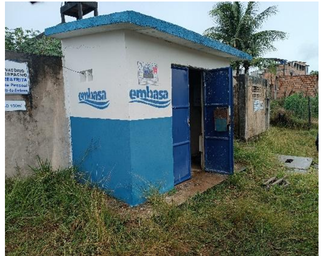
Figura 9.151 - Abrigo do quadro de comandos da EEAT3 adjacente ao reservatório Fonte: GEOHIDRO (2024).
