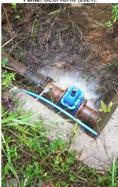
Figura 9.176 - Caixa de válvula de saída no reservatório Fonte: GEOHIDRO (2024).
