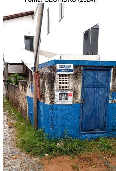
Figura 9.160 - Booster Rua do Céu 1. Fonte: GEOHIDRO (2024).
