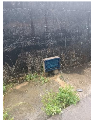
Figura 9.234 - Ponto de telemetria do reservatório Fonte: GEOHIDRO (2024).
