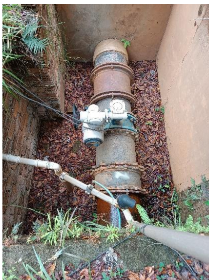
Figura 9.186 - Válvula com atuador elétrico na linha de saída do reservatório Fonte: GEOHIDRO (2024).
