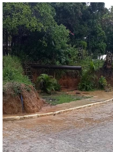
Figura 9.179 - Tubulação do extravasor com lançamento direto na via pública Fonte: GEOHIDRO (2024).
