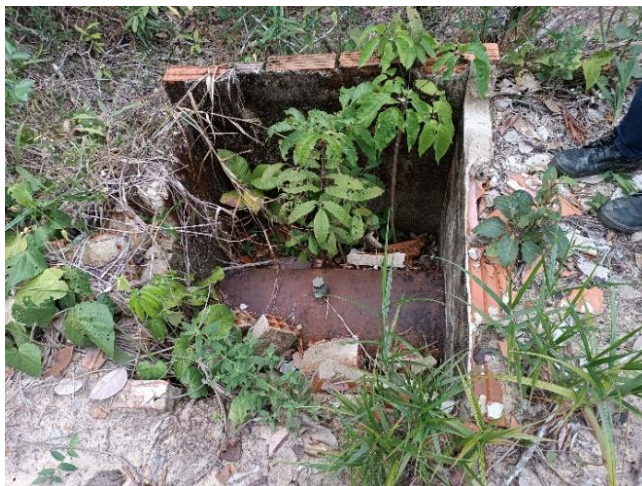
Figura 9.67 - Vista da AAB1 em ferro fundido ponto de pitometria. Localizada próxima do Stand-Pipe Fonte: GEOHIDRO (2024).
