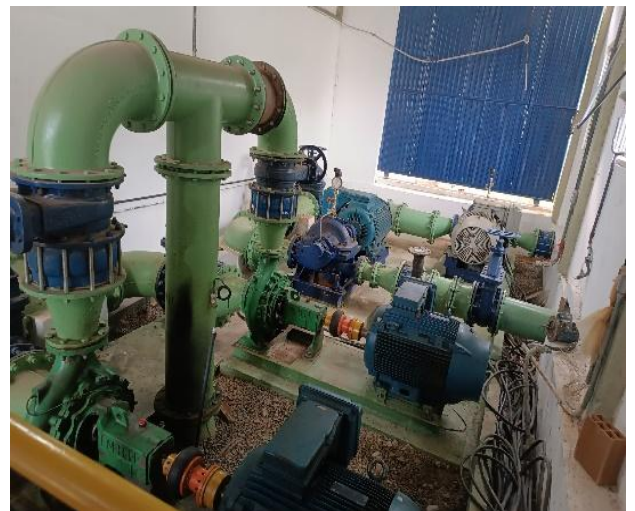
Figura 9.141 - Vista geral dos conjuntos motobomba da EEAT2 Fonte: GEOHIDRO (2024).
