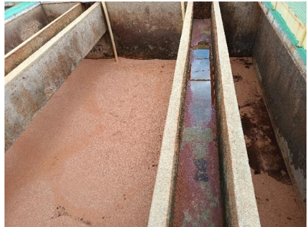
Figura 9.83 - Detalhe da estrutura dos filtros com o leito de areia e a calha coletora (filtro fora de operação) Fonte: GEOHIDRO (2024).
