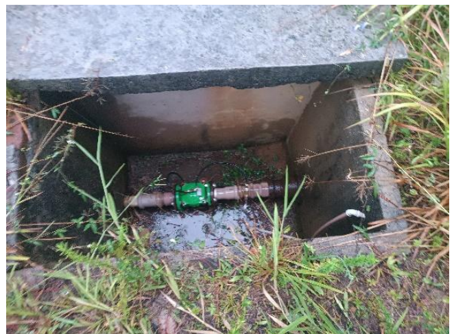
Figura 9.177 - Caixa de válvula de entrada do reservatório Fonte: GEOHIDRO (2024).
