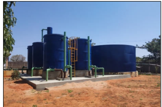
Figura 10 - ETA – Filtros e RAD 200 m3
