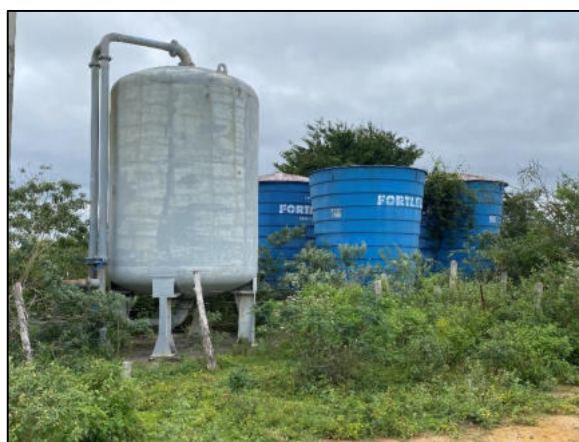
Figura 17 – Estação de Tratamento de Água – Detalhe do Filtro e RADs instalados
