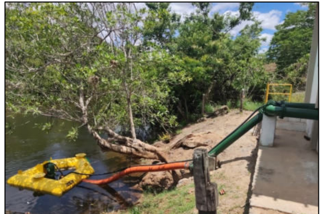
Figura 2 - Captação Flutuante e EEAB1
