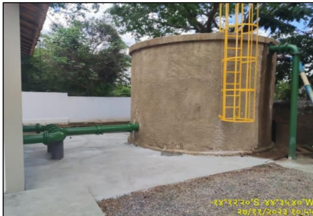
Figura 9 - Poço de sucção 50 m3 - EEAB2
