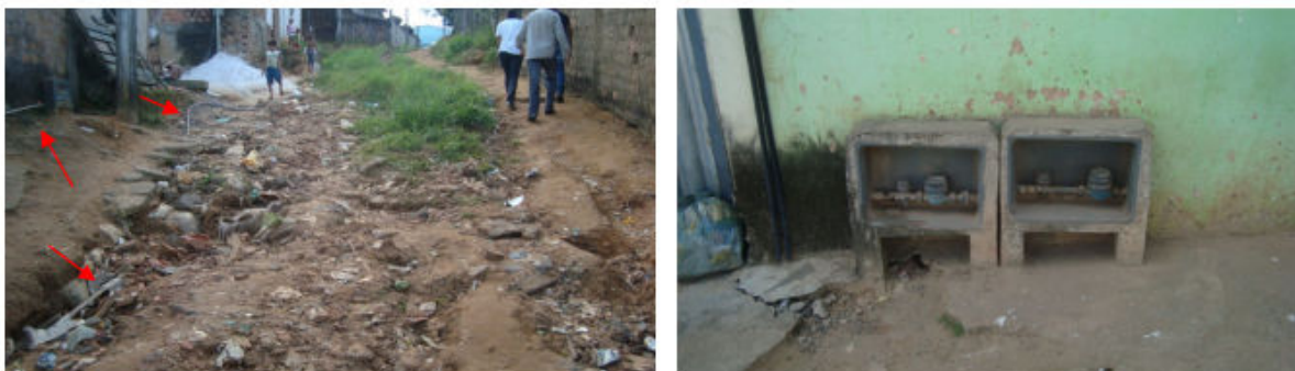
Figura 6.7 - Tubulação da Rede de Distribuição Aparente e Hidrômetros
