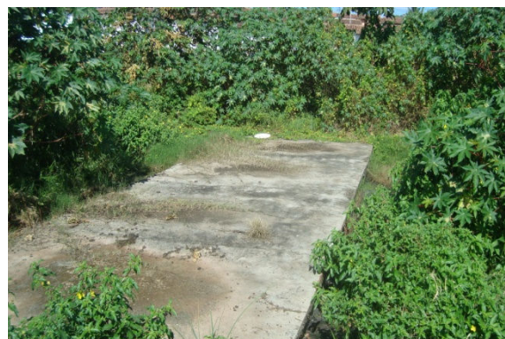
Figura 4.54 - Uma das Fossas Sépticas que Recebe o Esgoto Coletado do CH Jardim Campo Verde
