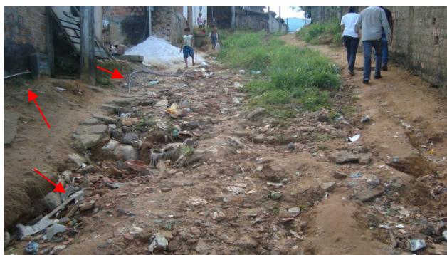
Figura 4.4 - Tubulação da Rede de Distribuição Aparente, Localidade de Jardim Campo Verde/Barro Duro
