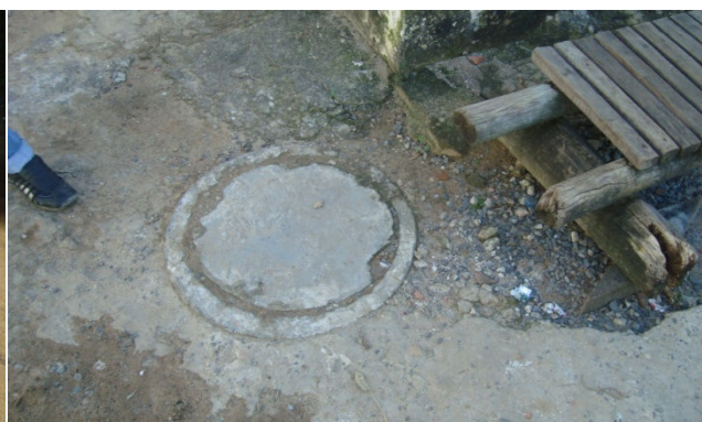
Figura 4.74 - Caixa de Passagem, Alto do Girassol
