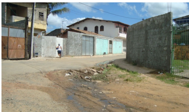
Figura 4.65 - Esgoto a Céu Aberto, Loteamento Ceasa
