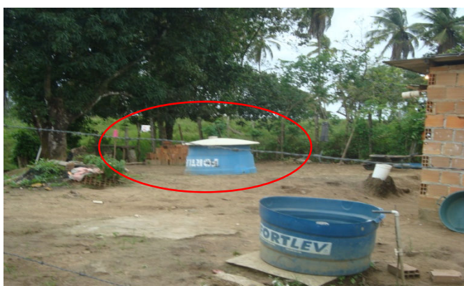
Figura 4.38 - Reservatório de 2.000 L Furado
