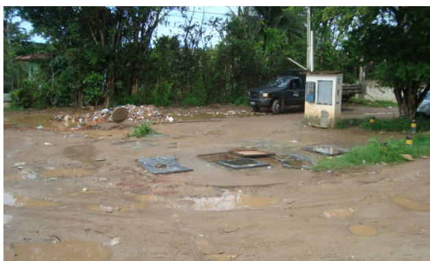
Figura 4.67 - Estação Elevatória de Esgoto Existente, Comunidade do Bosque Ipitanga
