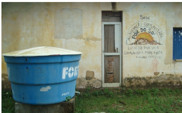
Figura 4.28 - Reservatório de 2.000 L, Loteamento Por do Sol
