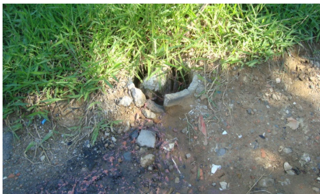
Figura 4.75 - Caixa de Passagem Danificada, Alto do Girassol
