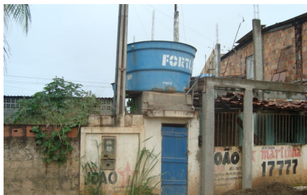
Figura 4.41 - Reservatório de 2.000 L, Localidade de Biribeira
