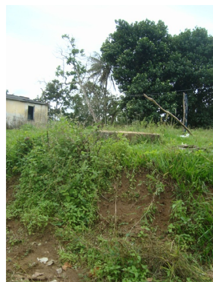
Figura 4.37 - Base do Reservatório de 2.000 L (RAD 1) – Comunidade Pedreira Carangi
