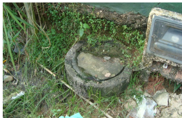
Figura 4.60 - Caixa de Passagem Transbordando, Próxima a Rede de Água aflorando no Solo, Nova Esperança
