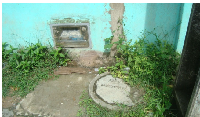
Figura 4.69 - Caixa de Passagem, Loteamento Vila Santana
