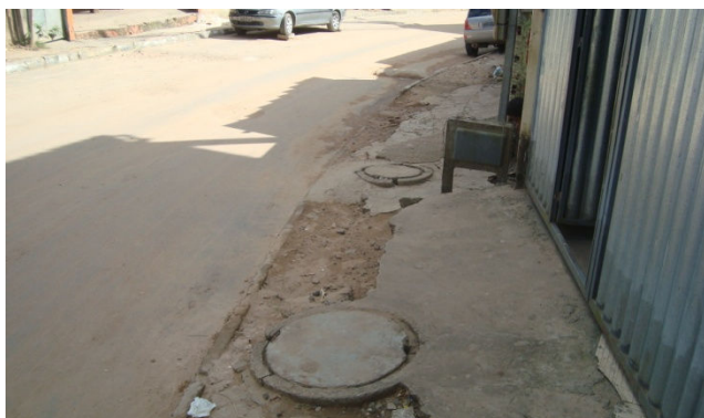
Figura 4.47 - Caixa de Passagem, Jardim Campo Verde
