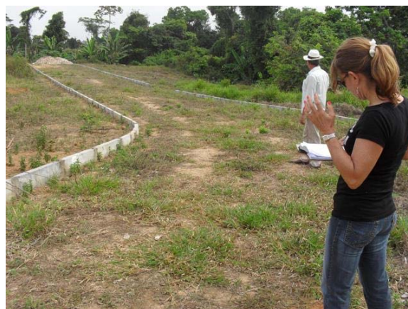
Foto 20: Loteamento Eco água Grande – ruas projetadas a beira do barranco – erosão na encosta – rede com tudo de concreto DN 400 mm e na saída grande abismo.
