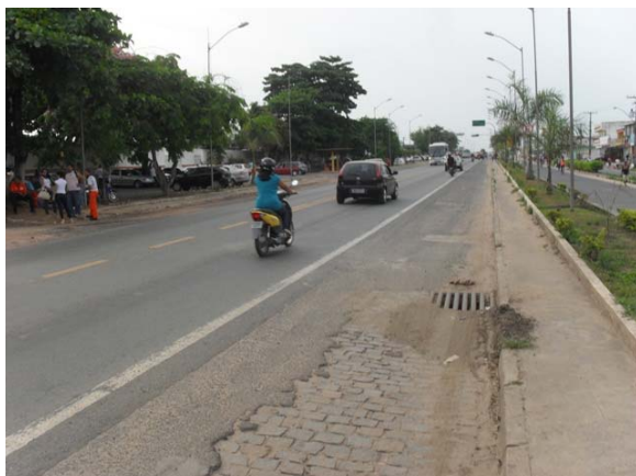
Foto 17: Rua José Visco em frente da empresa de Petróleo San Antonio – mostra erosão e não dá vista do ponto de saída.
