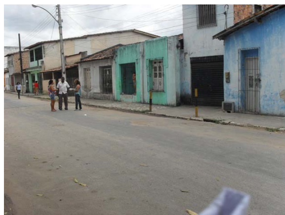
Foto 26: Área Crítica 1 – Rua Agripio Ramos – área de enxurrada – mostra as poucas caixas de drenagem e os batentes das portas para conter as águas.
