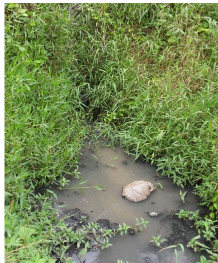
Foto 2: Ponto de lançamento de drenagem e esgoto – galeria atravessa as 2 pistas e a ferrovia em tudo de concreto DN 1000 mm – lança no Rio Catu – forte mau cheiro.
