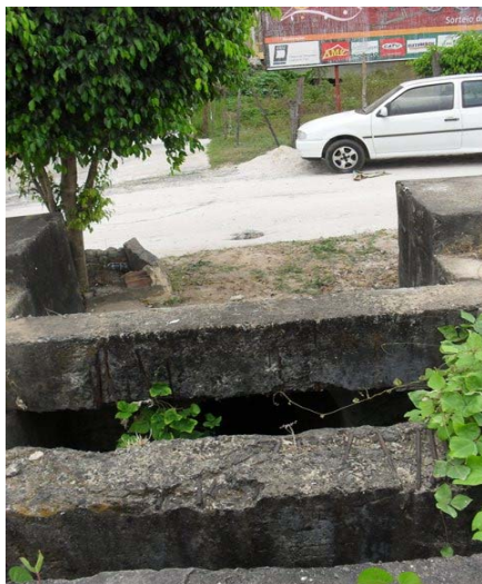
Foto 1: Ponto de lançamento de drenagem e esgoto – galeria atravessa as 2 pistas e a ferrovia em tudo de concreto DN 1000 mm – lança no Rio Catu – forte mau cheiro.
