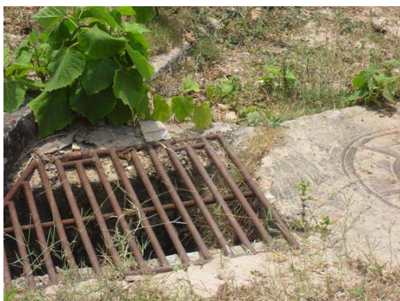
Foto 25: Caixa de drenagem – última da Rua Presidente Getúlio Vargas – saída em tubo de concreto DN 400 mm – observa-se erosão.
