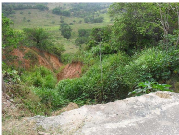
Foto 19: Bairro Planalto II – ponto de drenagem do bairro causou forte erosão – buraco de grandes dimensões (30 m profundidade, 50 m largura e 70 m comprimento).
