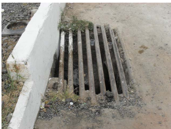
Foto 3: Ponto de lançamento de drenagem e esgoto – caixa com chegada de 2 tubos de concreto DN 300 mm e 1 DN 400 mm – galeria atravessa a ferrovia e vai até o Rio Catu.
