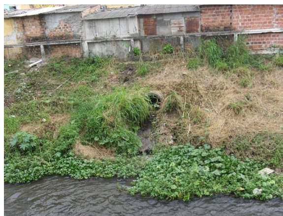
Foto 4: Ponto de lançamento de drenagem e esgoto – caixa com chegada de 2 tubos de concreto DN 300 mm e 1 DN 400 mm – galeria atravessa a ferrovia e vai até o Rio Catu – mostra o assoreamento do Rio e a saída com tubo de concreto DN 600 mm.
