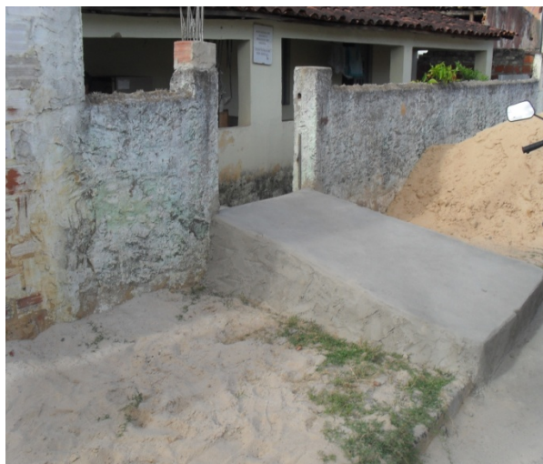
Foto 20: Rua Areia Branca. Moradores locais tentam proteger suas residências dos efeitos danosos das chuvas.
