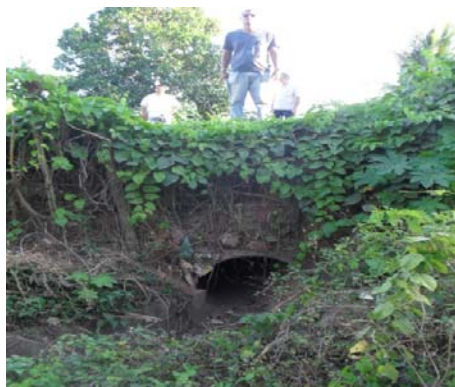
Foto 27: Rua do Avião. Área crítica por conta da ocorrência de alagamento. Área crítica 8.
