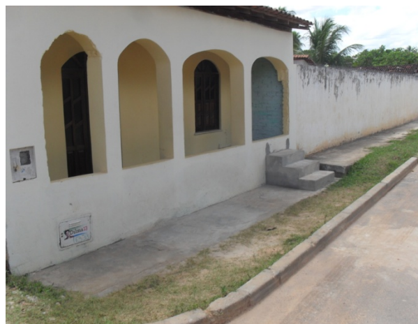
Foto 12: Travessa Djalma de Moraes. Alguns moradores locais elevaram o nível de acesso a suas residências para conter a invasão das águas pluviais.
