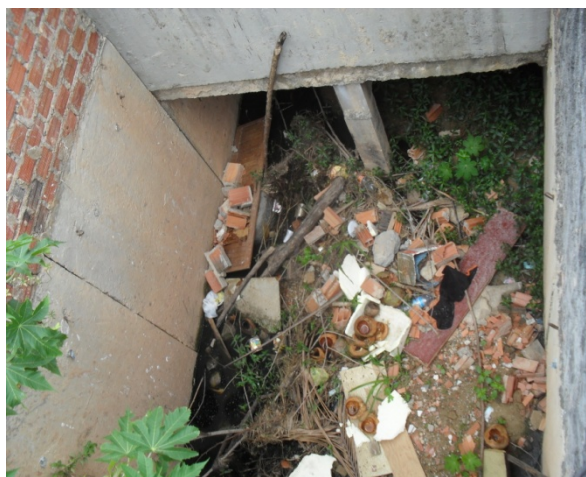
Foto 8: Detalhe do canal de macrodrenagem que se inicia na rua "A". Fim do trecho aberto com profundidade superior a 6m. Presença de muito lixo.
