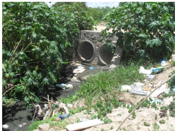
Foto 43: Rua Terminal Rodoviário, próximo ao Parque da Cidade. Detalhe do bueiro duplo de travessia de 1,5m de diâmetro. Riacho transportando esgoto e com presença de lixo no leito.
