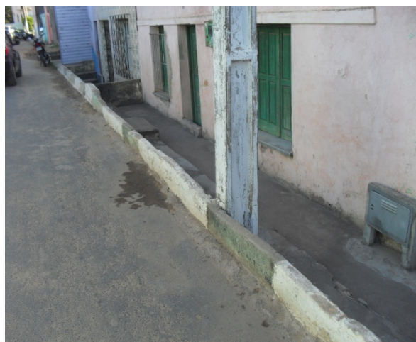
Foto 30: Rua Olga Oliveira Silva. Meio fio foi construído mais elevado para minimizar a invasão das casas construídas abaixo do nível da pista por conta das águas pluviais.
