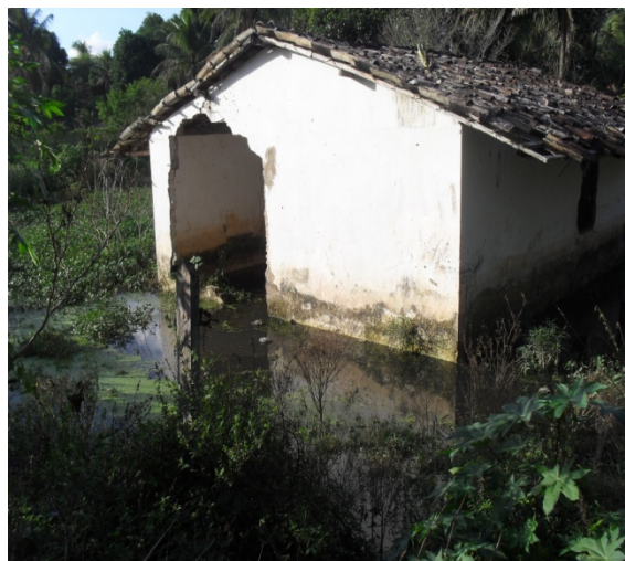
Foto 24: São Crispim. Residência desapropriada e indenizada pela prefeitura por conta dos riscos de desabamento e de invasão constantes das águas do córrego.
