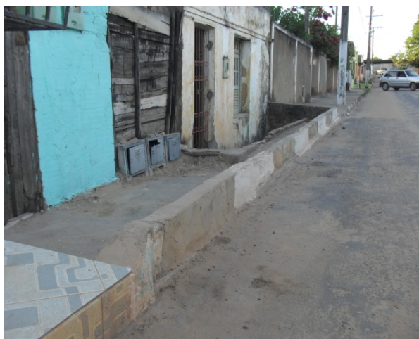
Foto 29: Rua Olga Oliveira Silva. Área crítica por conta da ocorrência de alagamento. Área crítica 9.
