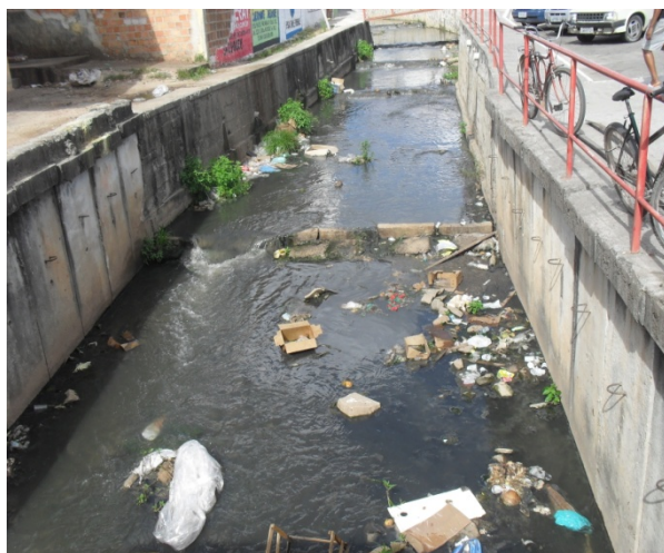
Foto 18: Detalhe do trecho canalizado do rio Catu. O trecho do canal apresenta uma configuração similar a uma escadaria de dissipação de energia. Presença de lixo acumulado no leito do canal.
