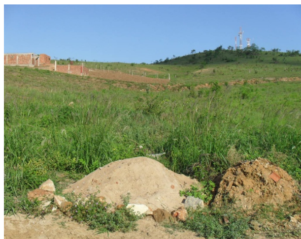
Foto 28: Bairro Quintas do Sul, Asa Sul. Loteamento ainda não regularizado já está com obras iniciadas. Definição do arruamento não favorece o escoamento natural das águas pluviais.
