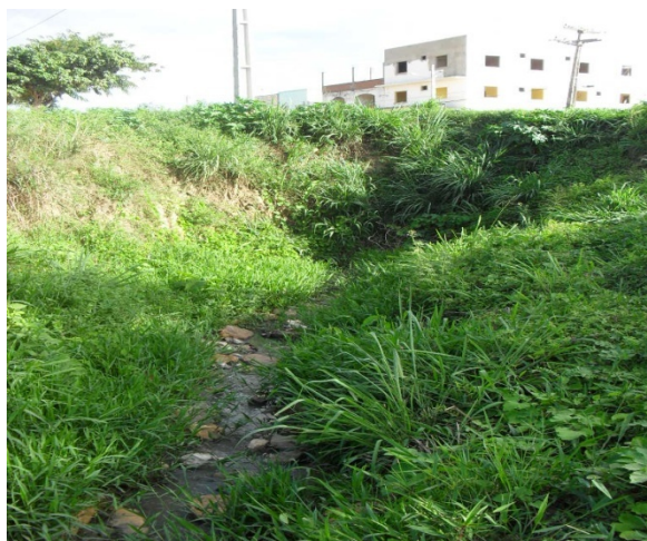
Foto 10: Canal da Clerolândia, trecho no qual o riacho cruza a Avenida Júlio José Rodrigues. Bueiro com seção insuficiente e com indícios de obstrução promove o alagamento na área que afeta moradores locais.
