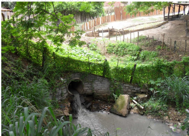
Foto 15: Canal de macrodrenagem dos bairros Otávio Camões e Primavera. Trecho inicial a céu aberto transportando um grande volume de esgoto sanitário.
