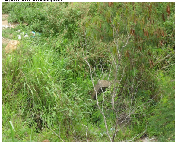
Foto 4: Detalhe do bueiro da BR – 415. O volume de contribuição oriundo da bacia de contribuição do bairro Quintas do Sul para o bairro Américo Nogueira.
