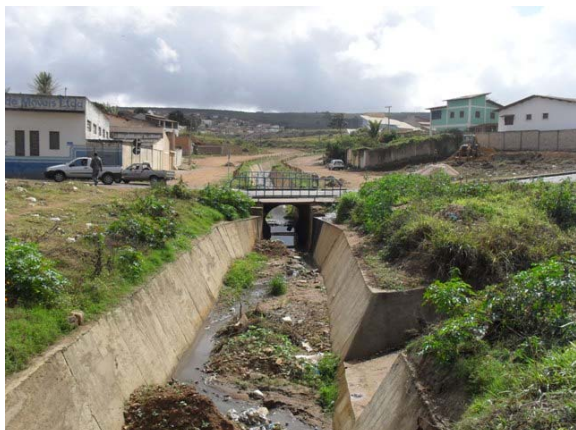
Foto 13: Canal 4 – Trecho em canal aberto revestido em concreto, em condições precárias de manutenção.
