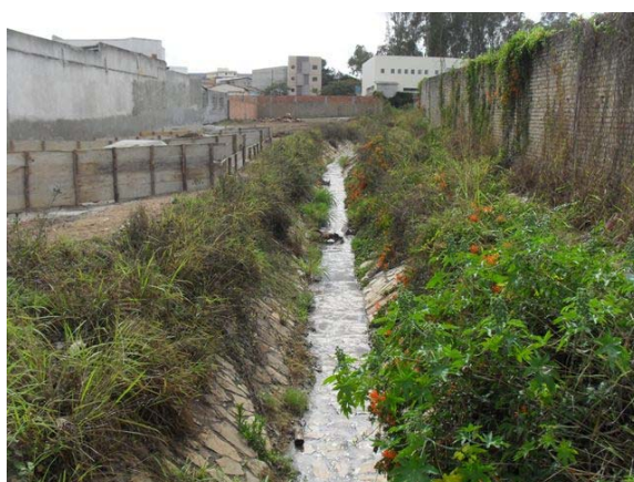
Foto 18: Canal 4 – Trecho em canal aberto revestido em alvenaria de pedra apresentando má conservação.
