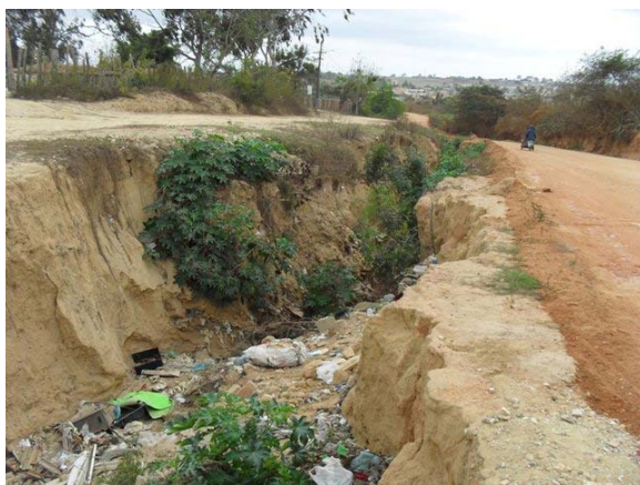
Foto 45: Área Crítica 3– Erosão – Estrada de acesso do Bairro Campinhos – Carência de pavimentação e de sistema de drenagem e presença de lixo.
