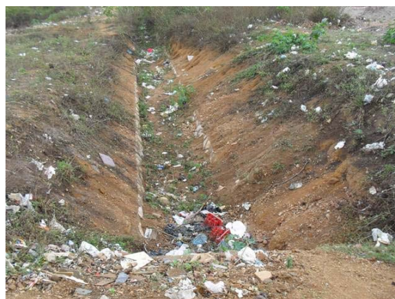
Foto 10: Canal 4 - Início do canal aberto revestido em alvenaria de pedra que contorna a serra, repleto de terra, lixo e vegetação.
