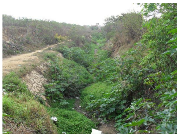
Foto 30: Canal 7 – Trecho aberto revestido em alvenaria de pedra apresentando péssima conservação com deságüe na Lagoa da Bateia.
