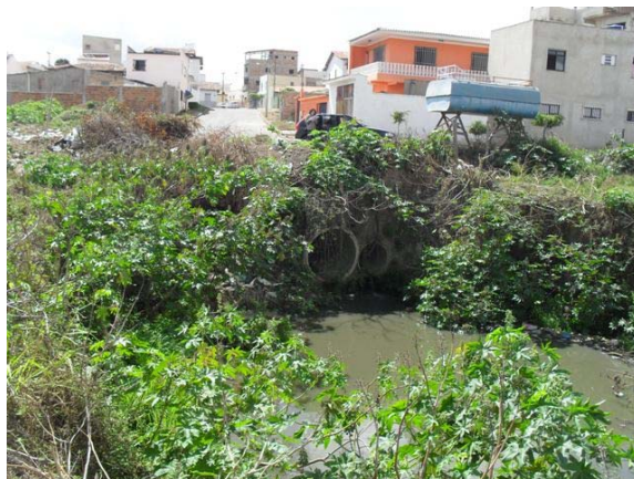
Foto 20: Canal 4 – Trecho sem revestimento repleto de vegetação com deságüe no Córrego Verruga.
