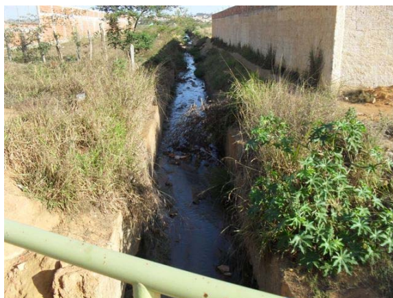
Foto 40: Canal 16 - Trecho do canal aberto revestido em concreto em condições precárias de conservação.
