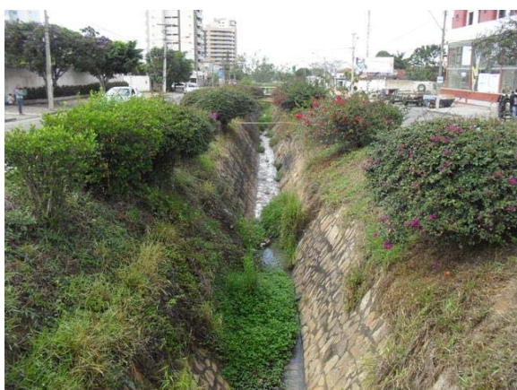
Foto 23: Canal 5 - Continuação do canal aberto revestido em alvenaria de pedra na Rua Luis Eduardo, presença inadequada de vegetação.
