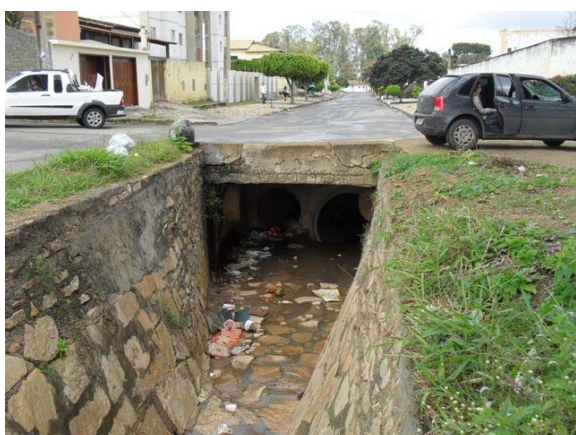
Foto 17: Canal 4 – Trecho em manilhas de diâmetros distintos com presença de lixo.
