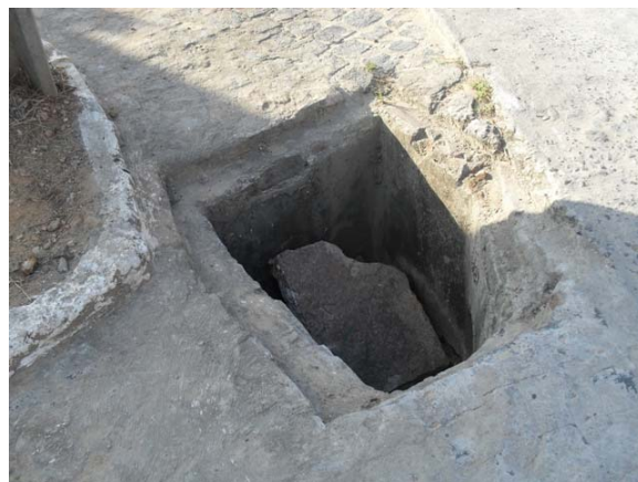
Foto 20: Elemento de microdrenagem – caixa coletora danificada.
