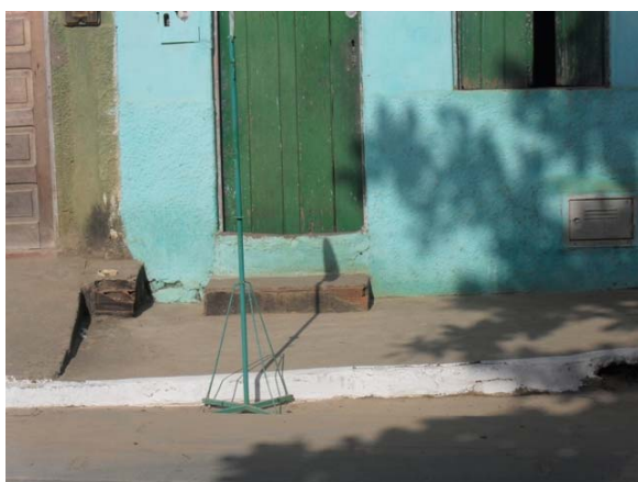
Foto 5: Área Crítica 3 – Av. Getúlio Vargas e adjacências – área de alagamento.
