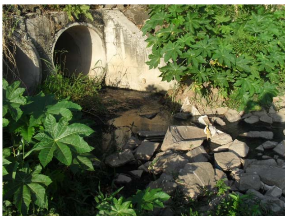
Foto 27: Lançamento de águas pluviais e esgotos no Rio de Contas.
