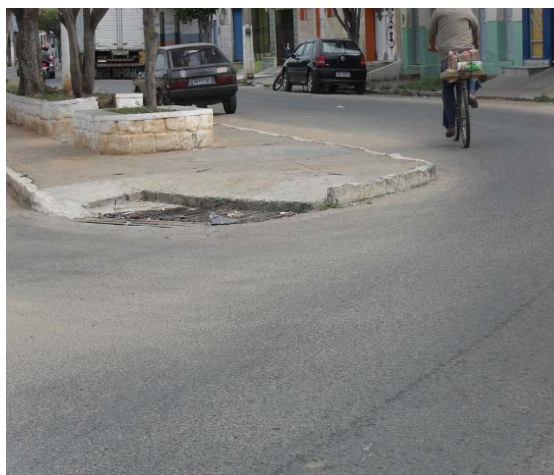
Foto 8: Área Crítica 2, caracterizada por freqüentes alagamentos.
