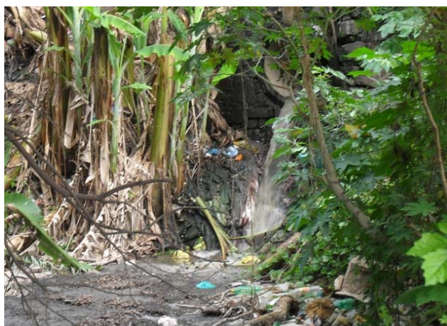
Foto 3: Lançamento de esgoto bruto no Rio de Contas.
